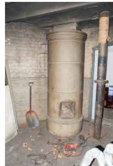
Vesitornin lämmitykseen käytetty pönttöuuni
