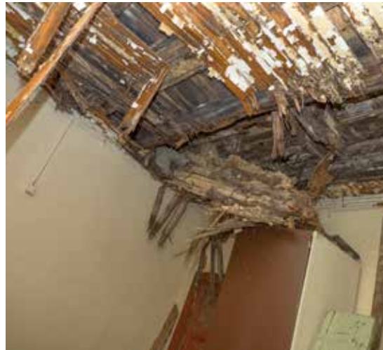
Ullakkohuoneen alla olevissa entisissä saunan tiloissa on välikatto romahtanut.
