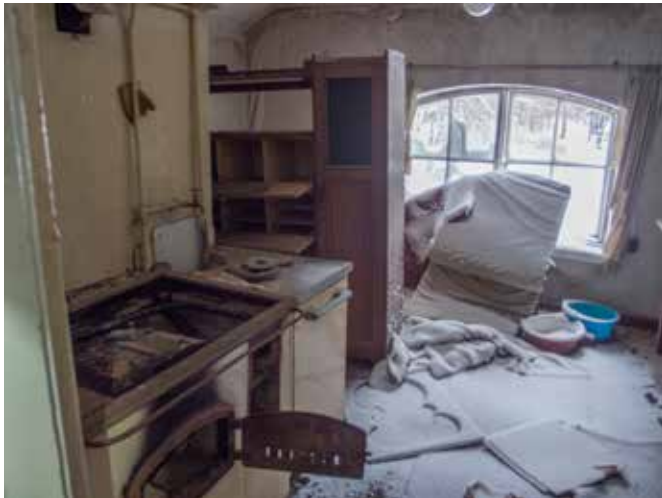
Rakennuksen itäpäädyn ullakkohuone, jossa rikkoutuneet ikkunat ja vesikaton vuodot ovat aiheuttaneet pahoja vaurioita.
