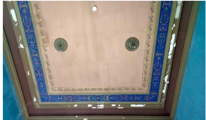
Kuva 7. Listoista poistettu heikosti kiinni oleva aines oven puoleiselta alueelta. Poiston laajuus näkyy vaaleina alueina.
