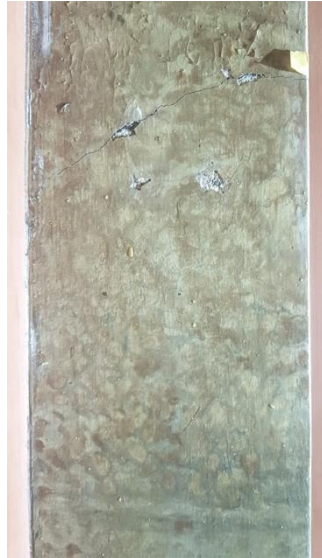
Kuva 15a ja b. Kuvat ennen ja jälkeen kiinnityksen. Irtoamat olivat suuria, ohuita ja ulospäin kaareutuvia. Muutamasta kohdasta ohuet maalilastut olivat ehtineet pudota ennen kiinnitystä. Pilasteri 116-4dP.
