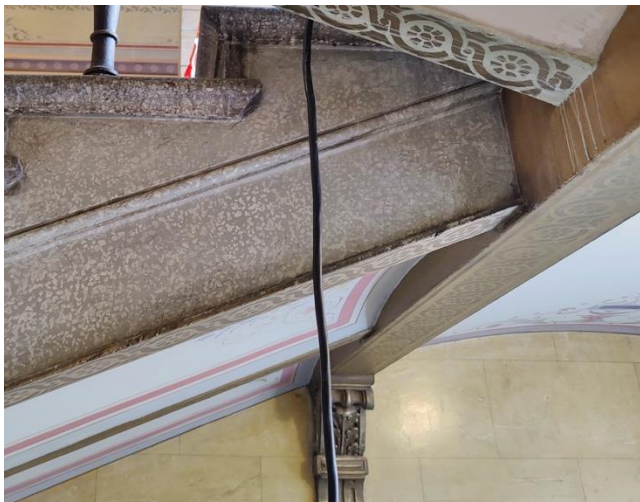
Valumajäljet retusoitu portaan kyljestä. Valumat ovat sotkeneet myös seinäpintaa.
