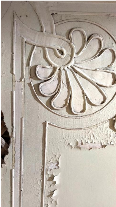
Kuva 2a. Kapeissa kipsilistoissa näkyy puutteita sekä irtoavaa maalia koristeiden reunoilla, johon keskikaton pintavahvistuskangas ei ylety.
