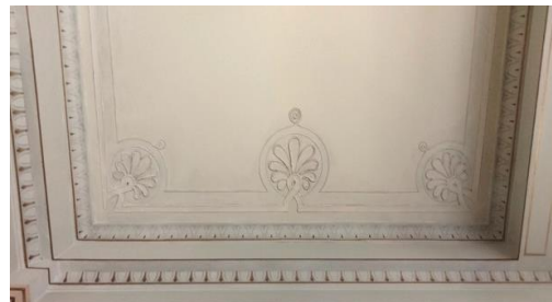
Kuva 1c. Vauriokohdat retusoituina. Pohjamaalaus Uulan Sisäpohjamaalilla ja pintamaalaus Uulan Sisustusmaalilla.
