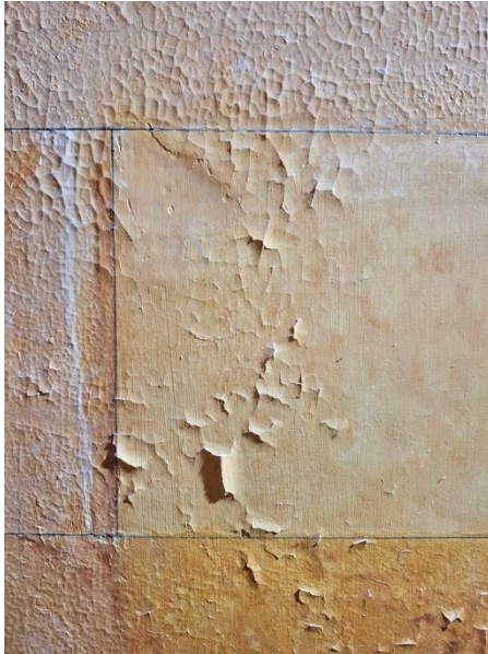
Kuva 2a. Seinän irtoavaa maalia. Vaalean kellertävä alue on 1990-luvun peruskorjauksen aikaista pintaa. Irtoamaa ei ole aikaisemmin ollut tällä pinnalla. Seinä 12.
