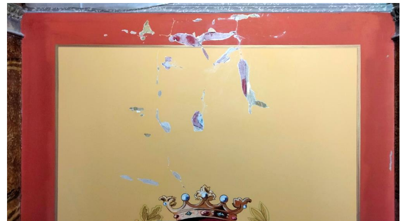
Irtoavat kerrokset poistettu. Vauriokohdissa näkyy vanhempaa vaakunamaalausta.
