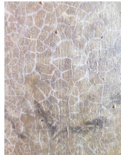
Kuva 21. Kuroutunutta pintaa. Pilasteri 116-7iE.
