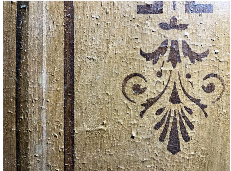
Kuva 9a. Maali-irtoamaa oli paikoitellen runsaasti.
