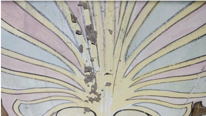
Kuva 8a. Kuvassa friisin irtoavaa maalia, jotka kiinnitettiin MFK-liimalla.
