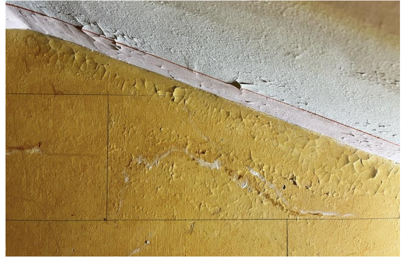
Kuva 9a. Seinä ja syöksyn katon rajassa paljon isoa irtoamaa. Katon irtoamat olivat paikkamaalauskohtassa. Seinä 16.
