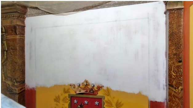
Vaurioalue kangastettu ja kertaalleen tasoitettu.
