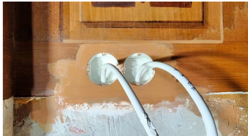
Kuva 16b. Vaurioalue pohjamaalattu.
