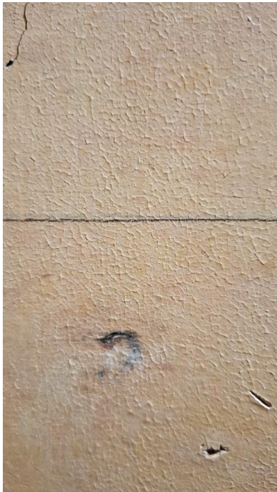
Kuva 1a. Irtoavaa maalia seinäpinnalla ennen toimenpiteitä. Seinä 5.
