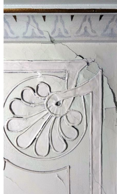
Kuva 3a. Katon etelä-itäkulmassa oli laasti pullahtanut hieman ulos. Vauriokohtaa vahvistettiin injektoimalla alueelle kipsilaastia.
