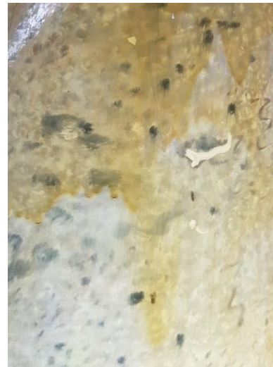
Kuva 3. Myöhemmin lisätyn, paksun ja kellastuneen lakkakerroksen valumia. Pylväs 116-6hE.
