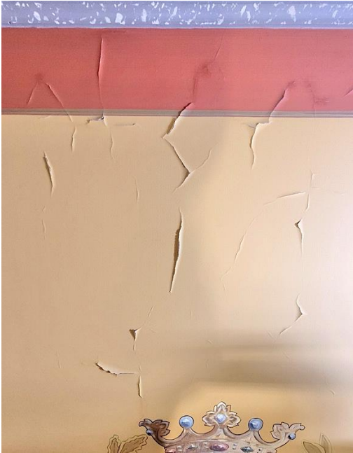
Kuva 9a. Seinäkentän yläosassa oli melko paljon irtoavaa maalia.
