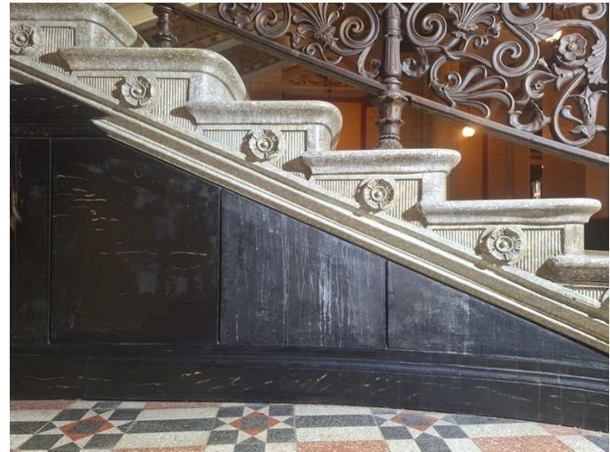
Pääportaan sivun mustan marmoroinnin päälle oli ilmeisesti lattian vahan poiston yhteydessä valunut pesuvettä.
