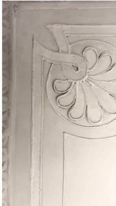
Kuva 2b. Viereisen kuvan vauriot korjattuina.
