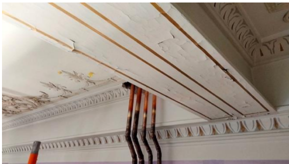
Kuva 2. Palkin alapinnan irtoavia kitti- ja maalikerroksia.
