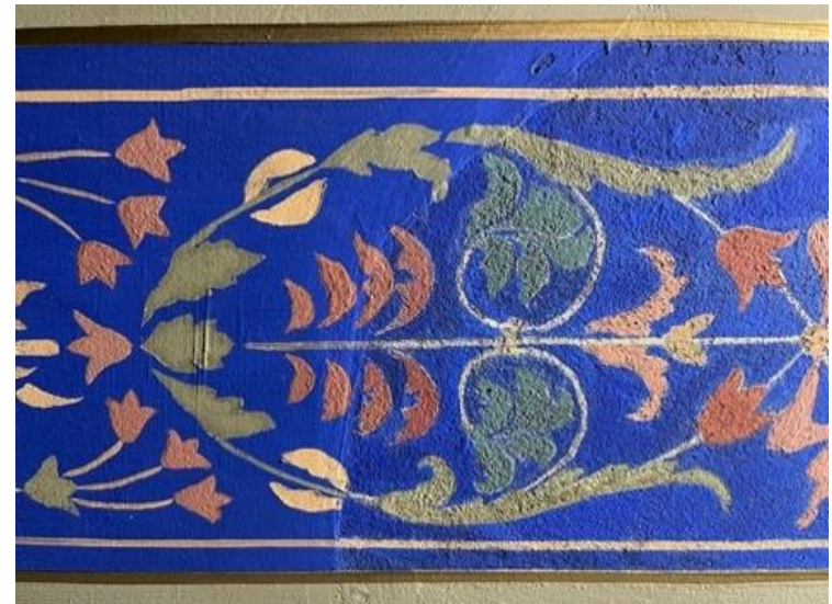
Kuva 2. Edellisen peruskorjauksen aikaisen rekonstruktiomaalauksen ja vanhan esiinotetun koristekuvion rajakohta.
