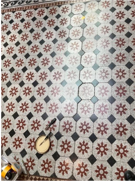
Kuvan keskivaiheilla isohkoja vaurioita saumoissa.
