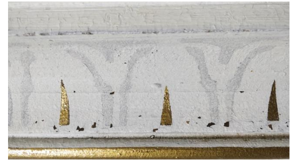
Kuva 6a. Kapeassa ornamentissa oli irtoavaa maalia ja puutosalueita.
