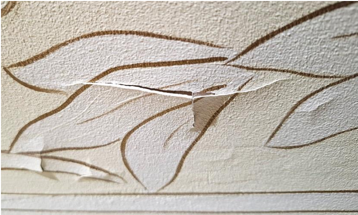
Kuva 2a. Katon koristemaalausalueen maali-irtoamat olivat paikoitellen paksuja ja niissä oli maalikerrosten lisäksi myös tasoitetta mukana.
