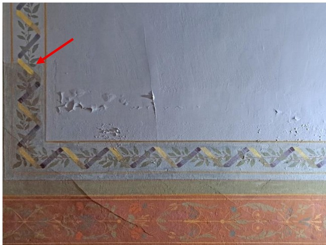
Kuva 2a. Kuvassa katon koristemaalaus on peruskorjauksen aikainen esiinotto, joka on muuta pintaa hiukan syvemmällä. Vanhan ja uuden pinnan raja on merkitty kuvaan nuolella. Esiinottoalueella sekä peruskorjauksen aikana metyylliselluloosalla maalatulla keskikaton liimamaalipinnalla on maali-irtoamaa.
