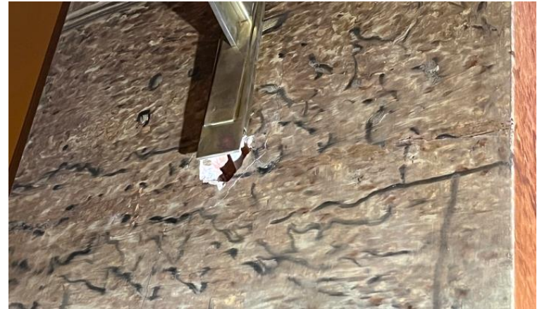
Kuva 24a. Valaisimen peitinlevy ei peitä sähköjohtojen tuloreikää. Pilasteri 116-5d.
