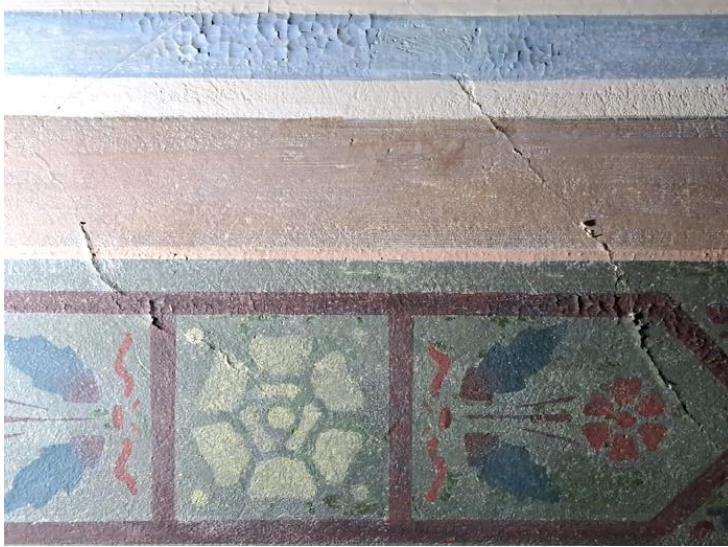
Kuva 2a. Kuvassa erotettavissa sinisen viivan alueella maali-irtoamaa ja koristekuvion alueella ohuita halkeamia.
