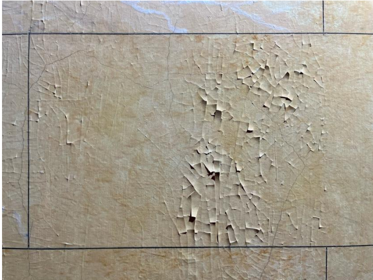
Kuva 5a. Alueella vähän ehjää pintaa, sekä isoa ja pientä irtoamaa. Seinä 16.
