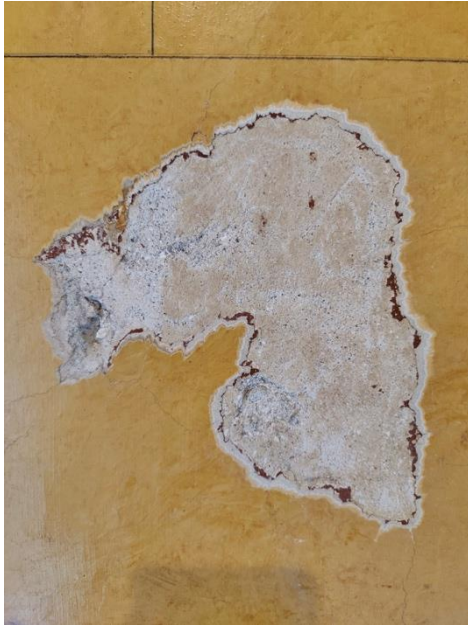
Paikoitellen rappauslaasti oli huonossa kunnossa ja maalikerrokset irtosivat pohjia myöten.
