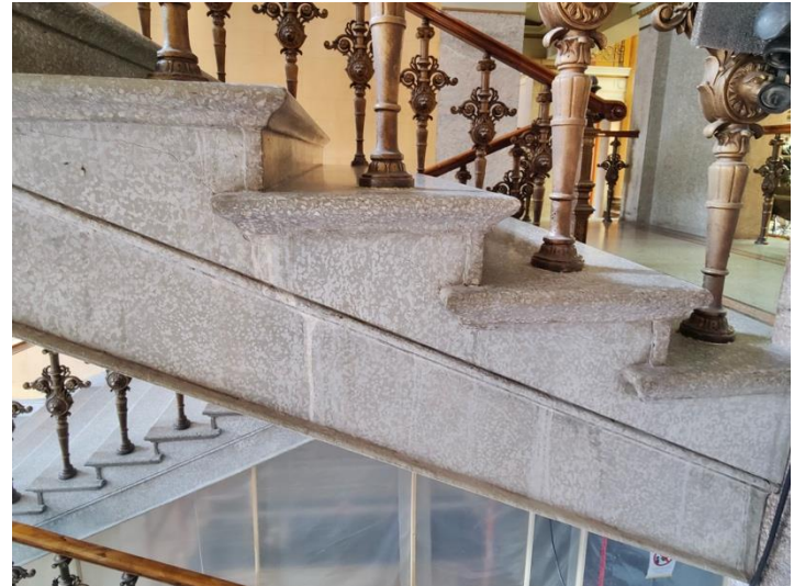
Valumajälkiä portaan kyljessä. Vahanpoistoaine on poistanut myös paikoitellen maalikerroksia.
