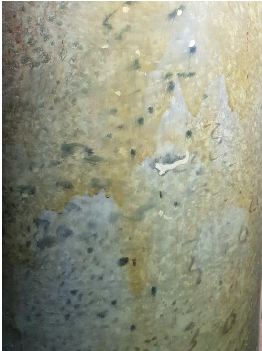
Kuva 7a. Pylvään varressa oli huomattavia sellakkavalumia ja alueita, joissa sellakkaa oli hyvin ohuesti. Pylväs 6hE.
