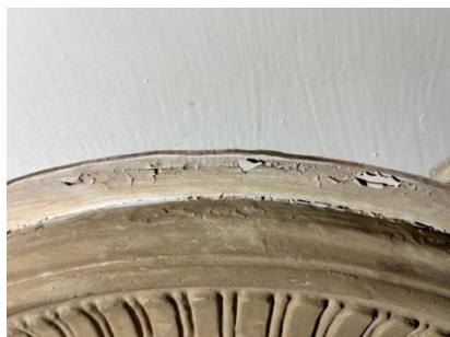
Kuva 4a. Rosetin reunassa on maali-irtoamaa.
