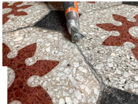
Vaurioituneet saumat avattiin pienen maalikaapimen kulmalla.
