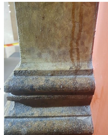
Kuva 22. Jalustassa ja pilasterin alaosassa oli koholla olevaa maalipisaroiden roiskeita, sekä tummana erottuva sellakkavaluma. Pilasteri 116-4eE.
