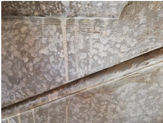
Lähikuva portaan kyljen valumista. Valumat olivat paikoitellen paksuja ja niitä poistettiin sekä mekaanisesti että liuottimilla. Kuvilla ei ole kuvanumerointia, sillä kuvat eivät näy projektiokuvissa.
