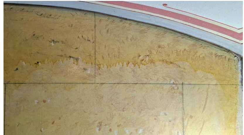
Kuva 13. Lakkavalumia seinän yläreunassa. Seinä 4.
