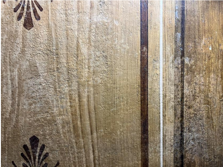
Kuva 13. Vaurioitunutta lakkapintaa. Vauriot saattaneet syntyä kosteudesta.
