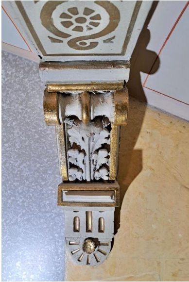
Kuva 14a. Porrashuoneen syöksyjen ja tasanteiden rajassa on koristeelliset, öljymaalilla maalatut konsolit. Konsolien maalipinnat irtoilivat paikoitellen voimakkaasti. Seinä 8.
