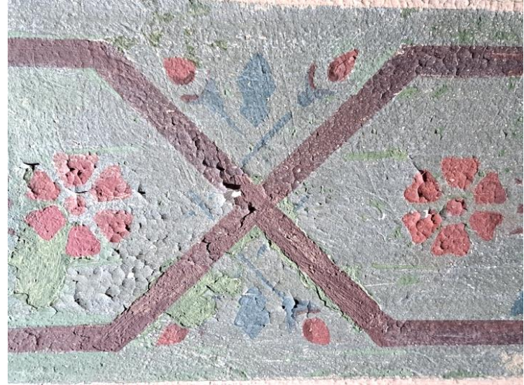
Kuva 3a. Koristealueella irtoavaa maalia ja vanhoja retusointeja. Retusoinnit ovat syvänteissä eli vanha maalikerros puuttuu, eikä puutosaluetta ole tasattu ympäröivän pinnan tasoon.
