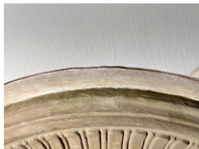
Kuva 4b. Rosetin reunan maali-irtoamat kiinnityksen jälkeen.
