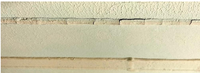
Kuva 3. Kesimerkkikuva kapeiden kipsilistojen vaurioista. Kipsilistat kiinnitettiin HV 498-liimalla.
