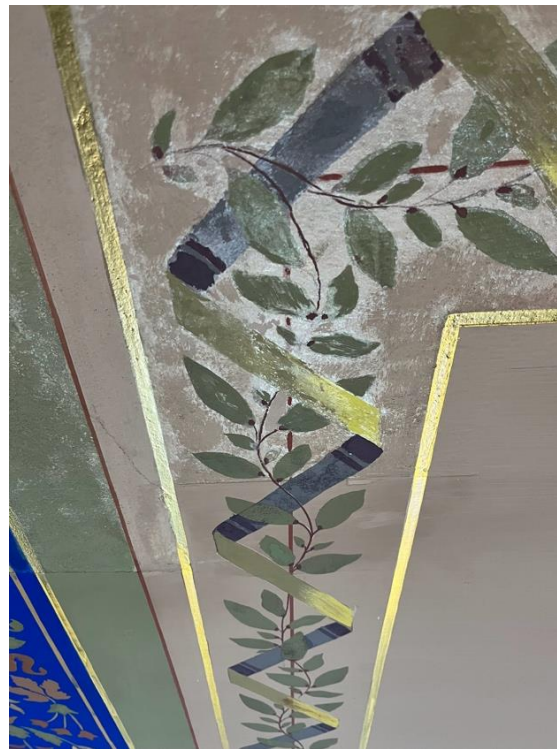
Kuva 5. Edellisen peruskorjauksen aikaisen ja vanhan koristemaalauksen rajakohta.
