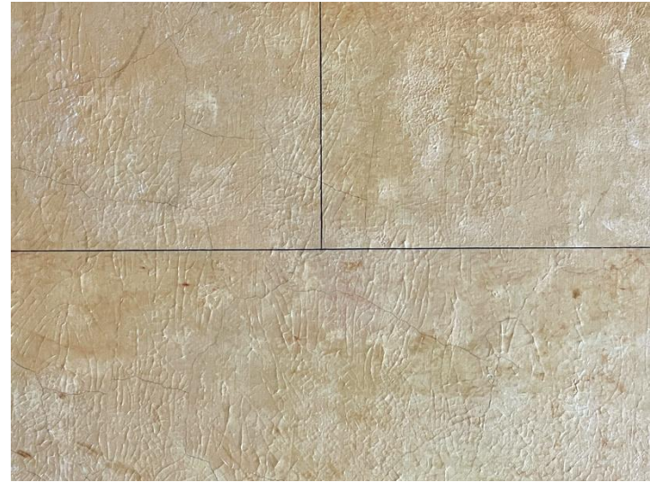
Kuva 11a. Kuvassa näkyvät vaaleat läikät ovat kiinnitysjälkiä. Maalit ovat kuitenkin irti. Seinä 16.
