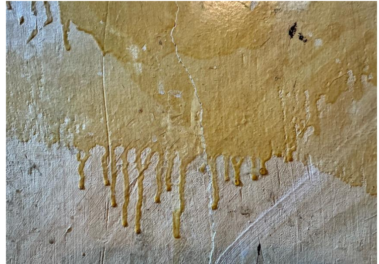
Kuva 12b. Yksityiskohtakuva edellisestä kuvasta. Tällä alueella seinän alareunassa ei ole lakkaa ollenkaan tai kerros on hyvin ohut. Kuvassa näkyy vaalea marmoroitu maalipinta.
