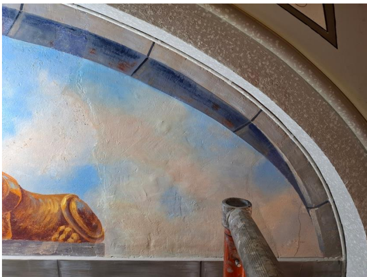
Kuva 6. Taivastaustan oikealla reunalla on oletettavasti 1990-luvun peruskorjauksen aikainen laastipaikkaus. Lunetti 11.
