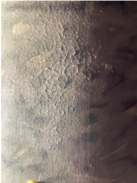
Kuva 12a. Pylvään varren pinnassa kattavaa, melko tasaista maali-irtoamaa. Kuva ennen kiinnitystä. Pylväs 5gP
