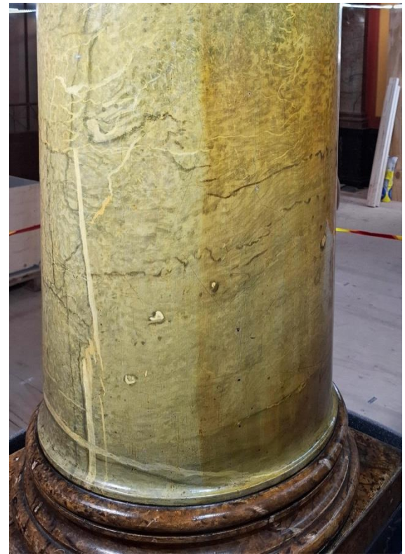
Kuva 6. Sellakan ohentamisen rajakohta. Vaikka pintaan jätettiin vanhaa sellakkaa, ero keltaisuudessa on huomattava. Pylväs 6fE.
