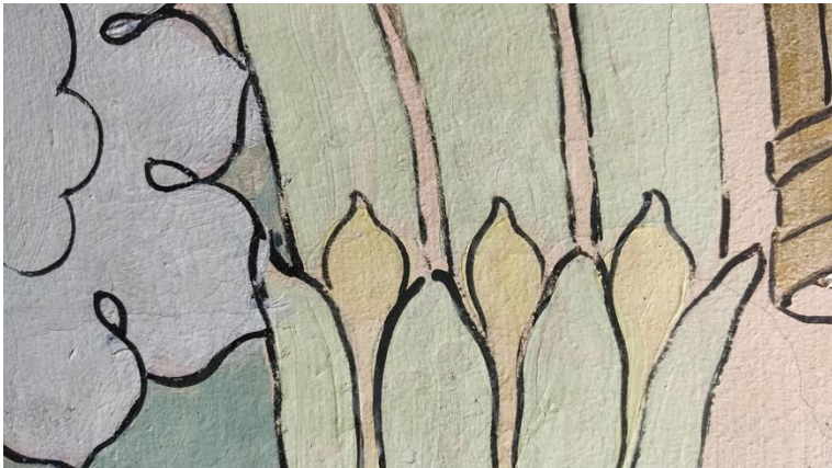
Kuva 7b. Irtoavat maalikerrokset kiinnitetty MFK-liimalla.
