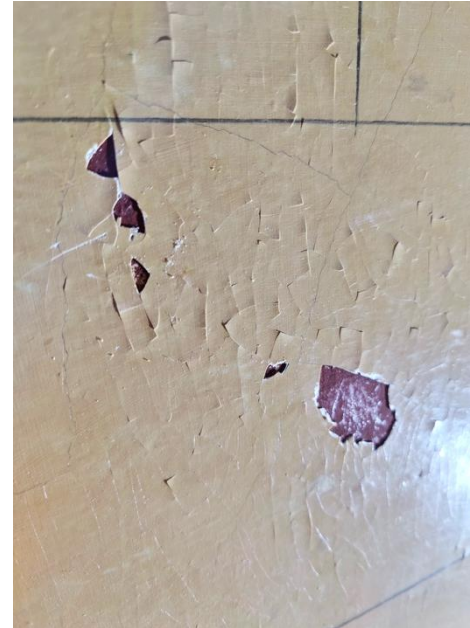
Maalikerrokset olivat irti pohjasta kielekemäisesti. Ennen pohjatöiden aloitusta oli ajatus, että kerrokset irtoavat liimamaalin päältä todella helposti. Näin ei kuitenkaan tapahtunut, vaan maalikerroksista irtosi vain kielekkeiden päät, vaikka maalikerrokset olivat krakeloituneita ja vaikuttivat irtonaisilta.
