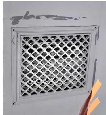
Kuva 6a. Kuvassa osa teipeistä poistettu, osa vielä kiinni seinässä.
