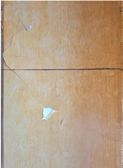
Kuva 4a. Kuvassa paksua irtoamaa, paikoitellen rappaukseen asti. Maalipuutosalueen kohdalla maalipinta irti laajalta alueelta pussimaisesti.
