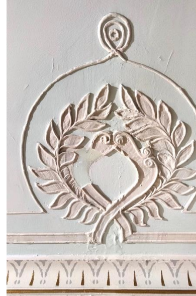
Kuva 4a. Lehväkoristeen puuttuva alue.
