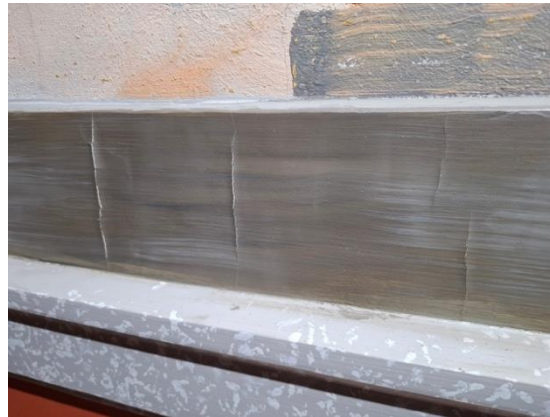
Kuva 4a. 1990-luvun peruskorjauksessa tehdyn alalistan pystyhalkeamia. Maali oli kovaa ja hankala kiinnittää. Lunetti 11.
