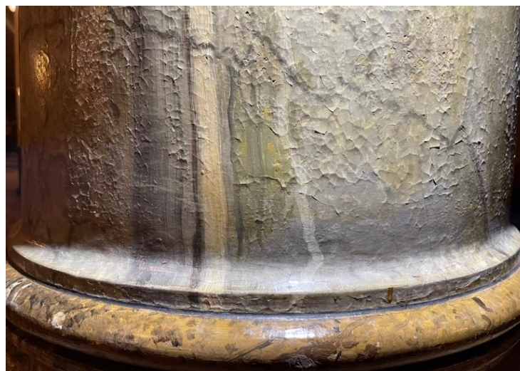
Kuva 2. Pylvään varren irtoavaa maalia sivuvalolla kuvattuna. Pylväs 116-6hL.
