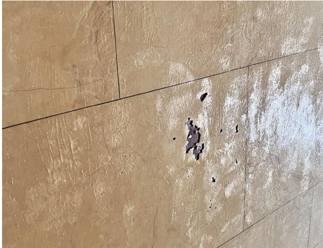
Kuva 10a. Kesällä 2025 seinän maalit kiinnitettiin toisen urakoitsijan toimesta. Pintaan oli jäänyt mattapintaisia kiinnitysjälkiä, jotka näkyivät hyvin sekä sivu- että suorassa valossa. Seinä 16 eli ylimmän syöksyn seinä.
