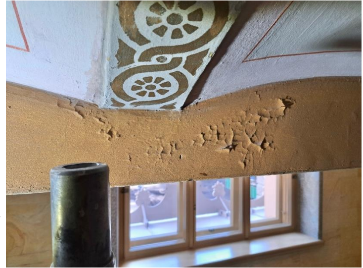
Irtoavaa maalia kattopalkin sivustassa. Kuva ei näy seinäprojektioissa, seinien 7 ja 8 välinen kattopalkki.
