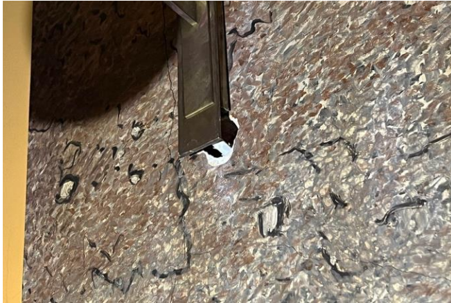
Kuva 23a. Valaisimen peitinlevy ei peitä sähköjohtojen tuloreikää. Pilasteri 116-6i.
