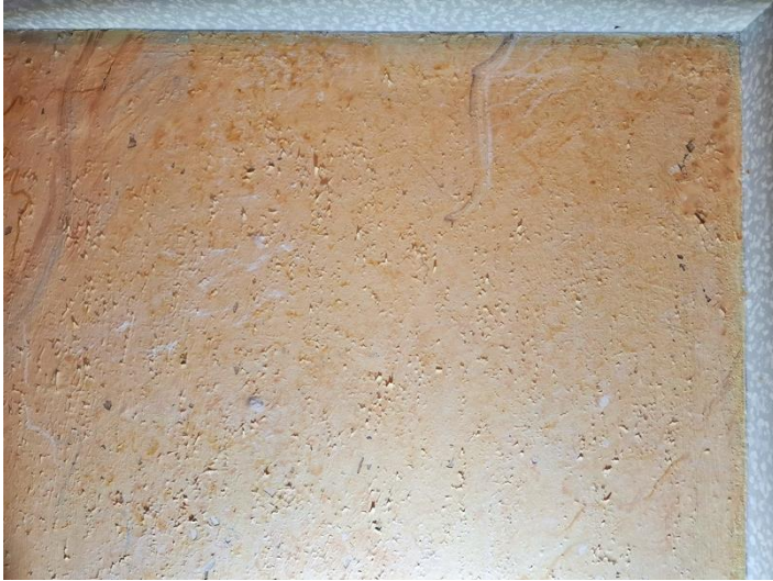
Kuva 3a. Tasanteella olevassa peilikentässä oli runsaasti irtoavaa maalia. Seinäprojektio 9, tasanne.
