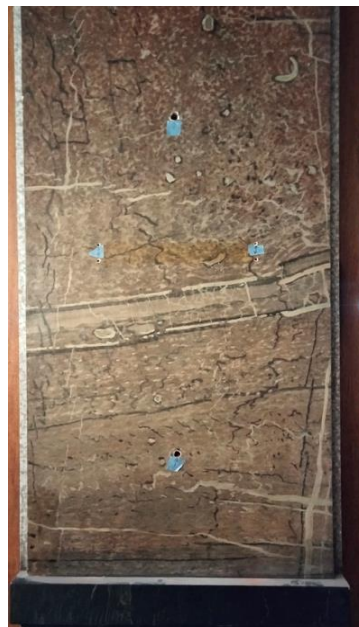
Vanhan portin / lasiseinän poiston yhteydessä marmoroituun pilasteriin jäi reikiä. Reiät ovat kuvassa sinisten teippien kohdalla
