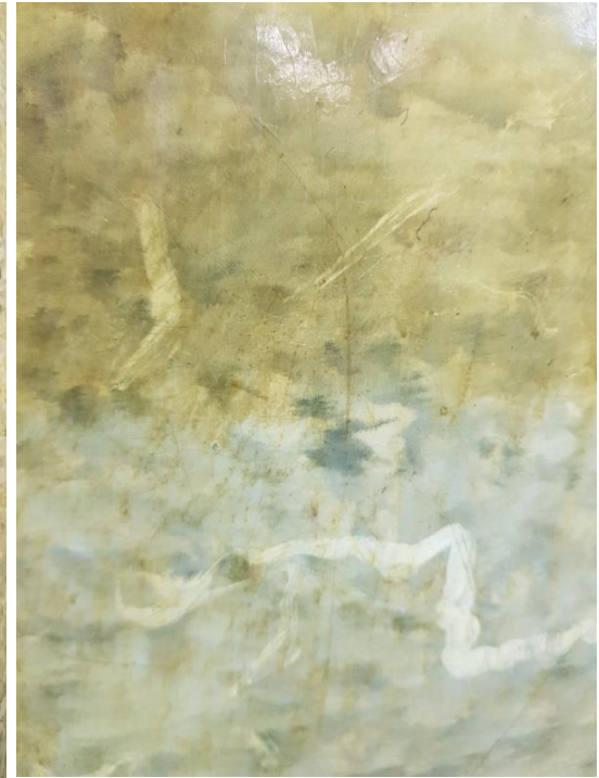
Kuva 8. Lähikuva pylvään pinnasta. Sellakkakerrosten välissä esiintyi tahmea käsittelykerros. Kyseessä on mahdollisesti kiillontasauksena käytetty vernissa tai vastaava. Tahmea kerros poistettiin sellakkakerroksen ohentamisen yhteydessä. Pinnasta oli kuitenkin hankalampi saada tasainen, sillä kerros siirtyi helpommin kuin tarttui puhdistustolloon. Pylväs 6gP.
