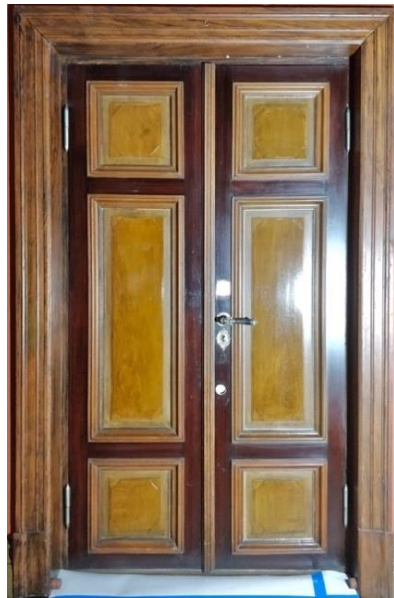
Ovi D116, kuvattu huoneesta päin. Ovien peileissä ei koristemaalausta. Lukitusmuutoksista aiheutunut puupaikka ovenkahvan ylä- ja alapuolella.
