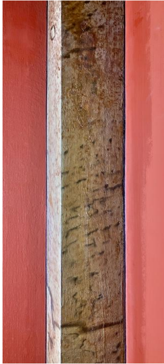
Kuva 16 a ja b. Kuvat ennen ja jälkeen kiinnityksen. Tässä pilasterissa irtoamaa oli paljon. Pilasteri 117-8jl.
