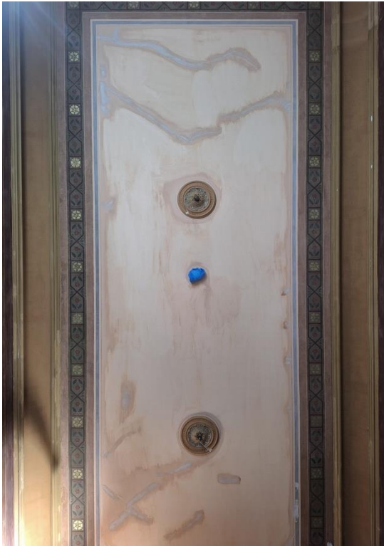
Kuva 4b. Vaalealta keskikaton alueelta on pesty edellisen peruskorjauksen yhteydessä maalattu liimamaali pois ja halkeamat on tasoitettu muun pinnan tasoon.
