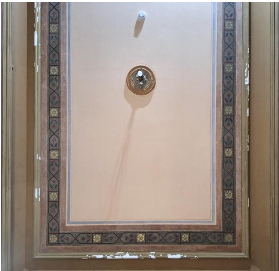
Kuva 8a. Listoista poistettu irtoava aines. Kuva näyttää irtoamien laajuuden ovien puoleiselta katon alueelta.
