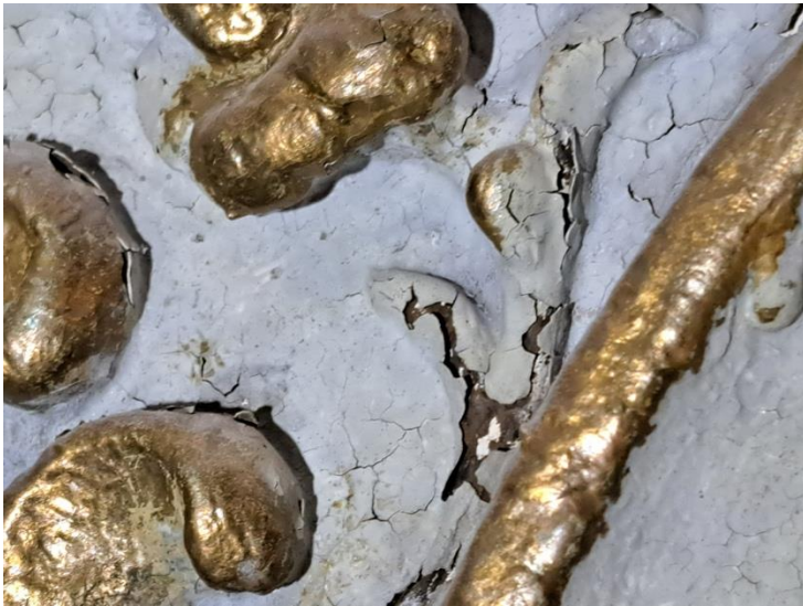
Kuva 14b. Yksityiskohta irtoavasta maalista.
