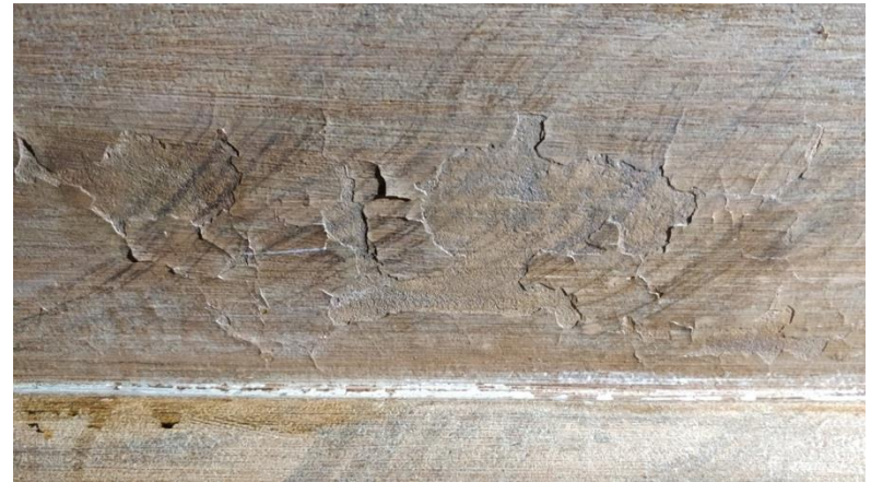
Ovi D204. Maalipinnan päällä on himmeä, kellertävä pintakäsittely, jota on kertynyt runsaasti listojen syvennyksiin. Vanhat retusoinnit tehty suoraan rappauspinnalle ilman tasoitusta.
