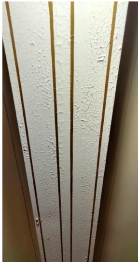
Kuva 5a. Kattopalkkien alapintojen maali- ja kittikerrokset olivat kauttaaltaan irti tai heikosti pohjassaan kiinni.
