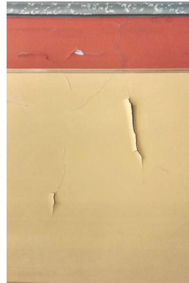
Yksityiskohtakuva irtoavista maali- ja kittikerroksista.
