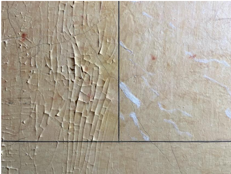
Kuva 8. Kuvassa pitkänomaista, paksua irtoamaa. Kuvan oikea puoli kiinnitetty. Seinä 16.
