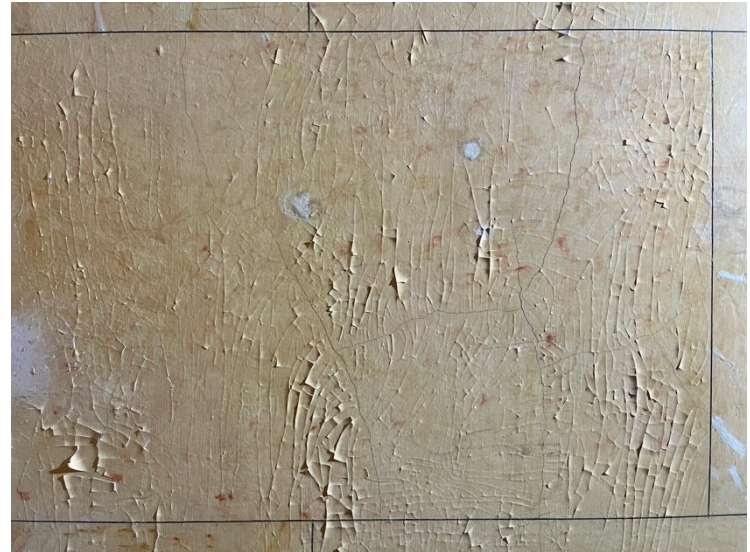
Kuva 6a. Pitkänomaisia irtoamia ja halkeamia. Seinä 16.
