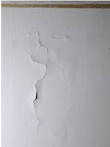
Kuva 4a. Vaaleansinisen keskikaton maali-irtoamat ennen kiinnitystä.
