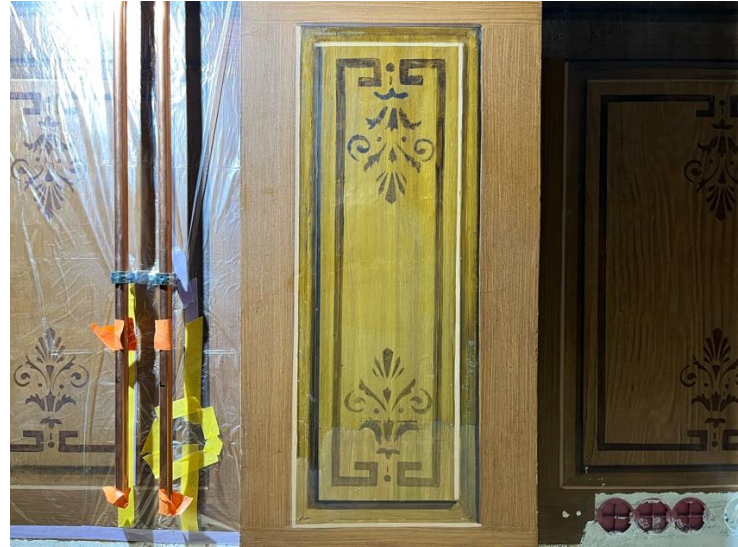
Kuva 15. Peilin maalaus ei ole alkuperäistä. Siinä on myös eri sävyt ja kädenjälki kuin 1990-luvun peruskorjauksen aikaisissa korjauksissa, joten tämän peilin korjauksen tekoaika ei ole tiedossa.
