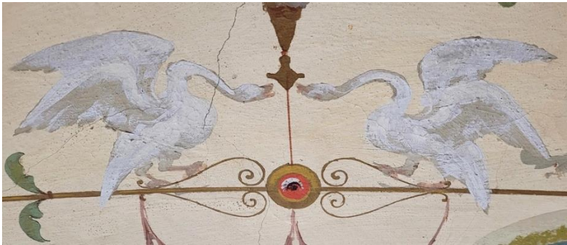
Kuva 25a. Tilan 116 katossa oli kahden joutsenparin kohdalla krakeloitunutta maalia. Kiinnitys tehtiin HV 498-liimalla (5%).
