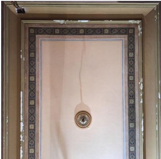
Kuva 7a. Listoista poistettu irtoava aines. Kuva näyttää irtoamien laajuuden ikkunan puoleiselta katon alueelta.
