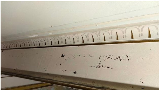
Kuva 5. Palkkien kylkien maali-irtoamaa.
