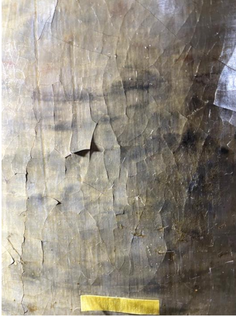
Kuva 10a. Pylväässä oli paikoitellen paksuja, taipumattomia maalikerroksia. Pylväs 5hl.
