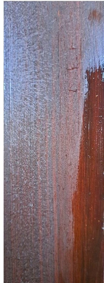
Ovi D225. Kuvan vasemmalla puolella oletettavasti 1990-luvun pintakäsittely reagoi öljylakan kanssa ja aiheuttaa krakelointia ja hylkimistä. Nämä alueet pohjustettiin Helo-lakalla öljylakan kiillontasaamiseksi.
