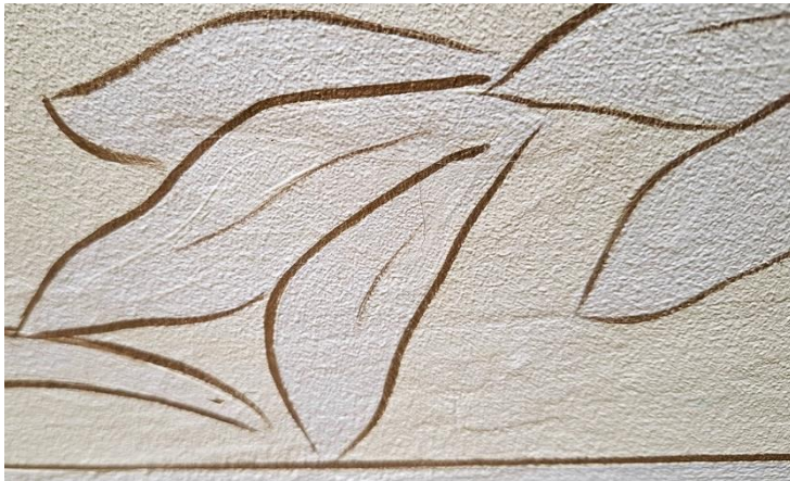
Kuva 2b. Kuvassa näkyy, että kiinnitetty alue on painunut hiukan kuopalle. Tämä johtuu 1990-luvun peruskorjauksen aikaisesta hiekkatasoitteesta, joka on liuennut kiinnityksen aiheuttamasta kosteudesta.
