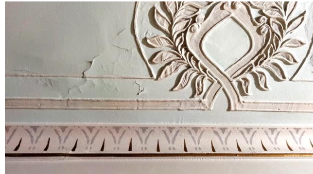
Kuva 1a. Reuna-alueiden irti olevia maali- ja kittikerroksia.
