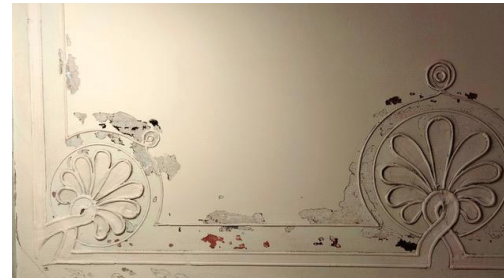
Kuva 1a. Koristeiden reunoilla ja myös niiden keskellä oli irtoavaa maalia. Kuvassa irtoava maaliaines poistettu.
