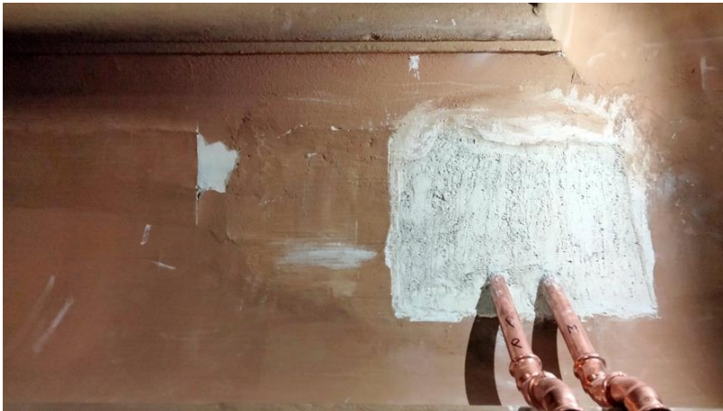
Kuva 5a. Holkkalistan kaarevalla alueella patteriputkien läpivienti kipsitäytöllä. Kuvan vasemmalla reunalla erottuu repeytynyt pintavahvistuskangas.
