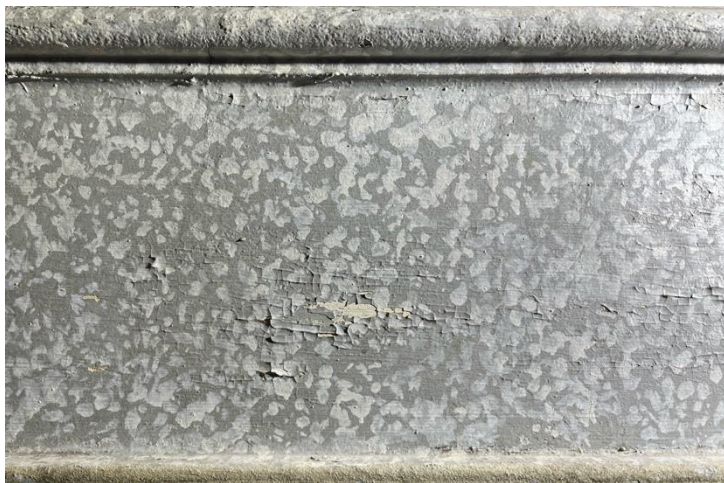
Hilseilevää maalia portaan kyljen alueella.
