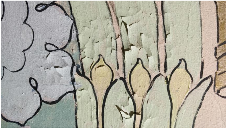
Kuva 7a. Esimerkkikuva friisin irtoavasta maalista. Kuvassa irtoama-alue, vieressä siistää ja ehjää pintaa.
