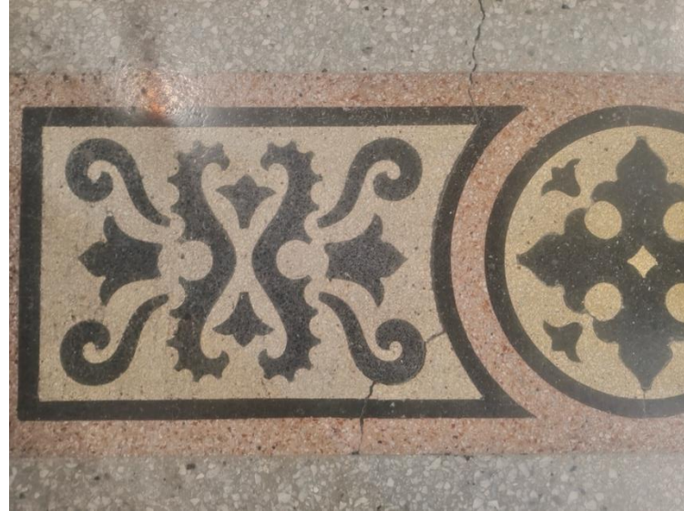
Halkeama ensimmäisen kerroksen lattian koristeosiossa.
