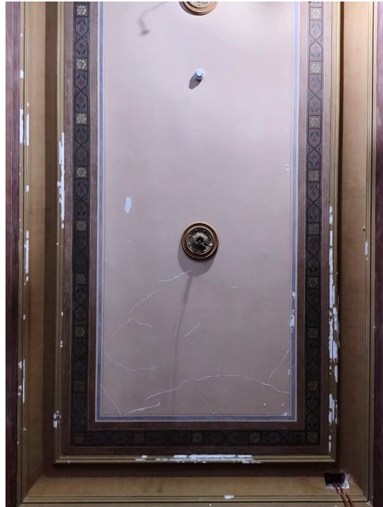
Kuva 4a. Kuvassa listoissa vaaleana esiintyviltä alueilta on irtoava aines poistettu ja kattokenttää risteilevät halkeamat on avattu. Kattokuva on ikkunanpuoleiselta alueelta.
