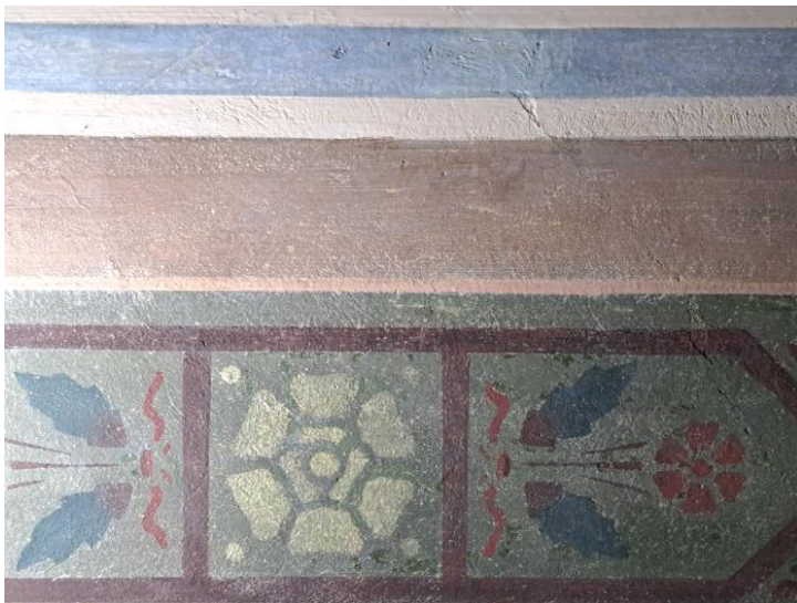
Kuva 2b. Sininen viiva ja koristeiden halkeamat maalinkiinnityksen jälkeen.
