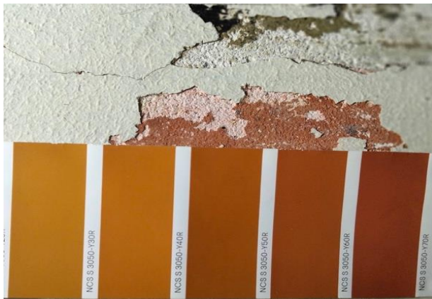
Kuva 10a. Kattopinnoalta esiin tullutta punaista sävyä, jonka lähin sävykoodi on NCS 3050-Y50R.
