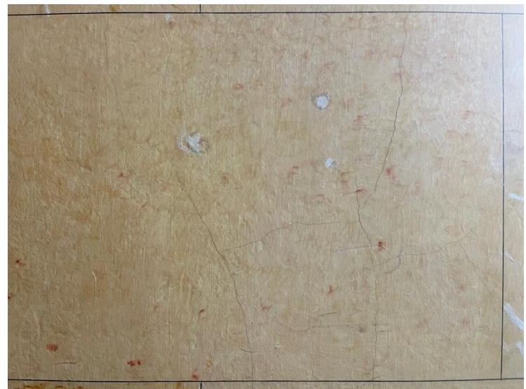
Kuva 6b. Irtoamat kiinnitetty. Osittain kiinni olevien halkeamien kiinnittäminen haasteellista.
