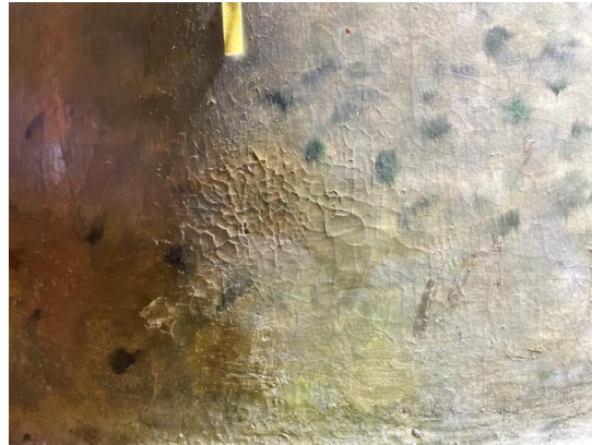
Kuva 9a. Kuvassa irtoavaa maalia vanhan retusoinnin alueella. Pylväs 5eP.
