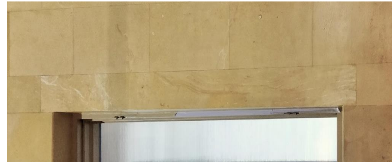
Kuva 6e. Ikkunan yläpuolisen palkin vauriot retusoitu.
