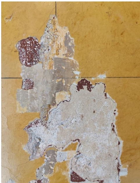
Paikoitellen maalit irtosivat laastia myöten. Alueen reunamilla näkyy vanhempia maalikerroksia. Kellertävä maali on ehkä aikaisempaa, keltaista marmorointia.
