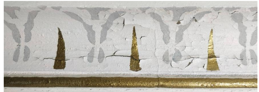
Kuva 6a. Listoissa oli paikoitellen runsaasti irtoavaa maalia.
