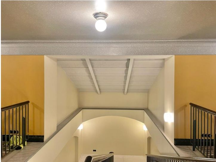
Kuvassa kulkuaukon yläpuolinen palkki sekä katon valaisin, jonka ympärillä oli irtoavaa maalia.
