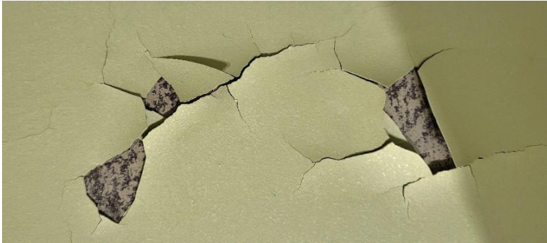
Maalikerrosten irtoamia vanhan liimamaalikerroksen päältä.
