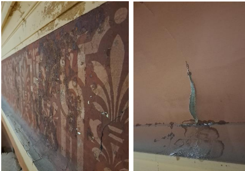
Kuva 30 Vesivaurion aiheuttamat jäljet
