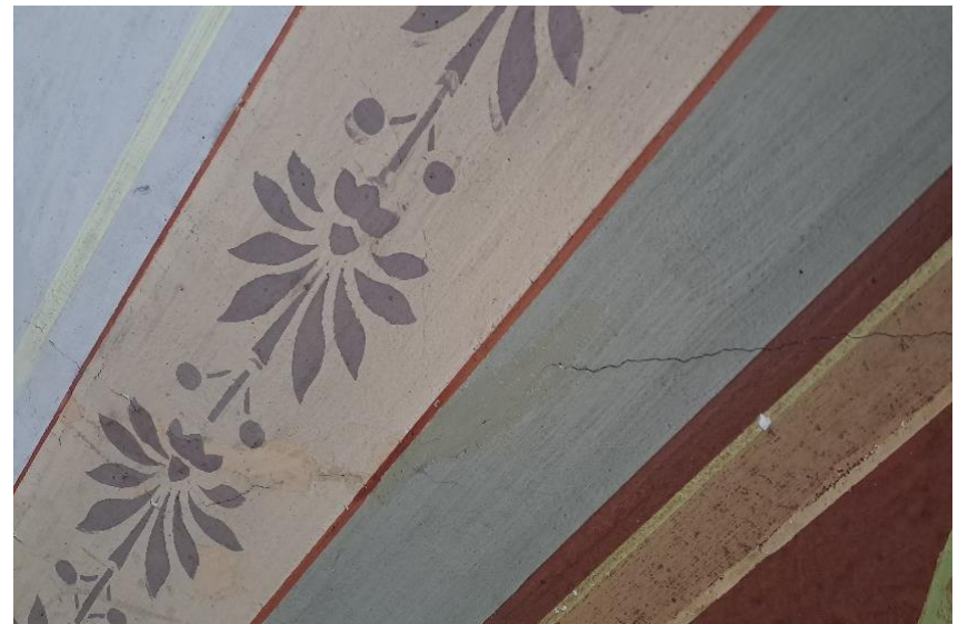
Kuva 13 Retusoitu halkeamakohta reunafriisissä
