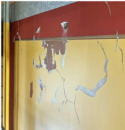
Avattuja halkeamia ja poistettuja irtonaisia maalikerroksia.
