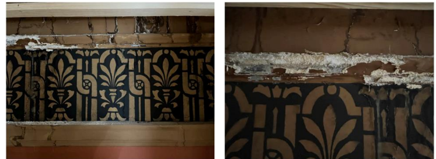
Kuva 52 Seinäpinnan kipsilistoituksissa oli runsaasti kidekertymää, ja friisin pinnassa valumajälkiä.
