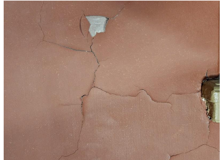
Maalikerrosten irtoamaa ja halkeamia ikkunapenkin kulmassa.
