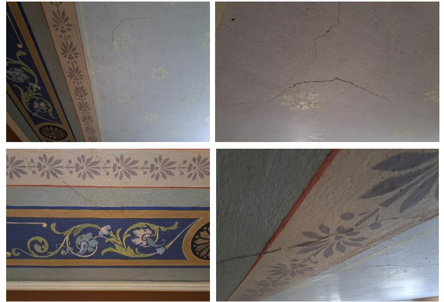
Kuva 31 Yksityiskohtakuvia katon halkeamista
