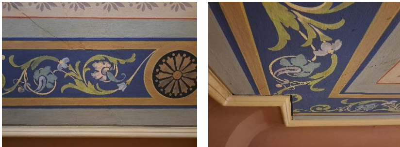
Kuva 25 yksityiskohtakuva reuna-alueen halkeamista.
