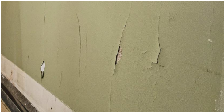
Kaapiston takana esiintyviä irtonaisia maalikerroksia.
