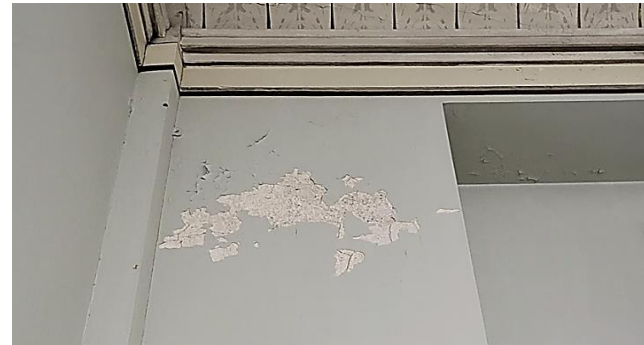
Eteläseinän rappauspinnalle asti kuoriutuvia maalikerroksia.
