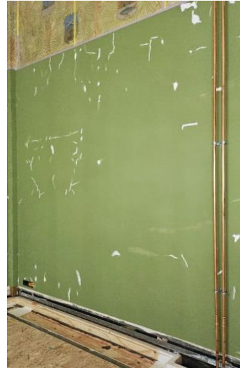
Avattuja halkeamia ja maalikerrosten poistoja.
