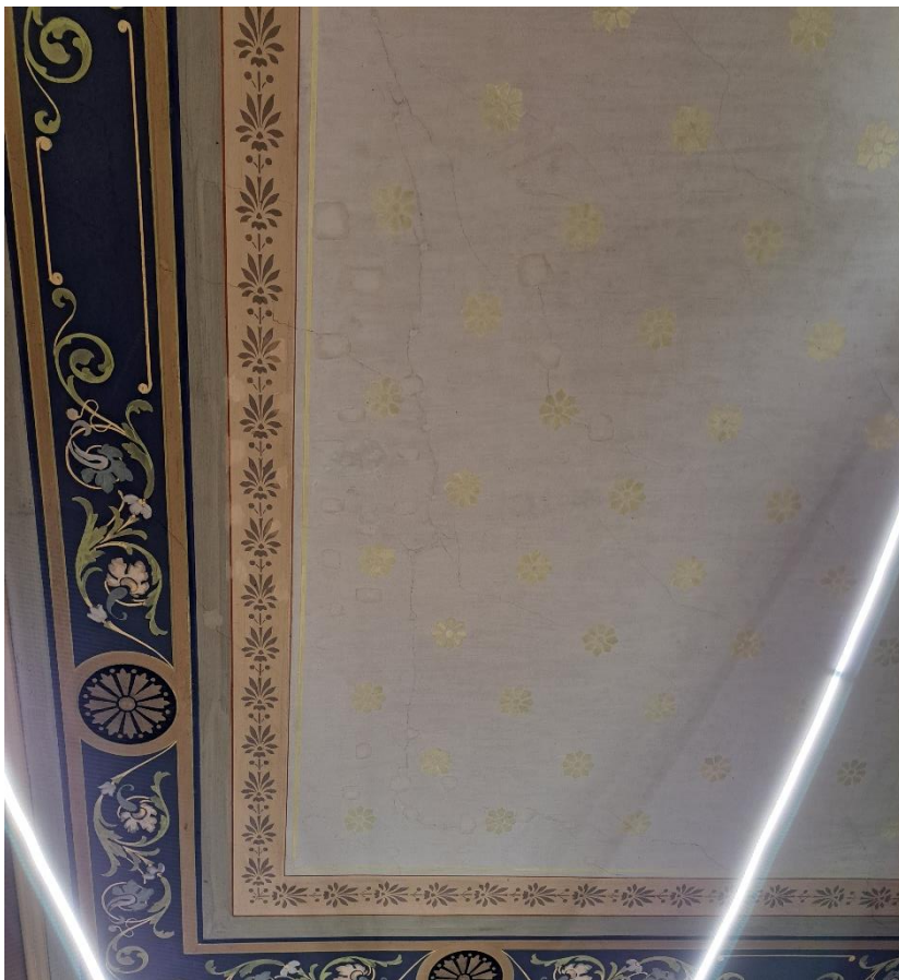
Kuva 26 Vasemman takanurkan lukuisat injektointikohdat
