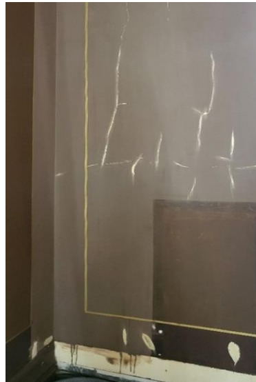
Pohjoisseinän halkeamia ja vanhaa liimamaalia.
