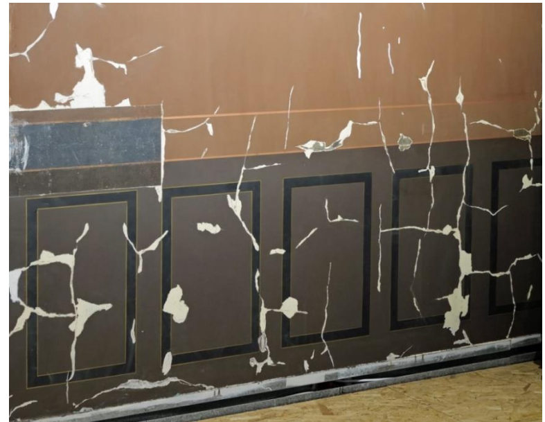
Kokoustilan 222 avattuja halkeamia ja poistettuja irtonaisia maalikerroksia.
