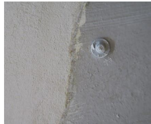
Kuva 39 Rajapinta siloitetun paikkarappauksen ja vanhan pinnan välillä
