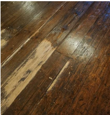
Lattian kulunutta pintaa.
