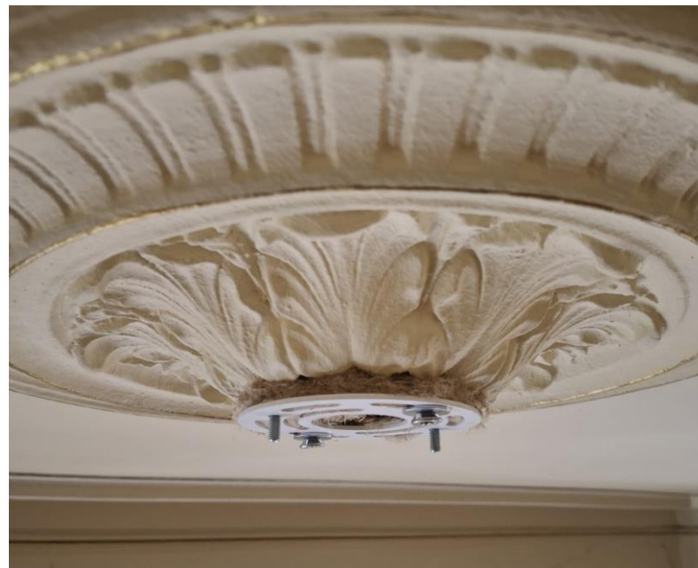
Kuva 55 Pellavaeristenauhasta leikattu tiiviste aluslevyn ja rosetin välissä.
