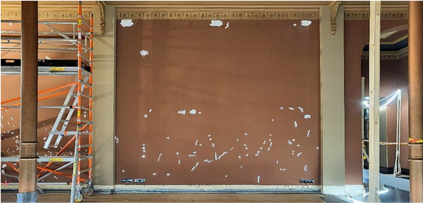
Tiedotustilan 103 Itäseinän pohjustettuja halkeamia ja paikkakohtia.
