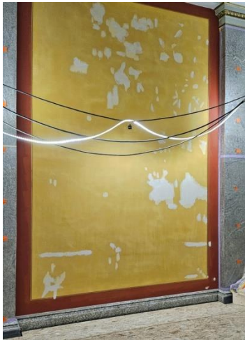
Porrashallin paikattuja maali-irtoamia ja halkeamia
