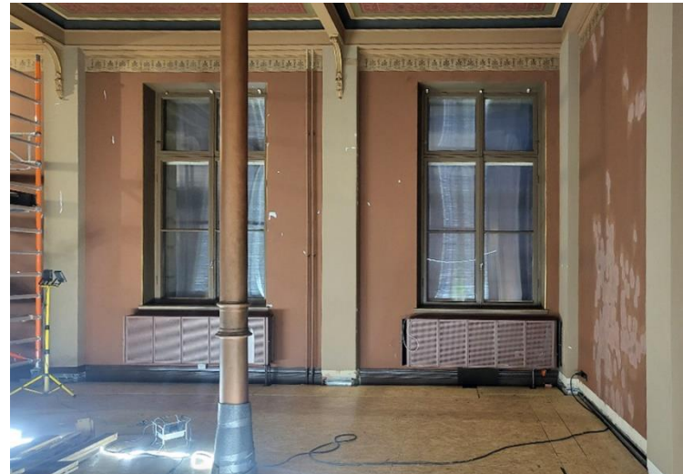
Ikkunapäätyseinän ja itäseinän paikattuja vauriokohtia
