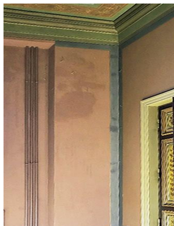
Glykolivaluman jättämiä rasvajälkiä.
