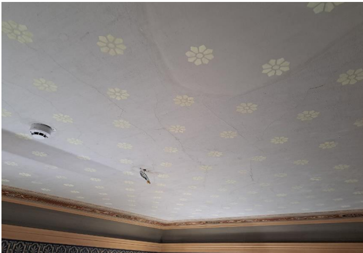
Kuva 5 Risteilevää halkeamaverkostoa ja vanha paikkamaalaus
