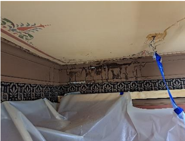
Kuva 51 Vesivaurion työmaa-aikainen laajentuminen
