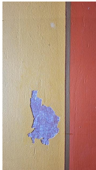
Kuva 3b. Maalinkiinnityksen jälkeen. Maalia oli pudonnut laajasti jo ennen kiinnitystä.
