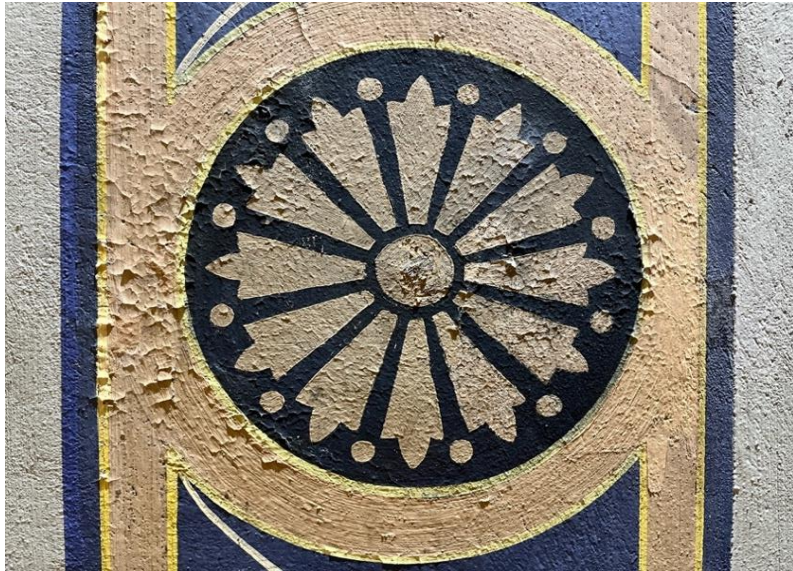
Kuva 3a. Irtoavaa maalia katon liimamaalilla maalatussa koristeessa.
