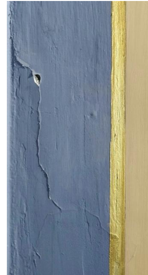
Kuva 8a. Pohjoisseinän sinisessä kehysosassa oli ulospäin pullottava halkeama.
