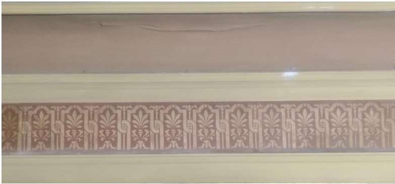
Kuva 9a. 1990-luvun peruskorjauksessa holkaan lisätty vahvike oli irronnut pohjastaan.
