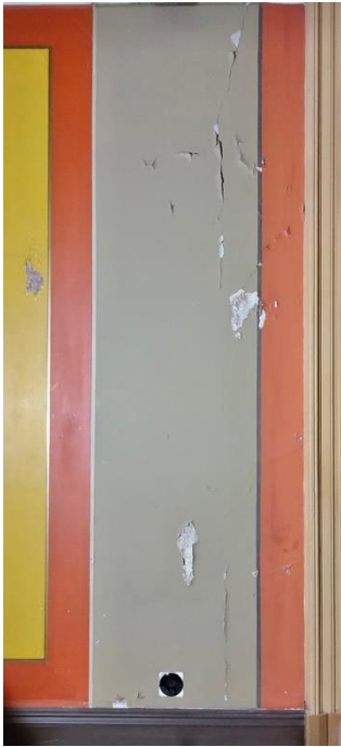
Kuva 11a. Eteläseinän länsipäädyn pilasterissa oli paljon irtoavia maali- ja tasoitekerroksia. Pilasteri on maalattu 1990-luvun peruskorjauksessa. Maalikerrokset olivat kovia ja taipumattomia.
