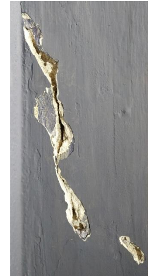
Kuva 8b. Halkeamasta poistettiin irtoava aines ja esiin tuli melko syvä onkalo.
