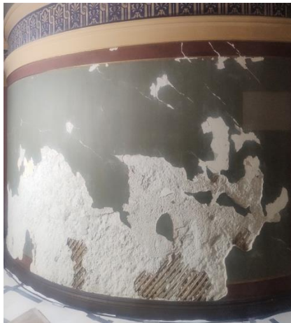
Yleiskuva koko kaarevan seinän laastivaurioista.
