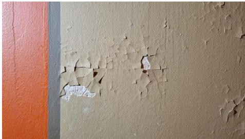
Kuva 5a. Länsiseinällä harmaan pilasterin alueella maali-irtoamaa, joka oli ulospäin käpristynyt.
