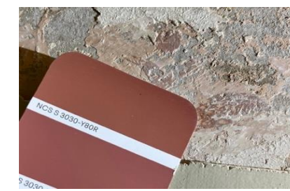
Vesivaurioalueen punainen palmetti NCS S 3030-Y80R. Sävyt ovat oletettavasti olleet samat, mutta vesivaurioalueen pinta on kovin huonokuntoinen.
