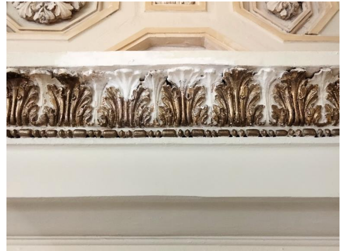
Akantuslehtien kärkien vaurioita oli eniten länsiseinustalla, jonka yläpuolisessa lipassa oli pitkittäinen halkeama. Kuvassa lehtien kärjet täydennetty mallikipsillä.
