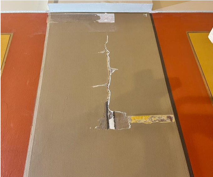
Kuva 19. Sähköjohtojen kohdalla ollut halkeama jatkui pilasterissa ylös asti.
