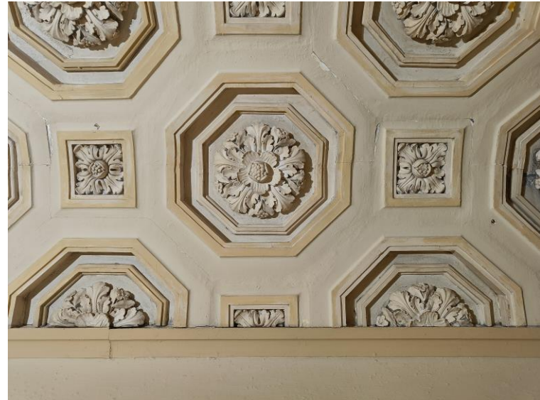
Taustapinnassa kasetointien saumojen halkeilua.
