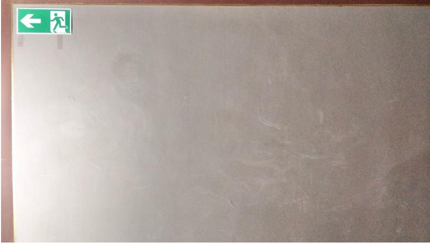
Kuva 6 a. Eteläseinän 1990-luvun peruskorjauksen aikainen, selluloosaliisteripohjainen liimamaali oli hyvin kulunut ja nuhjaantunut.
