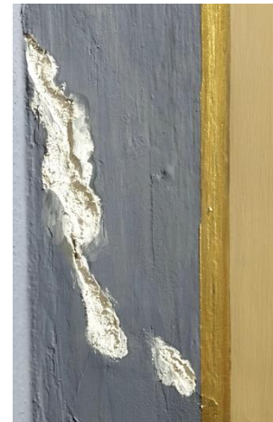
Kuva 8c. Halkeama täytettiin kipsilaastilla ja tasoitettiin LG ja LF tasoitteilla.
