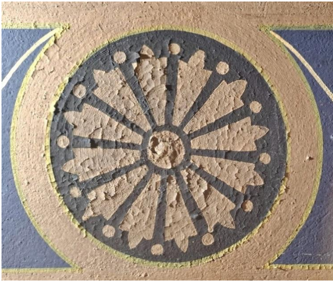
Kuva 2a. Koristeessa paljon irtoavaa maalia.
