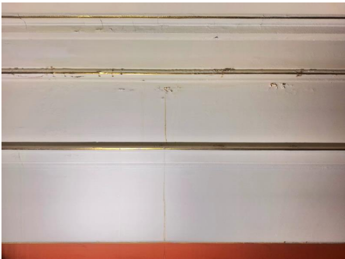
Kuva 9a. Eteläkäytävän itäpäädyn porrashuoneen katon rajassa ollut vesivaurio oli turmellut kattoa ja kattolistoja. Sivun kuvat on merkitty kattoprojektiokuvaan numerolla 9.
