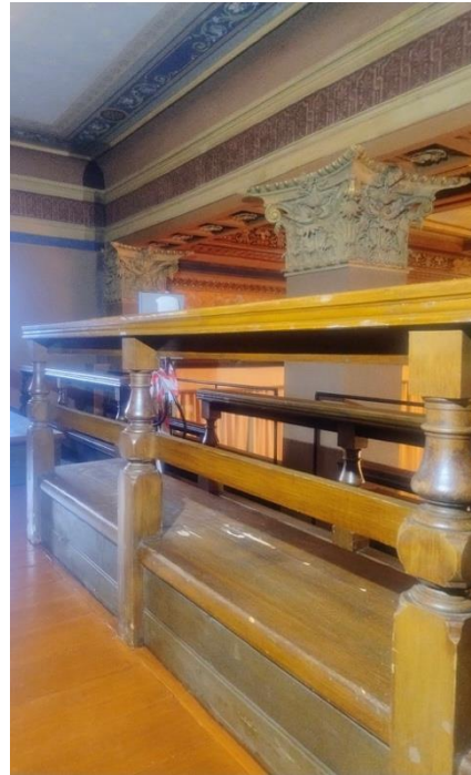
Penkkien ja kaiteiden pienet vauriot ennen retusointia.
