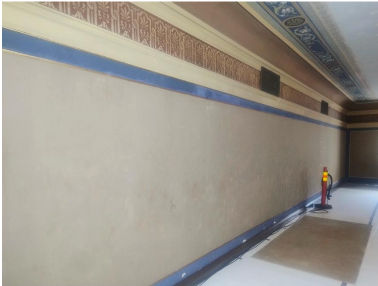
Kuva itäseinästä ennen toimenpiteitä. Seinä on kovin kulunut ja osa maalista on pyyhkiytynyt pois.
