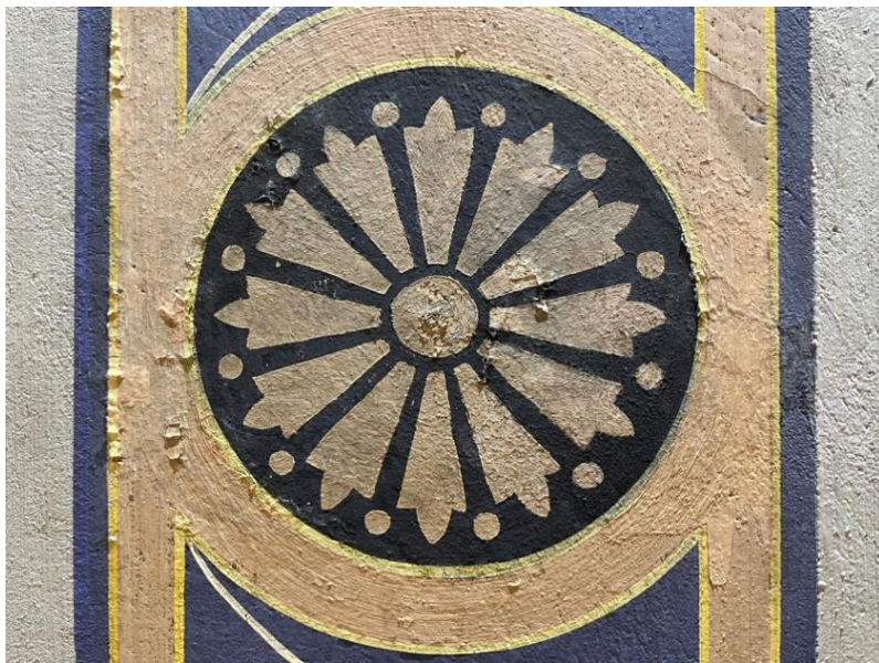
Kuva 3b. Katon koristeen irtoamat osittain kiinnitetty.
