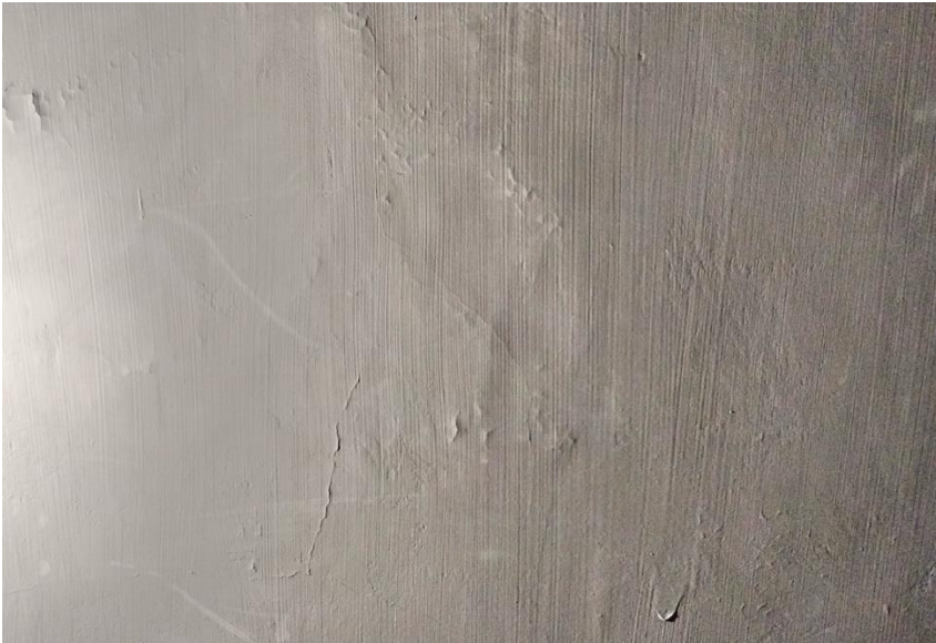
Kuva 6b. Sivuväli paljasti seinän pullistelevat halkeamat, maali-irtoamat sekä muut irtoava ainekset.
