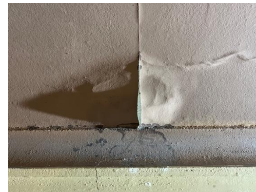
Kuva 11a. Holkkaan liimattu pahvinen vahvike on irronnut saumakohdasta ja pullistunut.
