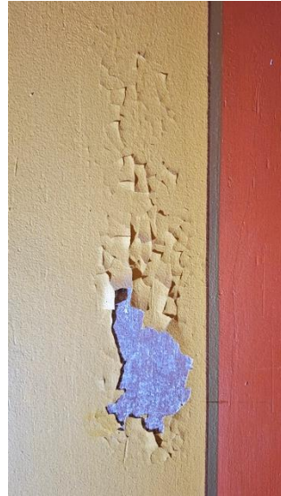
Kuva 3a. Runsaasti maali-irtoamaa eteläseinällä.
