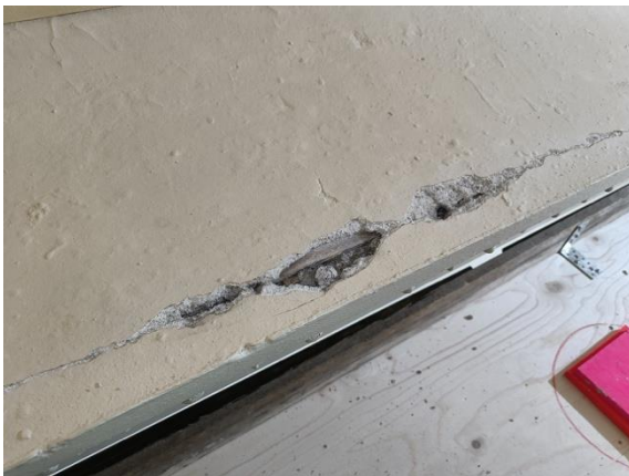
Pohjoisseinällä, pitkittäisen halkeaman kohdalla, lipan etureuna liikkui painettaessa. Halkeamat sijaitsivat pääosin etureunan muotolistan ja lipan kaarta muodostavan tikkurappauksen saumakohdissa.
