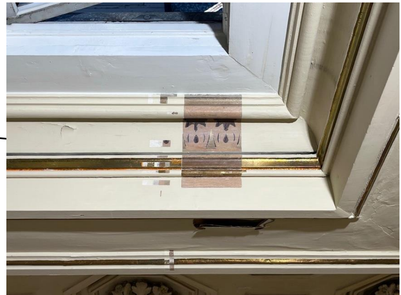
Lähikuva yläpalkiston alueesta. Koristemaalaus sijaitsee kaarevan listan alueella, jossa maalit ovat irronneet pohjastaan laajasti.
