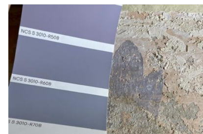
Vesivaurioalueen vihreä palmetti 3010-R60B. Palmetin sävyt vaikuttivat hyvin erilaisilta, mutta sävymuutos tulkittiin johtuvan vesivauriosta.
