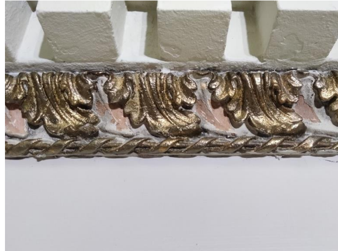
Taustan vaalea, ohut öljymaali hilseili irti. Öljymaalipinnan alta tuli esiin punertava liimamaali, jota löytyi palkiston alueella lähes kaikilta pinnoilta. Liimamaalin päällä oli heikosti kiinni oleva tummankeltainen liimamaali, joka irtosi öljymaalin kanssa.
