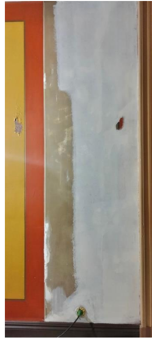
Kuva 11c. Oikeassa reunassa olevan halkeaman ja pehmeän laastin vuoksi alue vahvistettiin pintavahvistuskankaalla.
