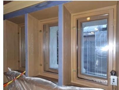
Parven ikkunasmyygeissä oli paljon irtoavaa maali- ja kittikerroksia. Kuva ennen toimenpiteitä.
