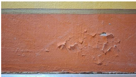
Kuva 6a. Punaisen kehyksen alueella maali-irtoamaa pohjoisseinällä.
