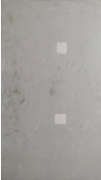
Kuva 7a. Pilarin yläosassa tummia kädenjälkiä ja vaaleita maalipaikkoja.
