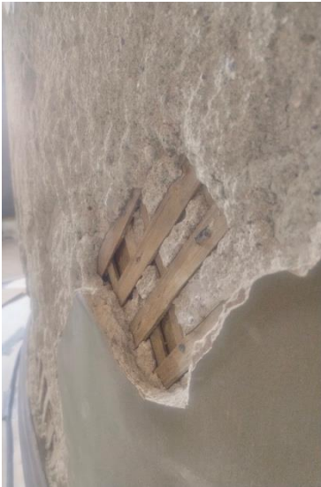
Kaarevan seinän laastivaurio, jossa tikkurappaus tullut esille.
