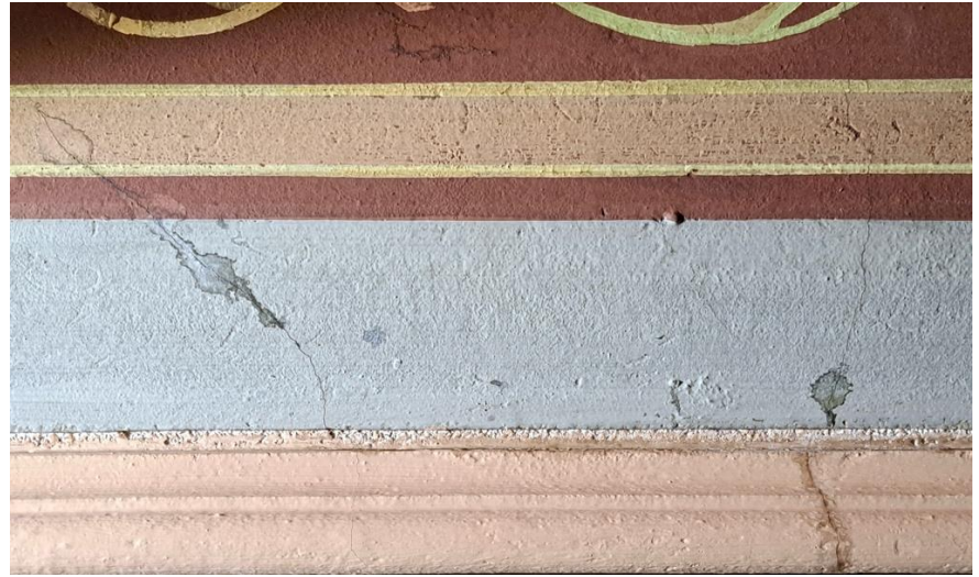
Kuva 2a. Sinisellä reuna-alueella ja kattolistassa tummia kosteuden tai muun valuman aiheuttamia jälkiä. Tämän kaltaisia vaurioita oli alueella laajasti.
