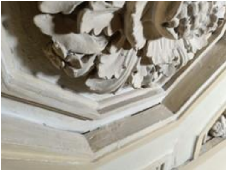
Kasetoinnin ja 1891 rappauspinnan sauman auenneita liitoskohtia.
