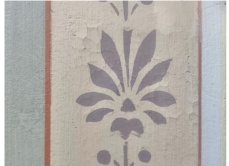
Kuva 1a. Katon palmettikuviossa irtoavaa maalia.
