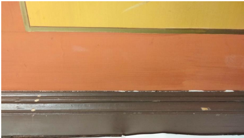
Esimerkkikuva jalkalistan vaurioista.
