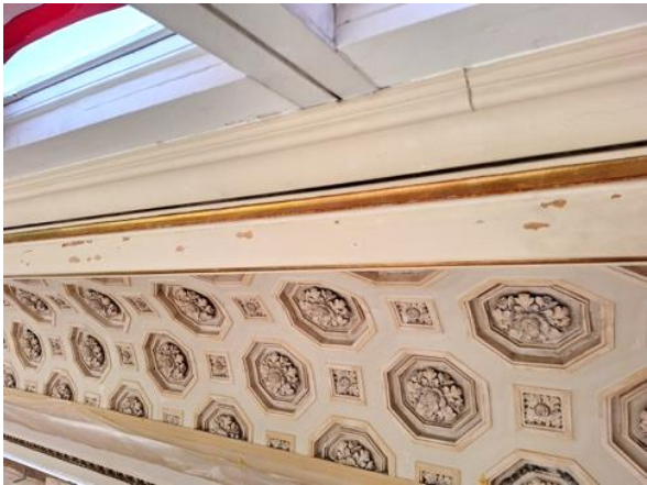
Listojen irti olleet maalikerrokset irtosivat puupinnalle asti.
