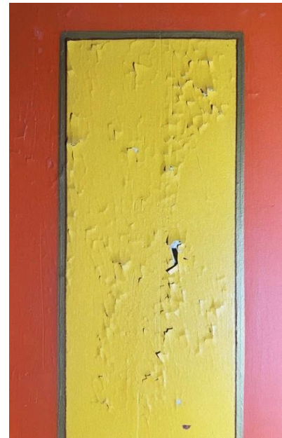
Kuva 1a. Länsiseinän vasemmanpuoleinen kapea seinäkenttä. Kentän yläosassa oli runsaasti isoa irtoamaa.
