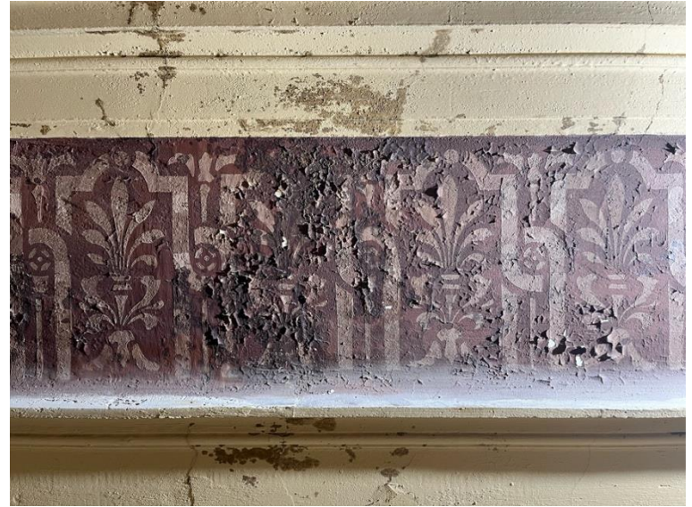
Kuva 8a. Vesivaurioalueella oleva friisi oli pahoin turmeltunut.
