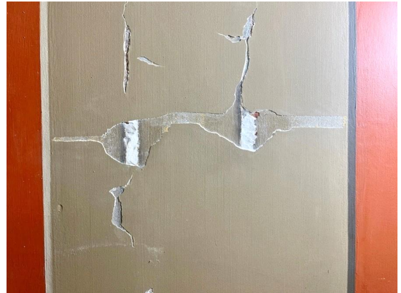
Kuva 18. Muutamasta maalatusta pilasterista löytyi eteläseinältä pohjatöiden yhteydessä vanhojen sähköjohtojen paikkoja.
