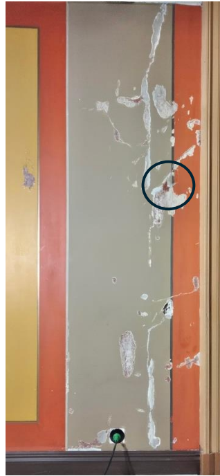
Kuva 11b. Pilasterin oikeassa reunassa sekä punaisen kehyksen alueella oli syvä ja liikkuva halkeama, jonka alueella laasti oli hyvin pehmeää ja hiekkautunutta. Irtoavien kerrosten poiston yhteydessä esiin tuli pieni alue vuoden 1904 maalikerrosta, jossa oli sekä pilasterin että seinäkentän maalia ja niiden välinen viiva (kuvassa ympyröity).
