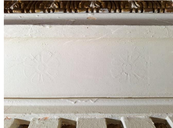
Korniisin alapinnassa (kaakkoiskulma) näkyy kohokuviona alkuperäistä, kukka-aiheista koristemaalauستا. Alueella ei ole pintavahvistuskangasta.
