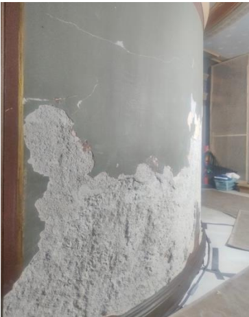
Kuvassa kaarevan seinän laaja laastivaurio. Laasti oli mureneva ja jauhoinen.
