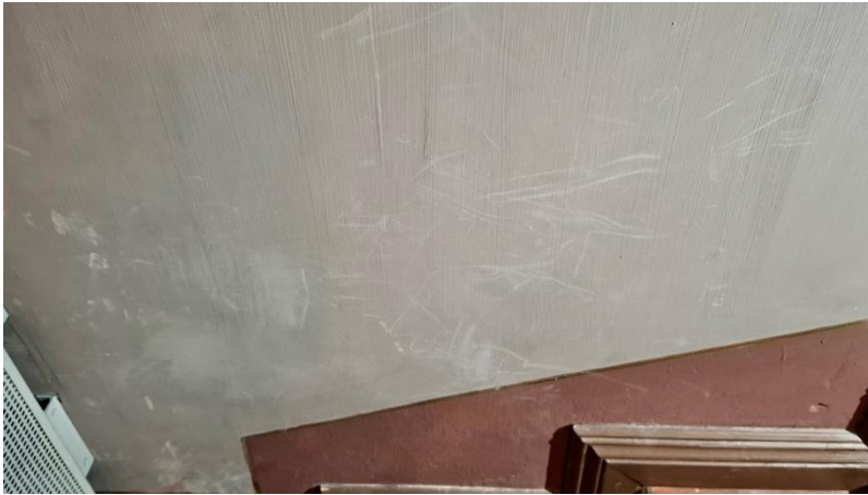
Kuva 7a. 1990-luvun peruskorjauksen selluloosaliisteripohjainen liimamaalipinta pohjoisseinällä. Pinta on kulunut ja nuhjaantunut eikä kestä kosketusta.
