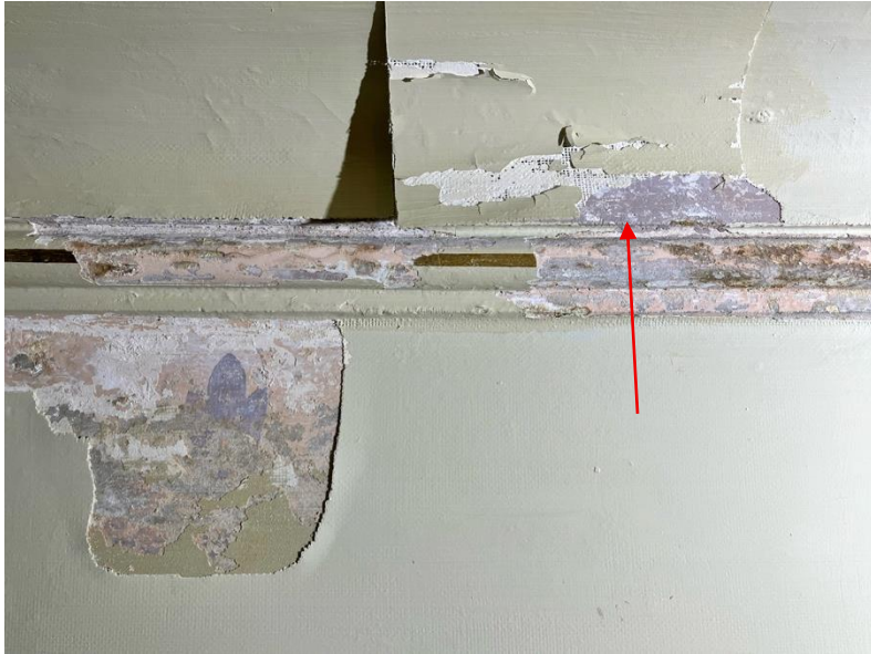
Kuva 17b. Eteläseinän esiinoton kohdalla holkkallistasta ei löytynyt maalikerroksia, sillä siinä kohdin oli rappauspaikka. Vesivaurioalueen kohdalla holkasta löytyi myös alin, vuoden 1891 liimamaalikerros. Kuvassa kapean listan yläpuolella (punainen nuoli osoittaa aluetta).
