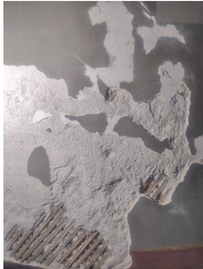
Esimerkkikuva kaarevan seinän laajasta, esiintulleesta tikkurappauksesta.
