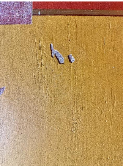
Kuva 2b. Irtoamat kiinnitetty. Osa irtoamista oli pudonnut jo ennen kiinnitystä.
