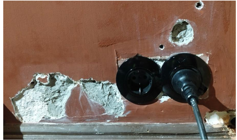
Parven 328 seinän vaurioita.
