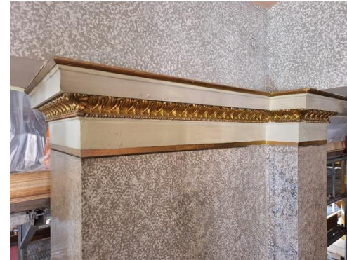
Kapiteelien vauriot olivat pääosin yksittäisiä maali-irtoama-alueita, liasta ja aiemmista korjauksista johtuvia kirjavia sävyypintoja. Maalikerrokset irtosivat laastipinnalle asti. Kuvassa kapiteeli ennen toimenpiteitä.
