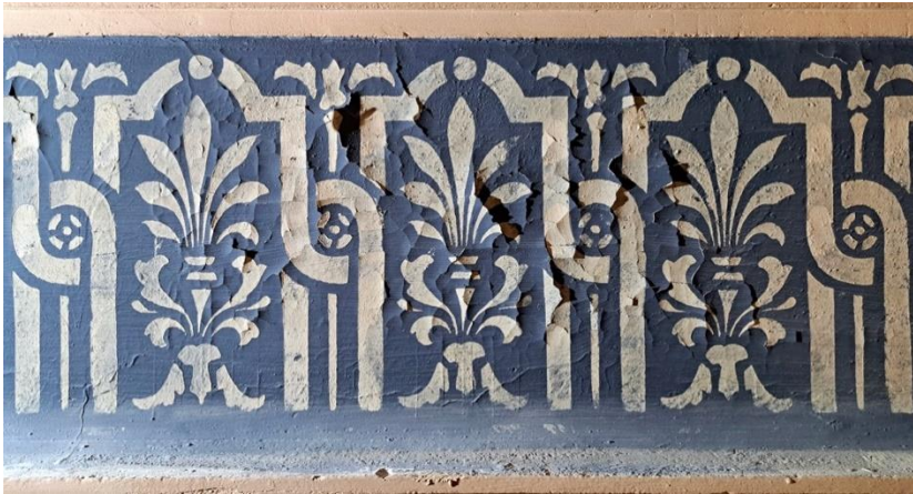
Kuva 4a. Länsiseinän friisissä oli runsaasti isoa irtoamaa. Kuva ennen toimenpiteitä.
