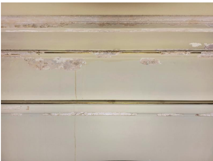
Kuva 9b. Vesivaurioalueelta poistettu irtoava aines. Tältä alueelta löytyi myös vanhempaa koristemaalausta, jota verrattiin länsiseinän esiinottoon.
