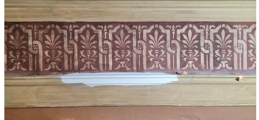
Kuva 5a. Friisin alalistan reunan kolhu täytettiin pääurakoitsijan toimesta kipsilaastilla. Kuvassa vaurio tasoitettu ja pohjamaalattu tartuntapohjamaalilla.
