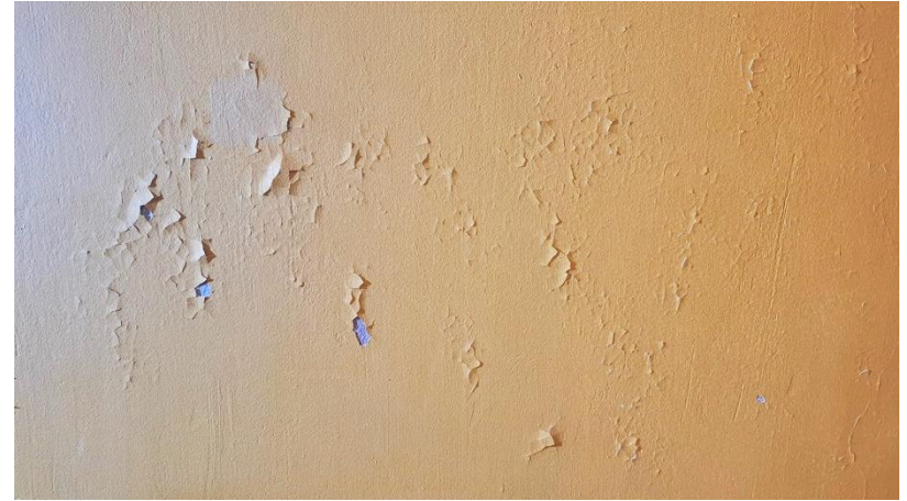
Kuva 4a. Länsiseinällä irtoavaa maalia oli laajoilla alueilla. Irtoamat olivat isoja kielekkeitä ja väleissä matalaa irtoamaa. Maali-irtoamien seassa erotettavissa jo pudonneita maalilastuja.
