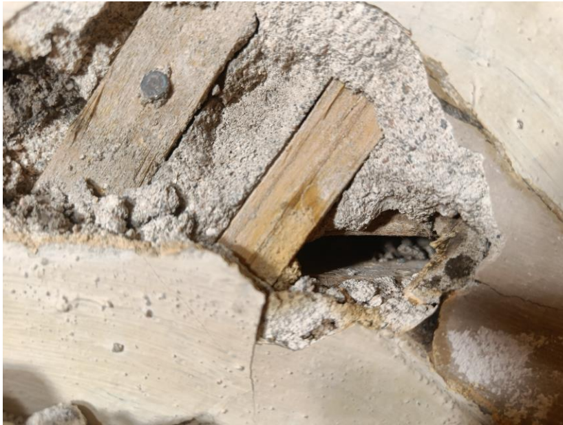
Kuvassa rappauksen tikutusta ja kiinnitysnaula sekä rappauskerroksen alla olevaa laudoitusta, lautojen välissä on noin 10 mm rako.
