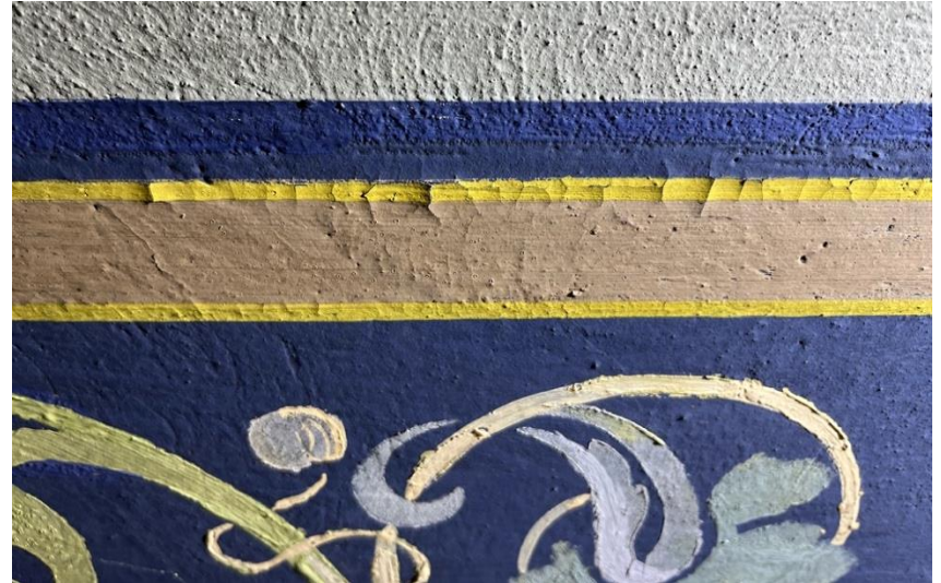
Kuva 2a. Muualla kattopinnoilla irtoamat olivat melko pieniä. Esimerkkikuva irtoamista viivoitusten alueella.
