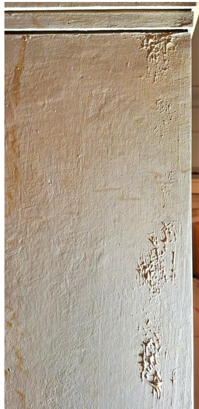
Pylvään tiheää ja paikoitellen esiintyvää maali-irtoamaa ennen toimenpiteitä. Kuvalla ei ole numeroa, sillä pylvään sivu ei näy projektiokuvissa.
