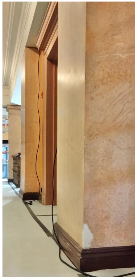
Kuva 15a. Syvä kolhu keltaisessa pilasterin ulkonurkkauksessa.
