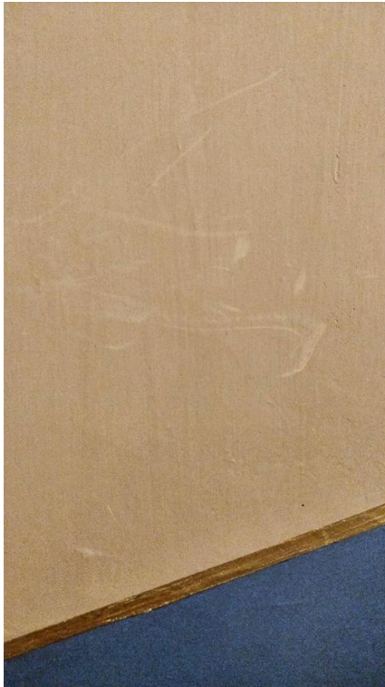
Kuva 12a. Eteläseinä on edellisen 1990-luvun peruskorjauksen aikaista liimamaalipintaa. Kuvassa seinäpinnan nuhjaantumista.
