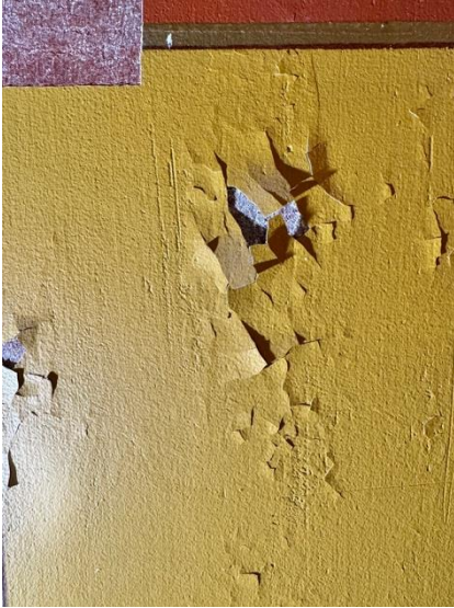
Kuva 2a länsiseinä. Isoja, kielekemäisiä maali-irtoamia ennen toimenpiteitä.
