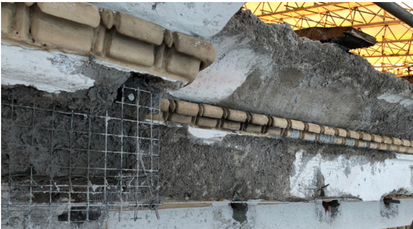
Räystäällä oli laajoja vaurioalueita.
