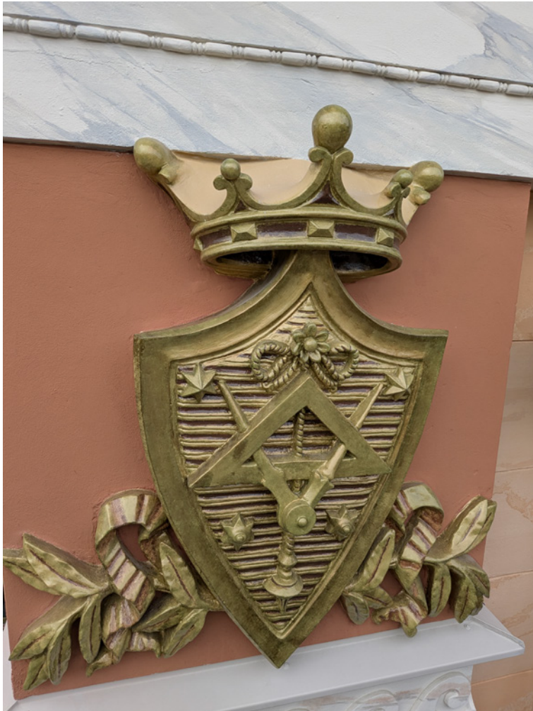
Kruunun yläpinta on täysin säälle alttiina.
