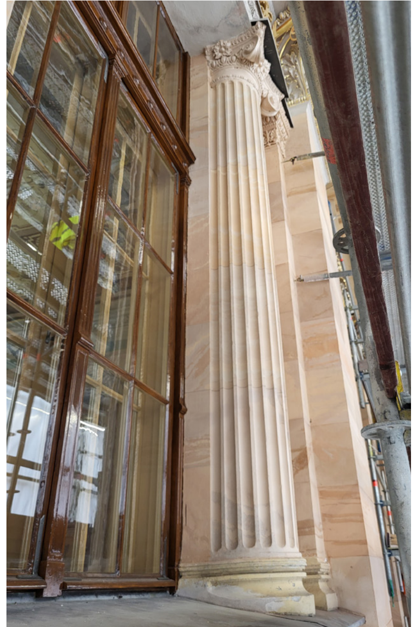
Urapilasterissa ja smyygissä hydrosilpintaa ja taaemmissa pilastereissa kalkkimaalaus. Basikset on vielä maalaamatta.
