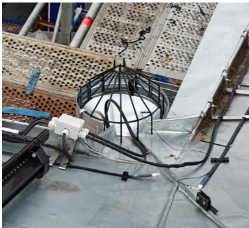
Syöksytorven suppiloon on asennettu lintueste.
