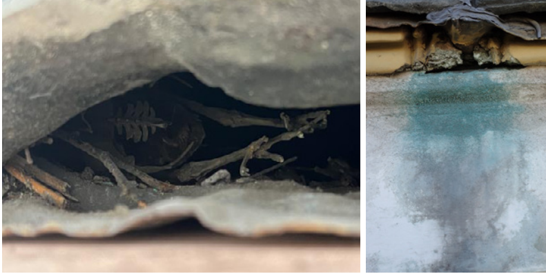
Patsaan sisään on mennyt lintuja, jotka eivät pääse pois. Patsas vuotaa ja valuttaa useista kohdin pistemäisesti vettä alapuoliseen rakenteseen.
