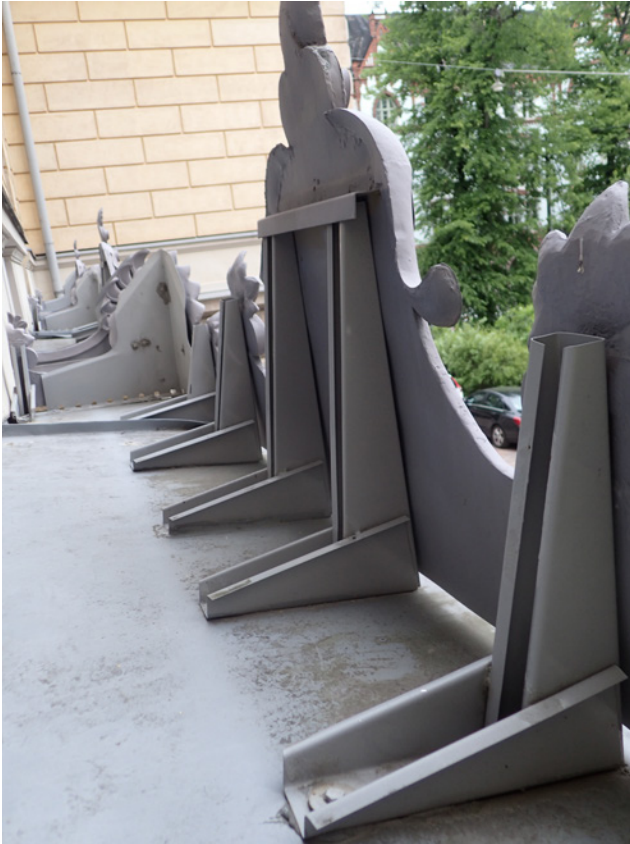
Takapihan ovien sikkikoristeet oli edellisellä kerralla kiinnitetty lukuisista kohdista pellin läpi. Tästä syystä katokset olivat vuotaneet pahasti. Kuva vanhoista kiinnikkeistä otettu ennen purkutyötä.
