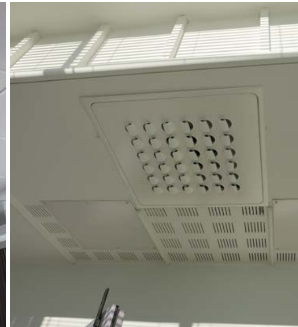
Alakaton ilmanvaihtosäleikköjä ja huoltoluukut.
