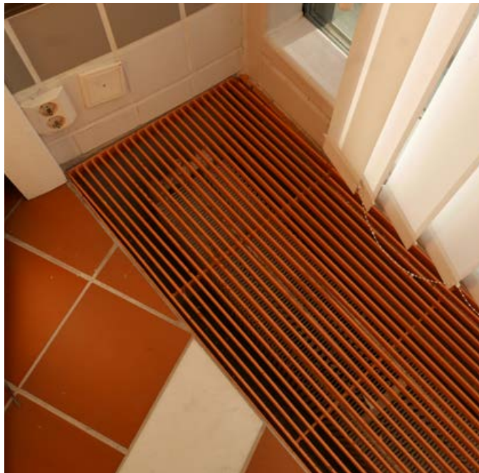
Lämmityspatterit on piilotettu aulassa lattiaan ritilän alle.
