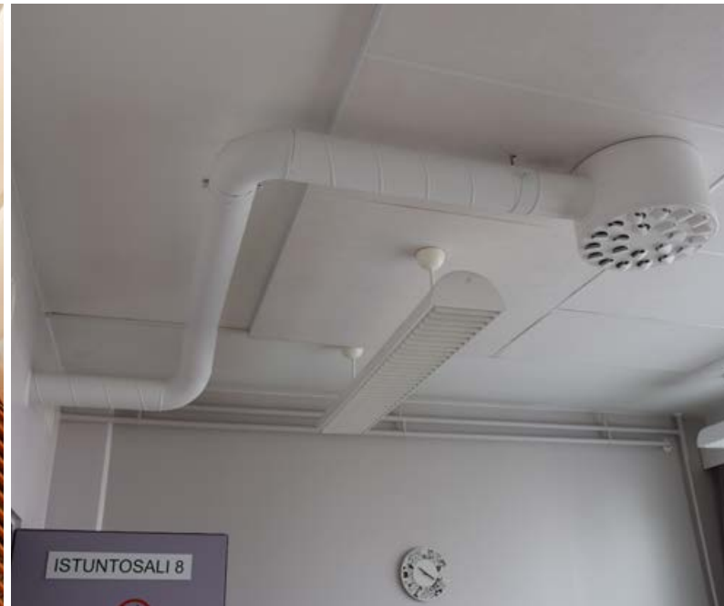
Toimistohuoneen ilmavaihtolaitteistoa. Kuva on vuodelta 2022.
