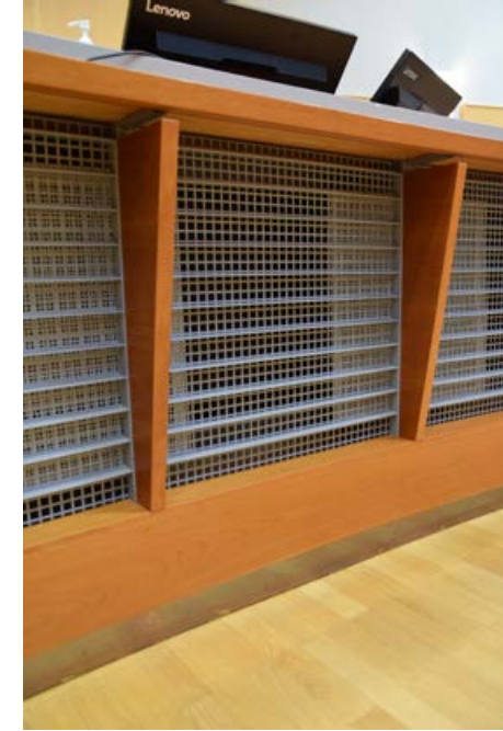
Istuntosalin pöytään integroitua ilmavaihtolaitteistoa ritilän takana. Kuva on vuodelta 2022.
