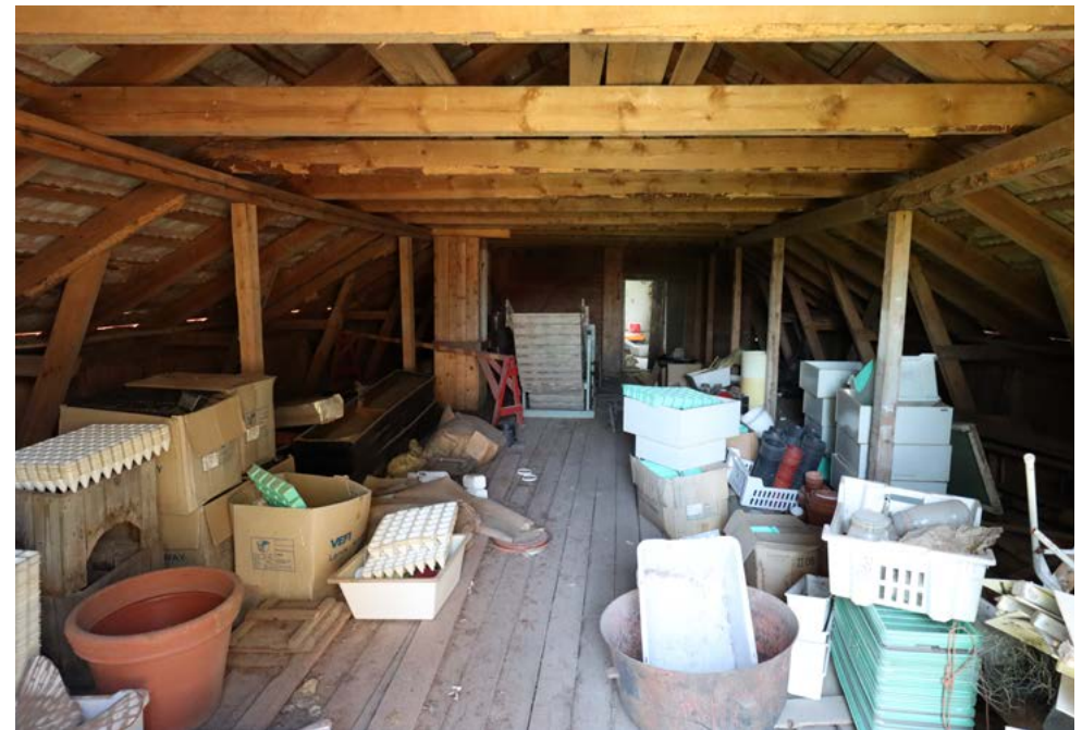
Ylisten kylmä osa on säilyttänyt lähes alkuperäisen muotonsa, mutta vesikatto- ja seinärakenteet on uusittu oletettavasti katemateriaalin vaihtamisen yhteydessä. Kuva: Riitta Kosonen 9/25, Arkkitehtitoimisto Jorma Teppo Oy.
