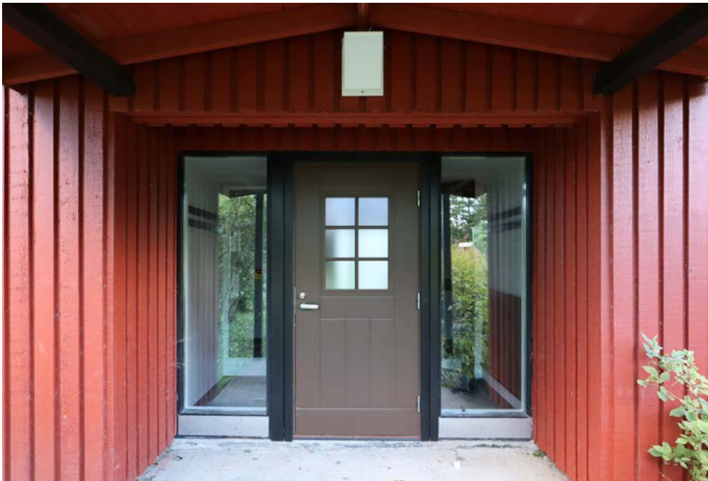
Toimistorakennuksen alkuperäinen 1970-luvun ulko-ovi on vaihdettu alkuperäisestä tyylistä poikkeavaan, yksilehtiseen HDF-oveen. Kuva: Riitta Kosonen 9/25, Arkkitehtitoimisto Jorma Teppo Oy.
