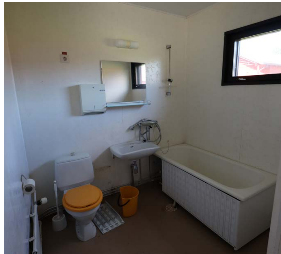
Asuinrivitalon alkuperäiseen kylpyhuoneen kalustukseen kuuluivat wc-istuin, allas sekä suihkulla varustettu kylpyamme. Tilan seinä- ja lattiapinnat päällystettiin muovimatoilla ja muovipintaisilla tapeteilla. Kuva: Riitta Kosonen 9/25, Arkkitehtitoimisto Jorma Teppo Oy.
