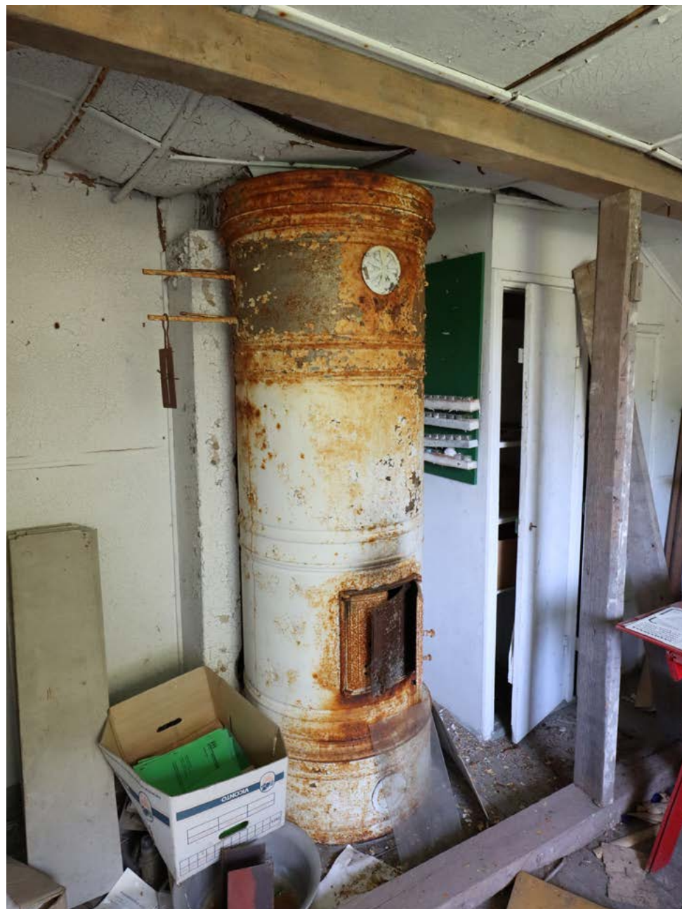
Huoneen lämmittämiseen käytetty pöytäuuni jonka edustalla on kattorakenteita tukemaan asennetut puupilarit ja -palat. Kuva: Riitta Kosonen 11/25, Arkkitehtitoimisto Jorma Teppo Oy.
