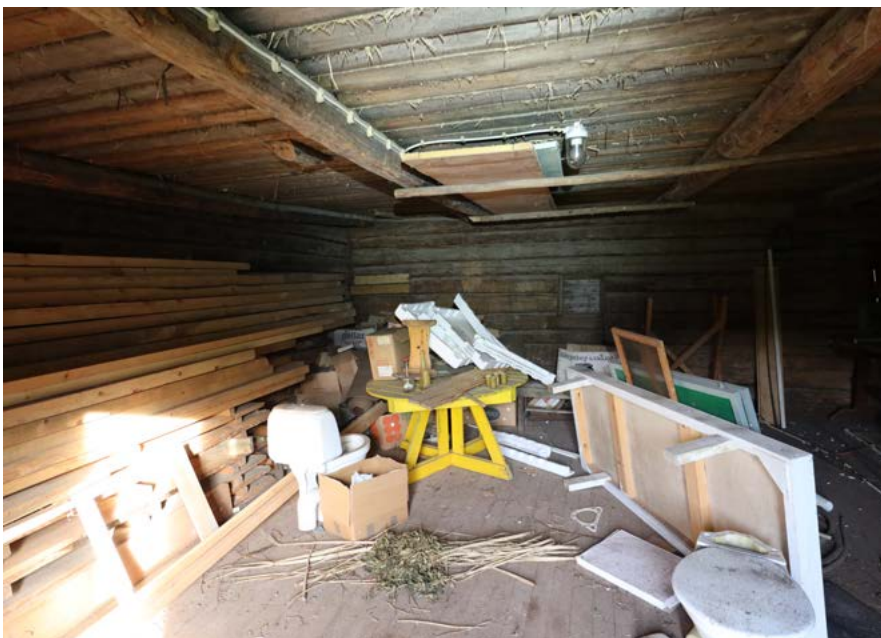
Pohjoispäädyn huoneen takaseinällä erottuu siinä aiemmin ollut ikkuna. Kuva: Riitta Kosonen 9/25, Arkkitehtitoimisto Jorma Teppo Oy.
