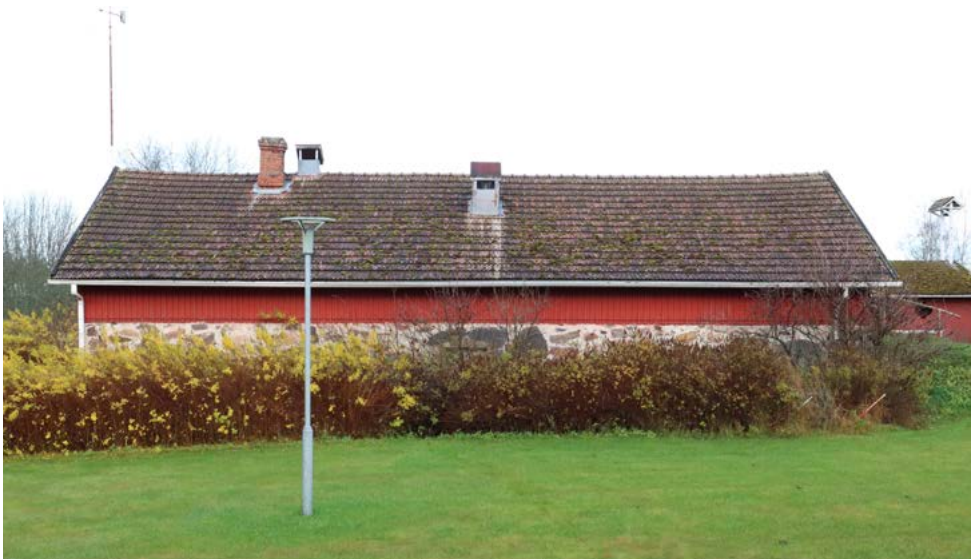
Kivinavetan pihan puoleinen julkisivu on peittynyt sankan kasvillisuuden taakse. Kuva: Riitta Kosonen 11/25, Arkkitehtitoimisto Jorma Teppo Oy.
