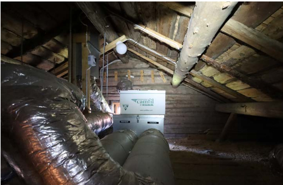
Ullakolle on sijoitettu kookkaita ilmanvaihtokanavia. Kuva: Riitta Kosonen 9/25, Arkkitehtitoimisto Jorma Teppo Oy.
