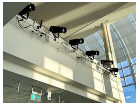
Parvilämpöön 4.157 Juha-päädyn puoleiseen kaiteeseen asennettiin vuonna 2023 uudet valonheittimet lämpiötapahtumia varten.
