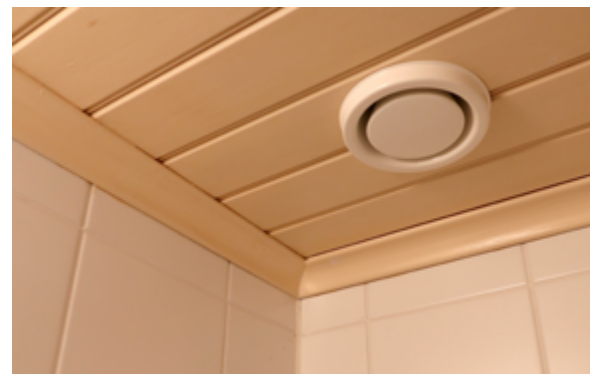
Kellarikerroksen wc-tiloissa ym. yleisesti käytety KSO-venttiili. 6/2025.
