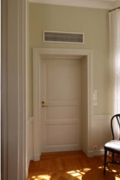
Ruokasalin poistoilmanvaihdon ratkaisu tehtiin jo 1983 peruskorjauksessa. 6/2025.
