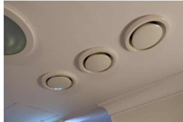
Kellarikerroksen monitoimitilan poistoilman KSO-venttiilit. 6/2025.
