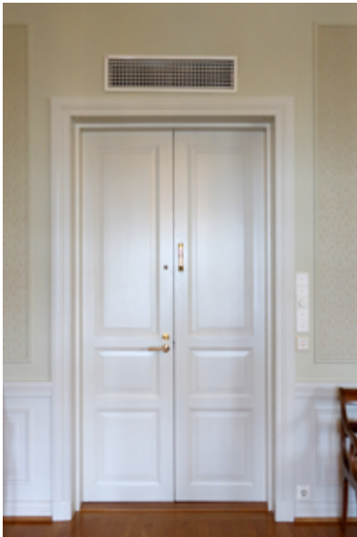
Salin poistoilmanvaihdon ratkaisu oli niin ikään tehty jo 1983, mutta säleikkö uusittiin 2003. 6/2025.
