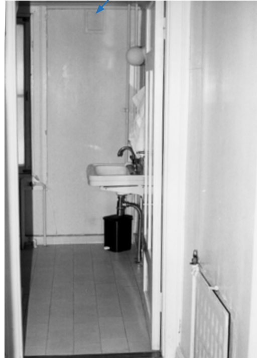
Alakerran WC kuvattuna 1970-luvun lopussa. Sinisellä nuolella osoitettu alakerran wc-tilan (1952) epäortodoksinen ilmanvaihtokaisu eli läppäventtiili pääsisäänkäynnin eteiskäytävän puolelle. Aukko poistettiin 1979–1983 peruskorjauksessa (vrt. nykytila). Kaisa Vepsäläisen kokoelmat.
