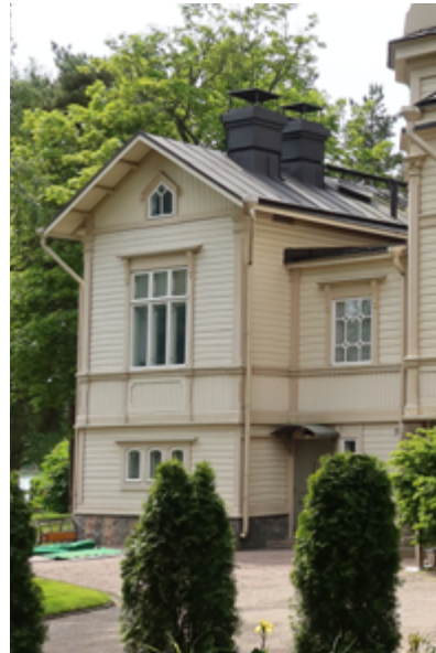
Poistoilmanvaihdon järjestelmäpiiput ja rasvakanava sijaitsevat keittiösiivessä. 6/2025.
