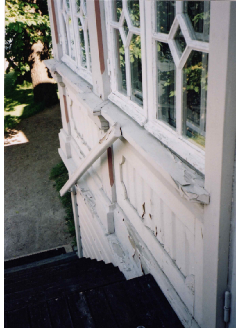
Rannan puolen lasiverannan maalikerrokset olivat heikosti kiinni alustassa 2002. Kuva Seija Linnanmäki 2002, MV. Edellisen peruskorjausvaiheen työselityksen 1979 mukaan julkisivuverhoukset oli määrätty tehtäväksi kauttaaltaan kestopuusta, samoin ikkunat ja ovet karmeineen sääille alttiilta osiltaan.
