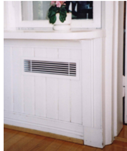
Poistoilmaratkaisu rannan puolen lasive-rannalla, oven molemmin puolin sijoitetut kanavat ja niihin liittyvät suojaritilät. Kuva Seija Linnanmäki 2002, MV.
