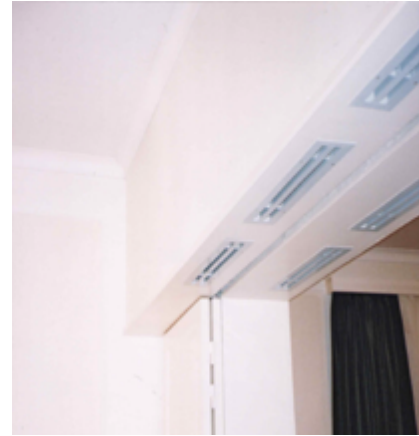
Ruokasalin ja salin väliseen leveään oviaukkoon integroitiin koneellisen ilmanvaihdon tuloilmapuolen kanava ja suutinritilät. Ratkaisuperiaate on nykyisinkin olemassa, mutta uudelleen rakennettuna vuoden 2003 peruskorjauksessa. Kuva Seija Linnanmäki 2002, MV.
