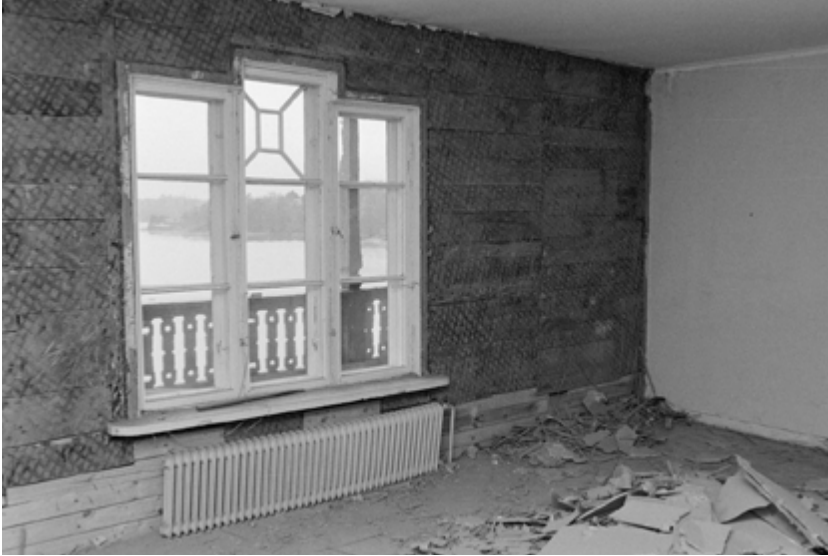
Yläkerran asunnon olohuone purkutyövaiheessa 1981–1982. Ulkoseinästä oli purettu pois tikkurappauskerros ja alta paljastui vaihtelevan levyinen laudoitus. Seinän alaosassa on nähtävissä myös aikaisemman korjaus tms. työvaiheen vaaleampisävyinen paikka-alue. Kuva JOKA.
