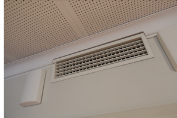
Kellarikerroksen monitoimitilan tuloilman säleikkö. 6/2025.
