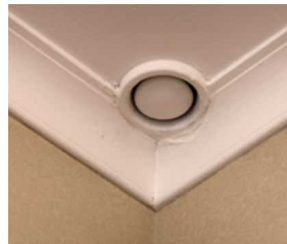
Pääte-eliminä yleensä käytettyjen ritilöiden sijaan rakennuksen aputiloissa on myös tavanomaisia pyöreitä venttiileitä. Kuvassa poistoilmakanavan lautasventtiili alakerran naulakkotilan katossa. 6/2025.
