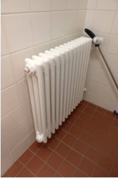
Rakennuksen kellarikerroksen tiloissa on nykyisin myös historiallisen valurautaradiaattorin mukaisia vuoden 2003 peruskorjauksessa asennettuja pylväsradiaattoreita, joista LVI-suunnitelmiin on kirjattu "Itula Oy".
