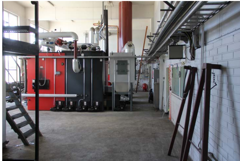
Lämpökeskuksen pellettikattila on järjestelmän uusiin laitos. Laitteen omistaa ja sitä ylläpitää aluelämmön sopimustoimittaja.
