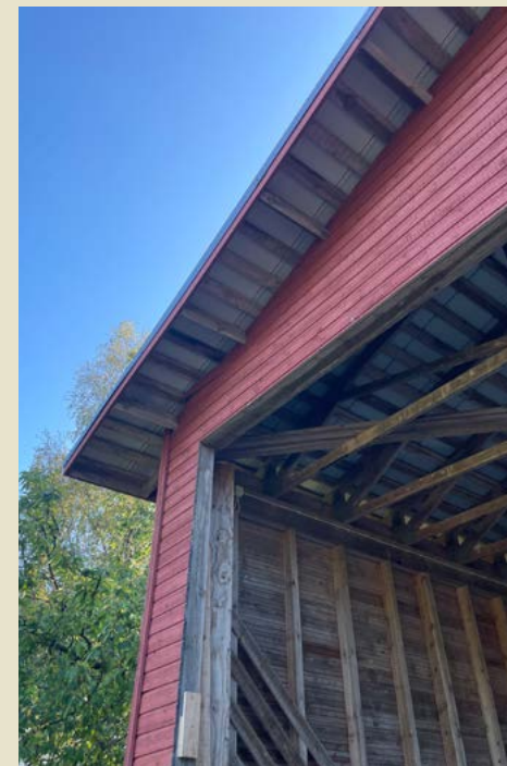
Lähikuva räystäästä. Rakennuksessa ei ole sadevesikouruja.
