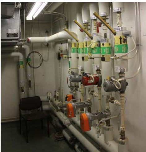
Laajennusosan kellarissa on ilmanvaihtokonehuone, jossa on myös lämmönvaihdin.
