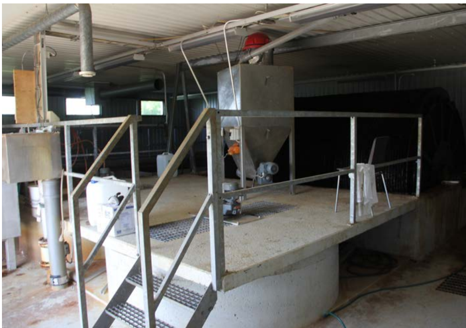
Pumppaamo syöttää jätevettä takana näkyvään sylinterialtaaseen.
