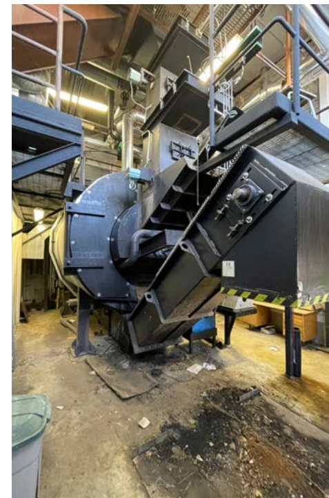
Hakekattila on uusittu vuonna 1999.
