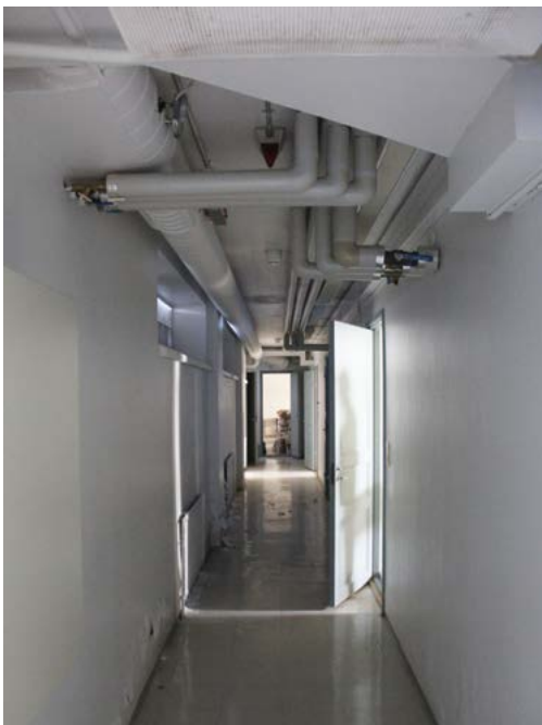
Kellarikäytävän kattoon on ripustettu putkikanaaleja. Käytävän päässä on askartelutilat.
