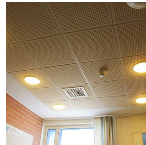
Alakatto on tehty perforoidusta akustiikkalevystä. Valaisimet ja ilmanvaihtoköijet ovat uppoasennettuja.
