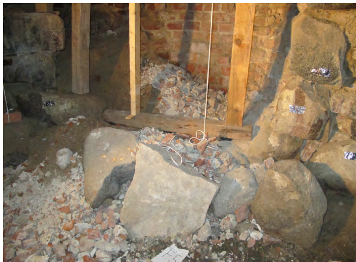
Tulisijan ja sitä ympäröivien muurien kosteusvaurioita korjattiin vuonna 2009. Pudonneet kivet muurattiin paikoilleen, kolot syvätätettiin laastilla ja rapautuneet laastisaumat uusittiin.
