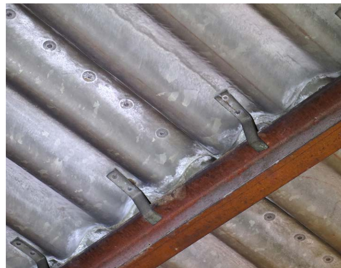
Aktimakasiin vesikatto alta nähtynä: yhteen niitatut sinkityt aaltopellit ja klammerit, joilla kate on kiinnitetty kattotuoleihin.
