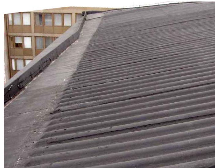
Kuva aktimakasiinin vesikatosta 5/2010, ennen vesikatteen peittämistä uudella rakenteella. Aaltopellitetty alue on alapuolelta rautarakenteen kannattama, kun taas sileä pellitys on muuratun räystään alueella. Aktimakasiinissa on tyypillinen vesijalkaränni. Kuva Keijo Kekoni, ISS Suunnittelupalvelut Oy, R574-01-04, SA.
