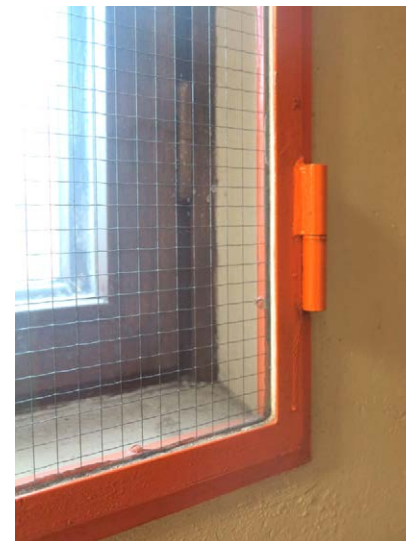
Ulkoikkuna puupuiteinen, sisäpinnassa teräsikkuna.
