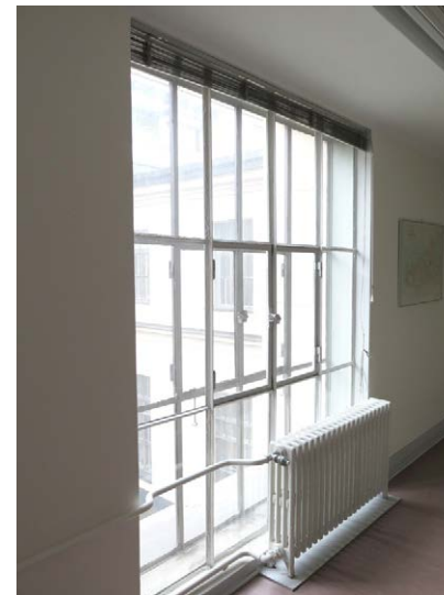
Käytävän ikkunoiden sisäpuolelle ei ole asennettu uusia alumiinikehyksisiä ikkunoita.
