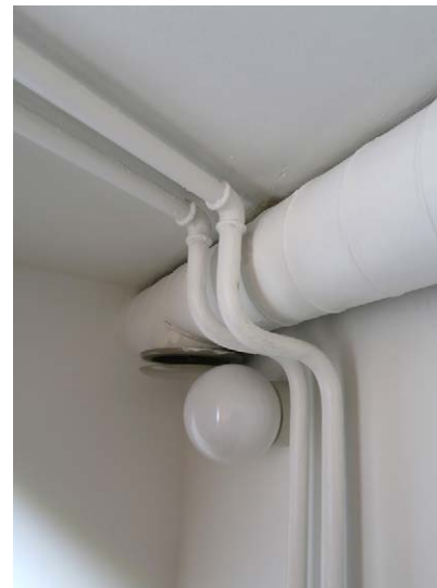
Koneellinen ilmanvaihto, vesiputket ja valaistus kohtaavat tiiviisti.
