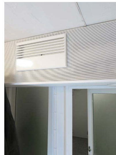
Iv-kanava kulkee oven yläpuolella; perforoitu pelti-kotelointi.
