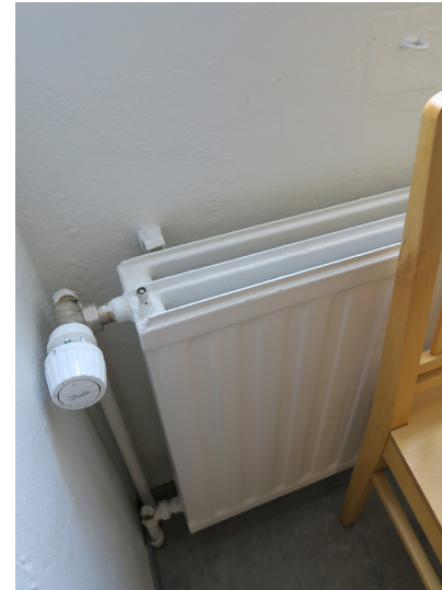
Toimistotiloissa on levyradiaattorit, 1970-lukua.
