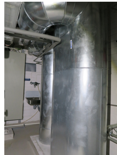
Vuoden 2001 perusparannuksen yhteydessä makasiinitilaan rakennettiin iv-konehuone.
