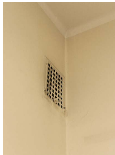
Työhuoneen ylänurkassa on vanha ilmanvaihtokanavan rautasäleikkö.
