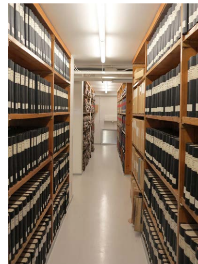
Arkistohyllyjen välejä valaisevat uudet loisteputket.
