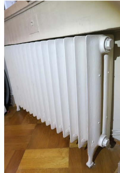
Högforsin Teho-radiaattori. Näitä rakennuksessa on vain muutama: tässä ja vestibyyliässä. Vestibyyliässä tuotu paikalleen vasta HAN vaiheessa.
