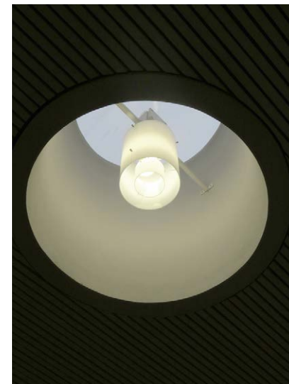
Pyöreät kattokuvut ja valaisimet, tiettävästi Orno 71- 200/300W, sähkösuunnitelman mukaan.
