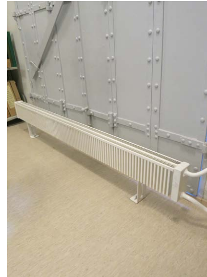
Ikkunan rautaluukkujen edustalla matala peltisäle-radiaattori.
