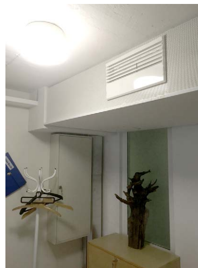
Iv-kanava kulkee oven yläpuolella.
