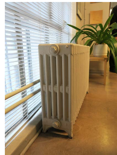
Ikkunan edustalla on valurautaradiaattori 1927-28.
