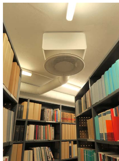
Tilaan 2002 rakennettu koneellinen ilmanvaihto, pääte-elin ja ...
