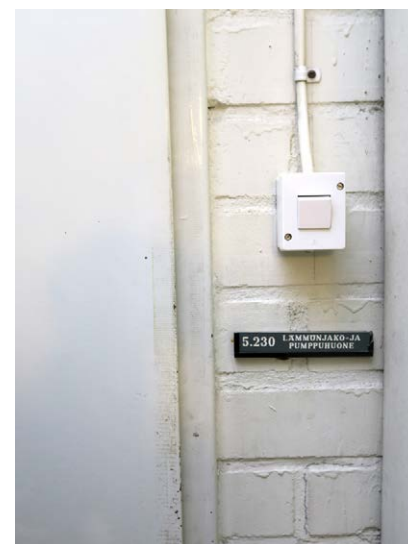
Ovieli lämmönjakuhuoneen 5.230 suuntaan
