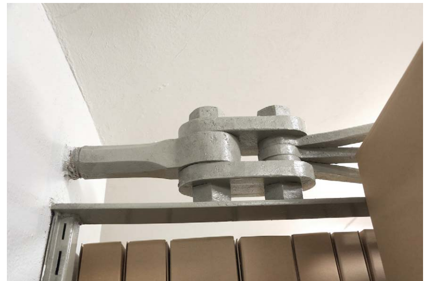
Vetotanko haarautuu nivelliitoksella kolmeen ohuempaan tankoon, jotka on ankkuroitu tiilimuuriin.
