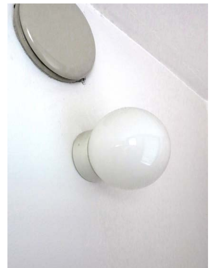
Miesten WC:n istuintilan seinällä on pallovalaisin ja koneellisen ilmanvaihdon ruskeaksi maalattu lautanen.
