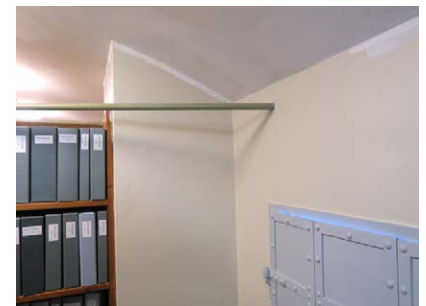
Vetotanko on ankuroitu tiilimuuriin.
