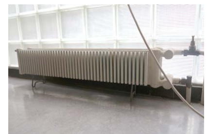
Tutkijahuoneen matala konvektori.
