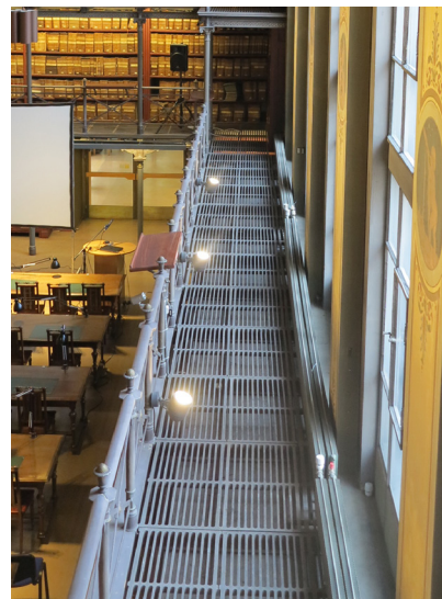
Matala peltisäleradiaattori tutkijasalin lehterillä.
