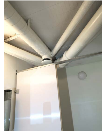
WC-tiloissa talotekniset asennukset ovat paljaina.
