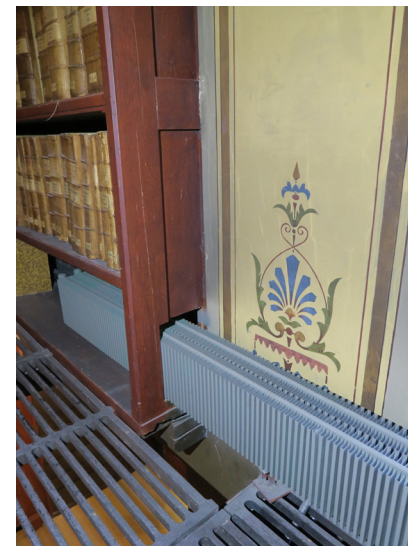
Radiaattori on lähes koko pohjoisseinän pituinen.
