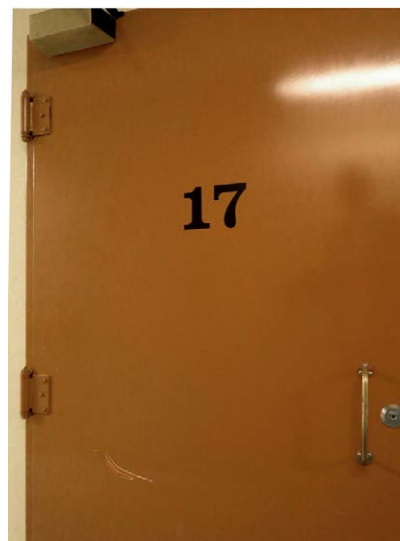
1. kerroksen tunnisteväri on ruskea; makasiinin 17 palo-ovi.
