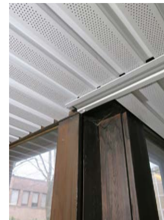
Daempan katto kuljetuskäytävässä
