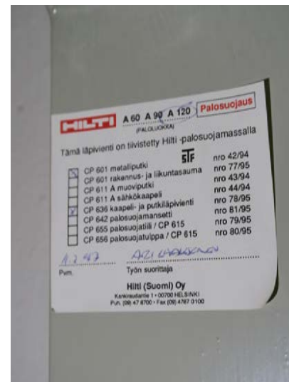
1996-97 aktimakasiinin peruskorjauksessa palosastoinnin läpivientejä parannettiin.
