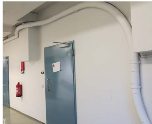
Putkipostiputket kiemurtelevat M-makasiinissa, kuva 8. kerroksen käytävältä.
