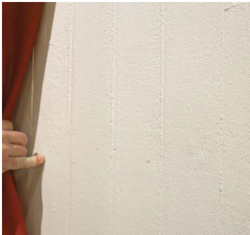
Yksi keskeisimmistä seinistä, sisääntulohallin seinä Nyströmin virkailijakäytävän seinää vasten, epäonnistui valupinnaltaan. Lohdutuksena pintaan on tehty keskikarkea rappaus ja uritus, mutta raakavalupintaa jälki ei tavoita.
