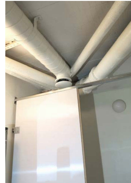
Makasiinin WC-tiloissa IV-kanavat ja viemärit ovat vapaasti näkyvillä.
