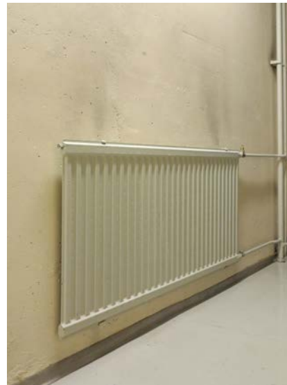
Tyypillisesti käytetty pyykkilautaradiaattori
