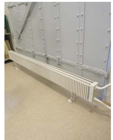
Aktimakasiinin peruskorjauksessa 1996 asennettiin radiaattorit -ikkunaluukkuja ei voi avata.
