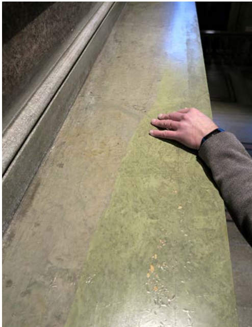
Vihreän harkkokerroksen maalauskunnostuksen sävyerot näkyvät paikoin sangen voimakkaasti.
