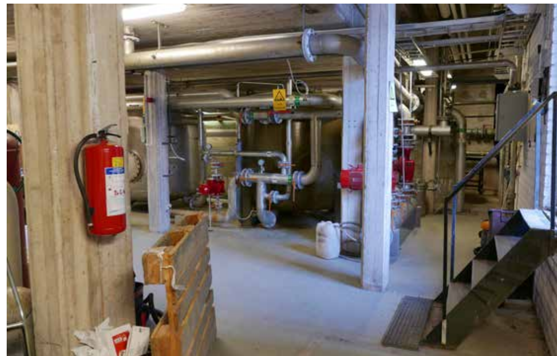
Yleiskuva teknisen tilan hallista sisäänkäyntiporrasta kohden.
