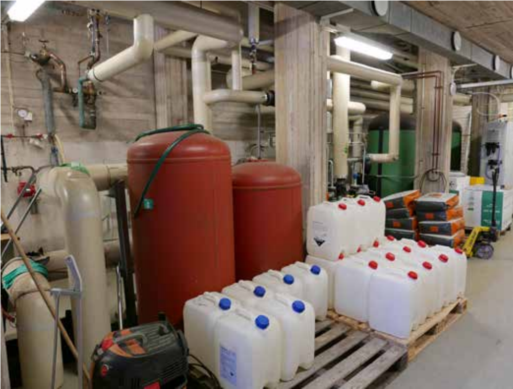
Uimahallin teknistä tilaa kellarissa.
