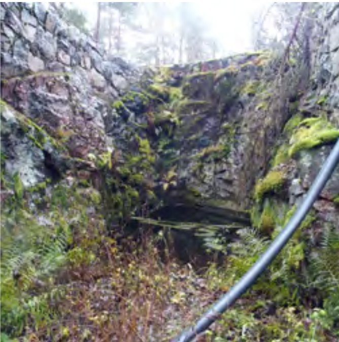
Yllä: Patterin no 3 tunneliruutikellarin no 54 vedellä täyttynyt suuaukko.
