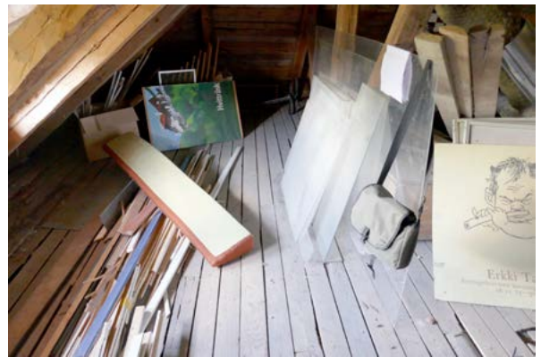
↑ Epämääräiset tavarakasat häyttäsivät liikkumista ja rakenteiden kunnon tarkastamista kaikissa ullakkotiloissa, ullakko 307. amoy 18.7.2019
