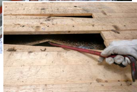
↑ Aluslaudoituksen ponttaamattomia lautoja oli jatkettu ilman, että niiden alla oli rakenteellista tukea. Laudan päähän oli kuitenkin lyöty naula. amoy 4.6.2020
