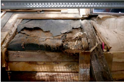
↑ Kattoikkunan alapuolisen lappeen rakenteiden lahovaurioita ennen korjausta. amoy 11.6.2020
