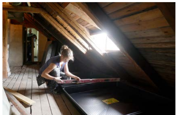
↓ Kattoikkunan alapuolelle asennettiin tilapäiskorjauksen lisäksi myös suoja-altaat, joita huoltomies kävi tarkastamassa ja tarvittaessa tyhjentämässä. amoy 19.8.2019
