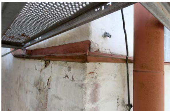
↑ ↓ Pellin alapuolisia muurivaurioita luoteiskulmalla ja pohjoisjulkisivulla. Pohjoisjulkisivulla pelti oli nostettu ylemmäksi kuin länsijulkisivulla. amoy 16.5. ja 19.8.2022
