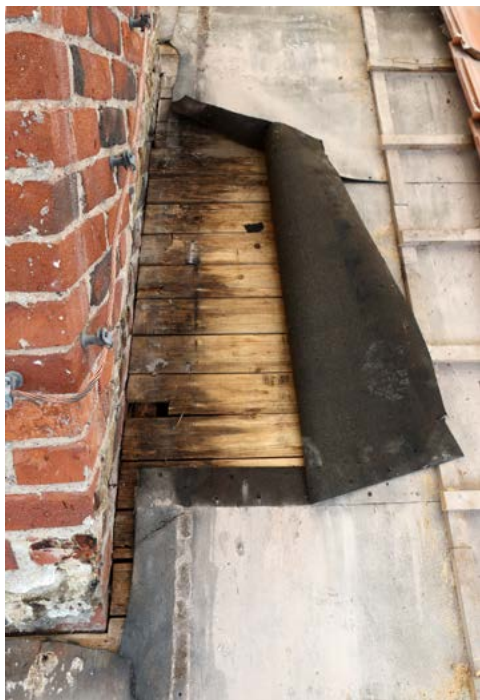
POHJOISPÄÄN PIIPUNJUUREN LAHOVAURIO
