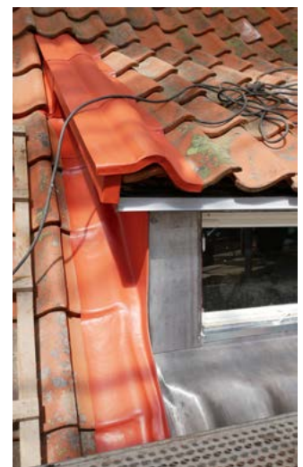
lainen tippapelti kuin länsilapteen kattoikkunoihin aiemmin keväällä. Tippapelti jatkuu samanlaisena viereisellä kattolap- peella ja erkkerin räystäällä. amoy 6.7. ja 21.7.2020
