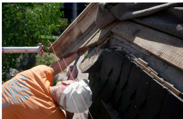
↓ Alempi lanka osoittaa räystään entisen linjan ja ylempi linjan johon räystäs piti kulmassa nostaa. amoy 29.6.2021
