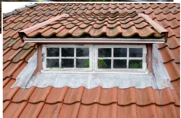
↑ Ullakon 307 kattoikkunan räystään etureunaan asennettiin syksyn 2019 tilapäiskorjauksessa peltinen tippa-nokka estämään veden valumista räystään alapintaa pitkin sisään päin. amoy 20.11.2019
