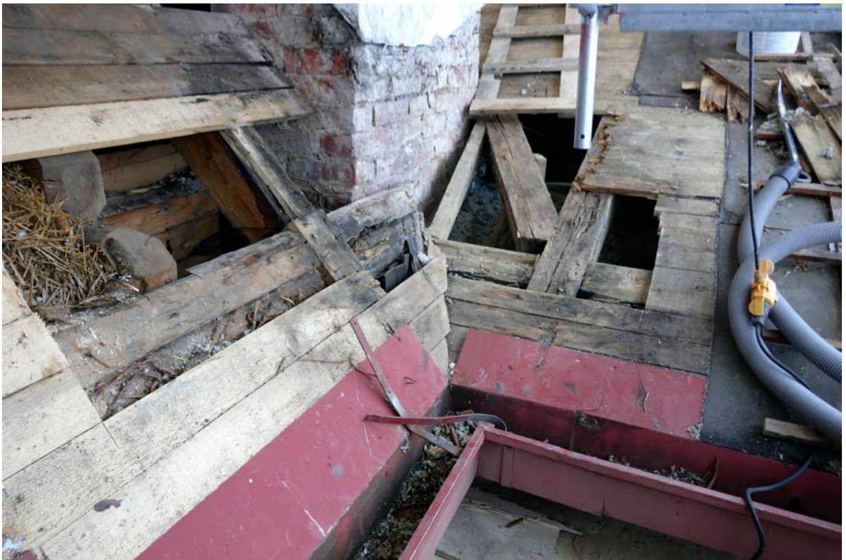
↓ Lahovauriokohtien avaus piipun 308A molemmin puolin. Vasemmalla piipun itäpuoli, oikealla pohjoispuoli. Ainakin itäpuolella oli uusittu aluslaudoitusta jo aiemminkin. amoy 26.11.2018
