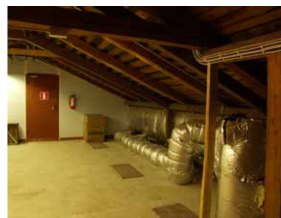
Ullakko 410 IV-konehuoneen sisäänkäynti
