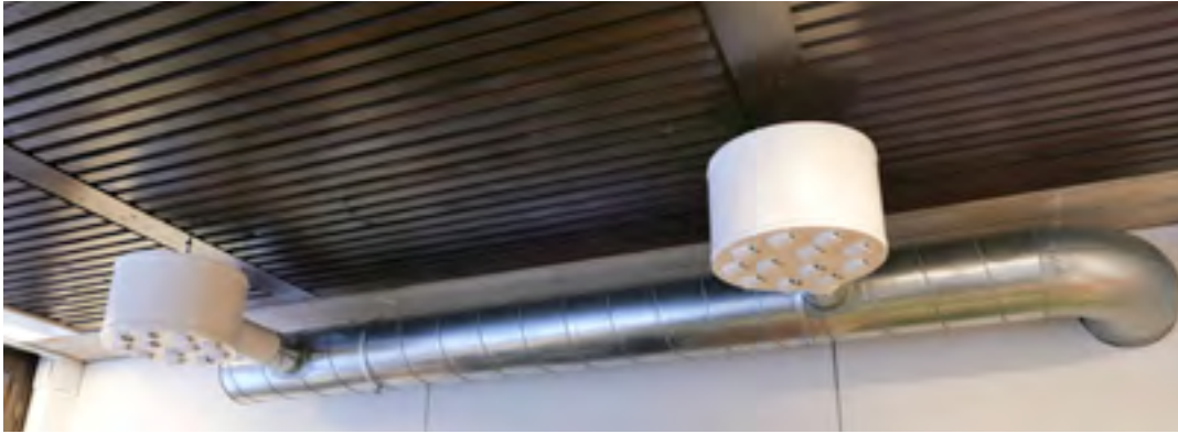
Toimistohuoneen 6a ilmanvaihtopäätelaitteet.
