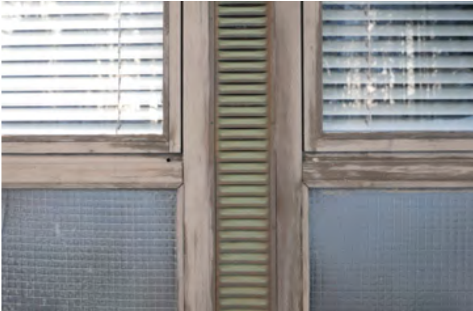
Alkuperäisten ikkunoiden lähikuva. Ensimmäisen kerroksen ikkunat on ilmeisesti huoltomaalattu aikaisempaa vaaleammalla ruskealla ja tummempi sävy on tullut esiin paikoittain. Osa messinkisäleiköistä on patinoitunut vihertäväksi.
