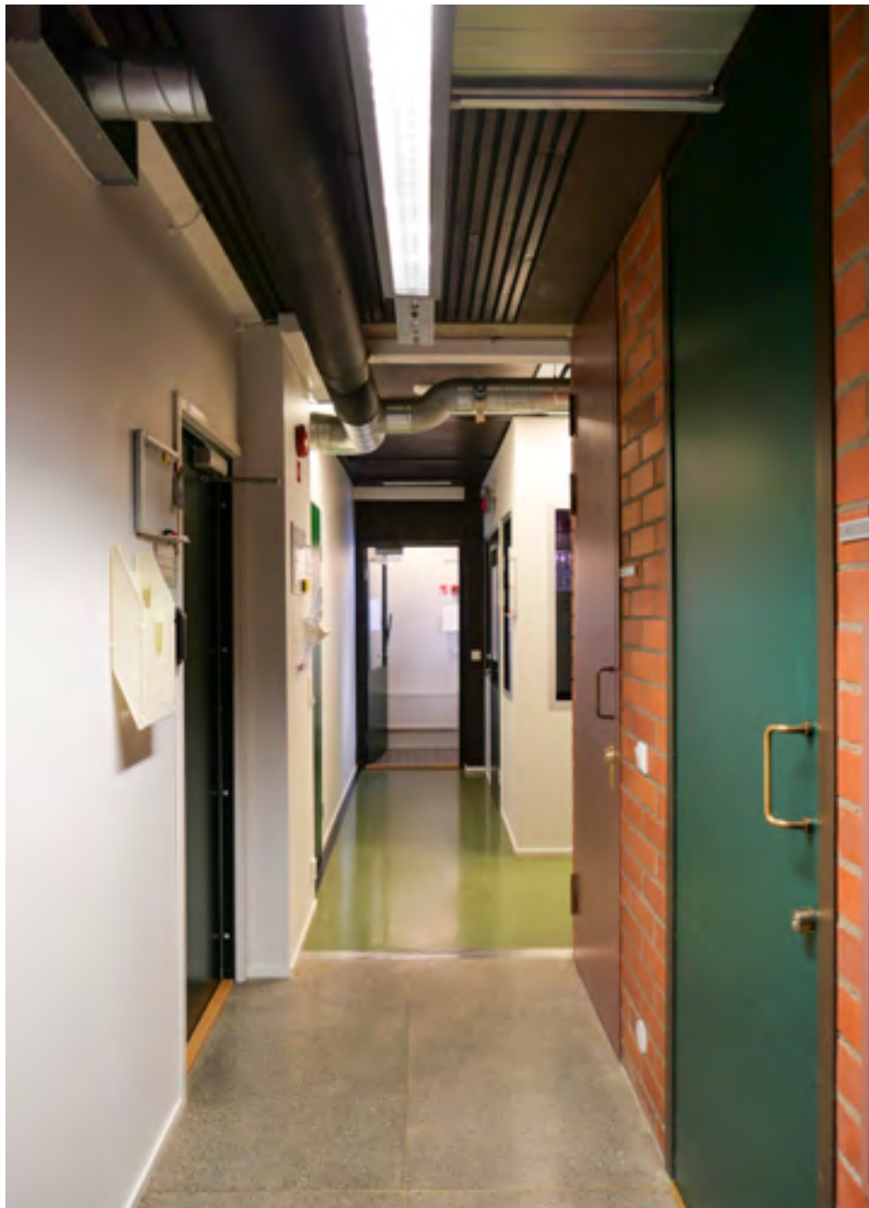
Ensimmäisen kerroksen käytävä kuvattuna vaatenaulakotilan kohdalta. Rakennuksen uudet IV-kanavat on johdettu käytävällä rimakaton alapuolella. Kanavat ovat peittäneet alkuperäiset loisteputkivalaisimet, joten kanavien alapuolelle on lisätty uudet valaisimet.
