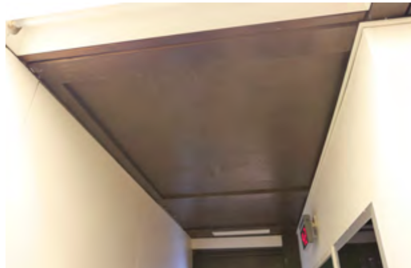
Käytävällä 33a rimakattoa on korvattu vanerilla.
