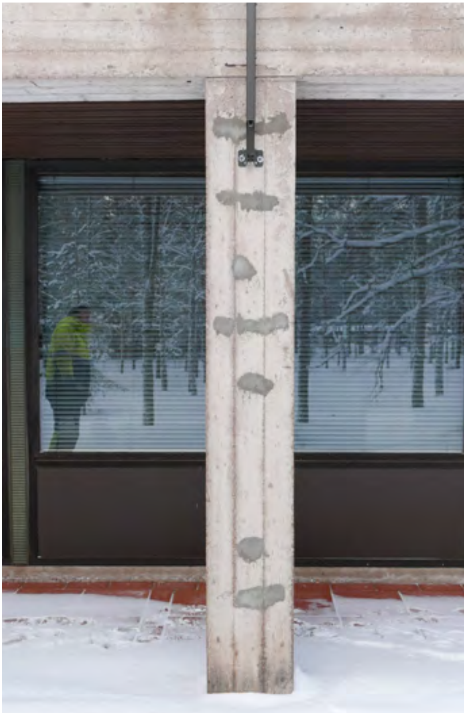
Eteläisivulla betonipinnan korjauksia on tehty huomattavasti julkisivua tummemmalla laastilla. Punainen pihalaatoituksen korostusosa sijoittuu aivan rakennuksen vierustalle.
