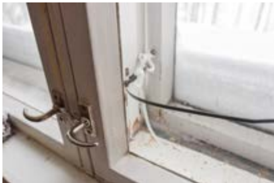
Rakennuksen kaikki ikkunat ovat 1950-luvulta.
