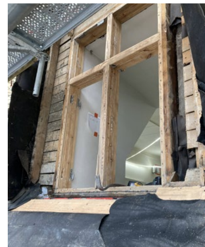
Viidennen kerroksen ikkunakarmi; 31.9.2021.
