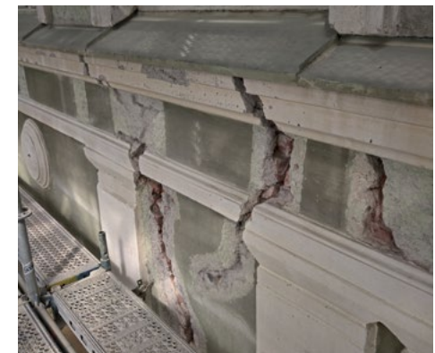
Julkisivun halkeamien avaus; 12.8.2021.
