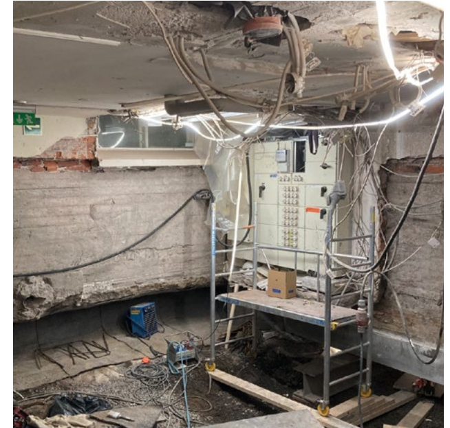
Sähköpääkeskus rakennustöiden aikana; 9.12.2021.
