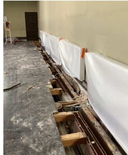
Juhlasalin lattiakanaali ja seinällä tilapäiset radiaattorit ennen korjausta; 2.9.2021.
