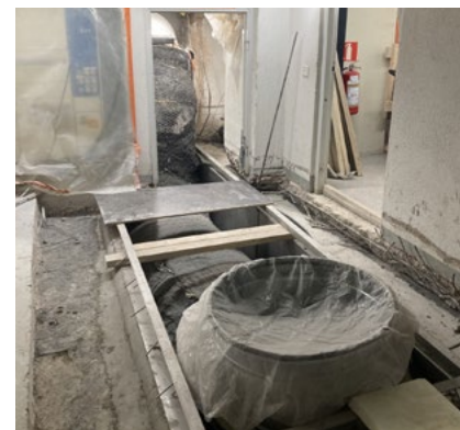
Uusi raitisilmakanava päärakennuksen kellarissa varastossa 013; 10.3.2022.
