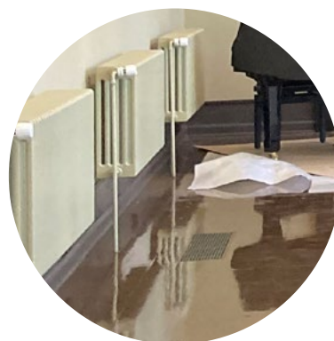
Patterit ja lattiasäleiköt; 23.8.2022.
