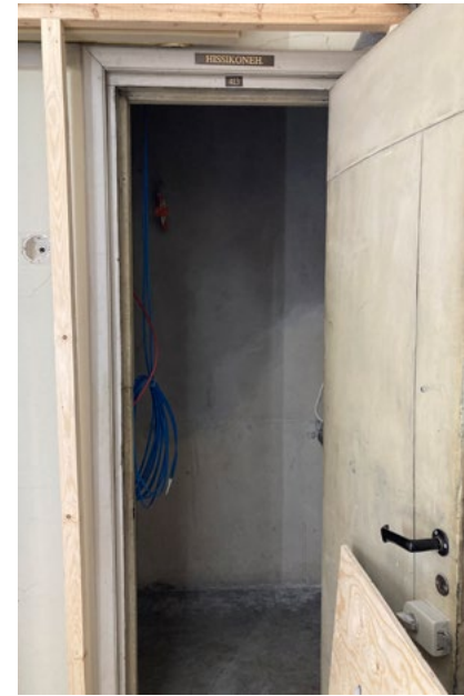
Entinen hissikonehuone 413, johon toteutettiin puhelineriö; 31.3.2022.
