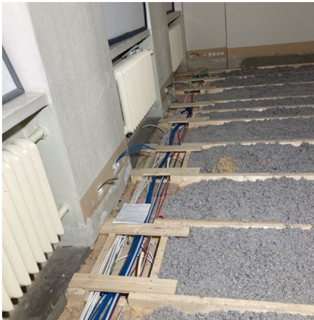
Sähkökouru päärakennuksen välipohjassa; 30.12.2021.
