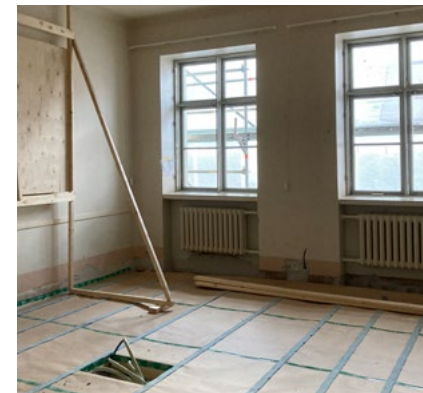
Välipohjan tiivistyspaperi toimistossa 313; 16.12.2021.
