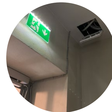
Sähköjohdon poistumistieportaikon ovesta ovirasiaan; 14.6.2022.
