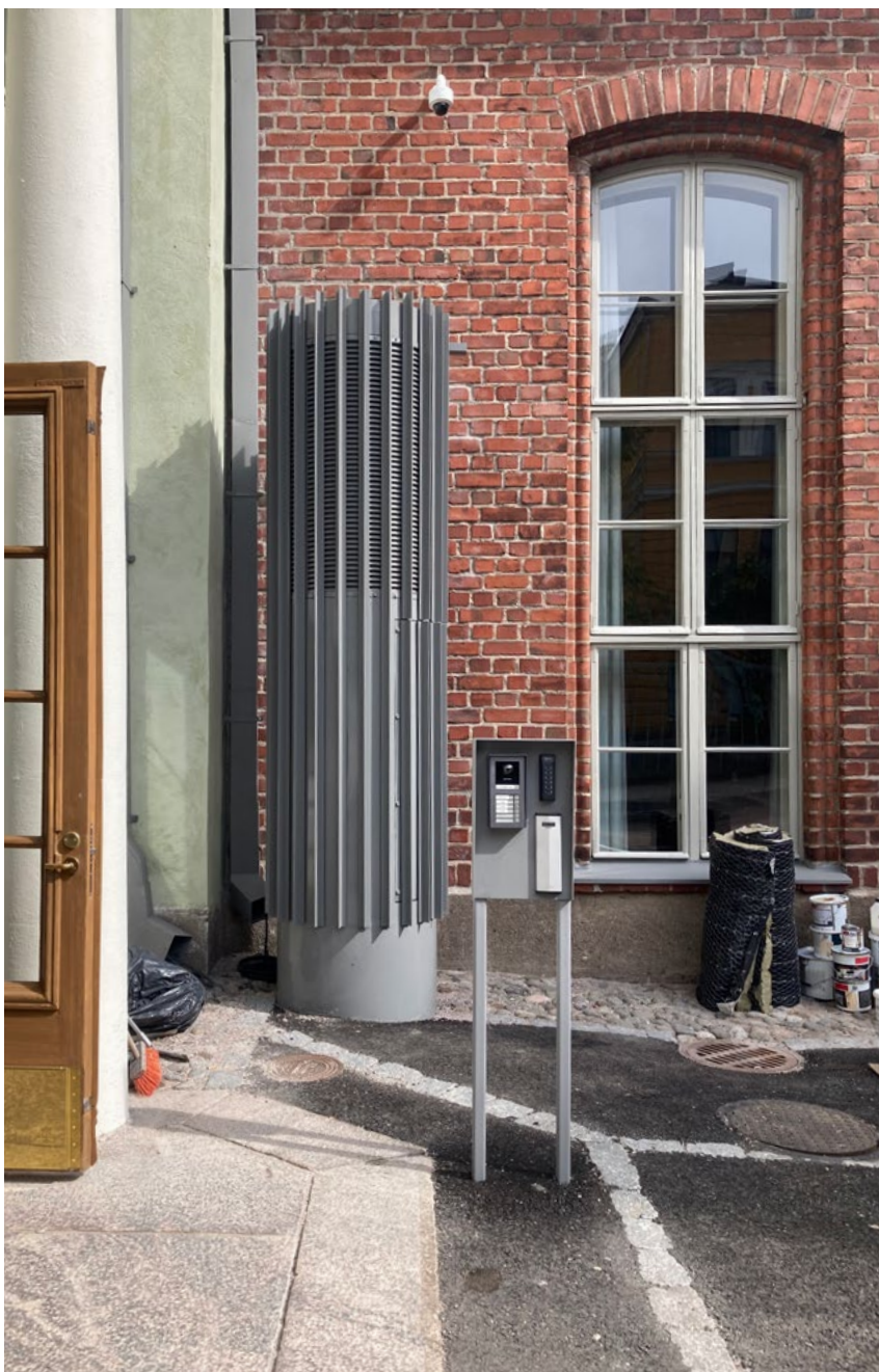
Uusi raitisilman sisäänottorakennelma pää- ja siipirakennusten nurkassa; 23.8.2022.
