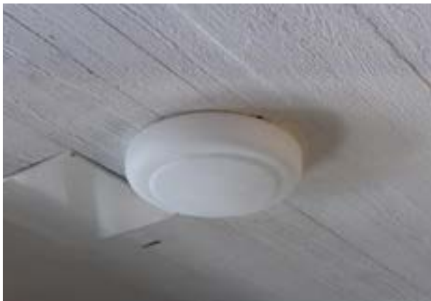
Huoneiden ja aulatilojen valaisimet ovat vähäeleisiä.
