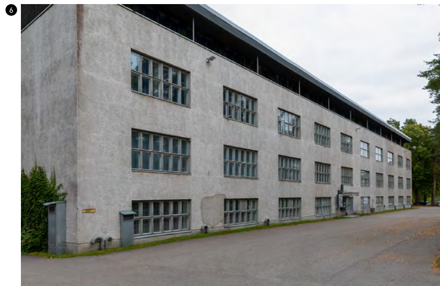
← Julkisivun terastirappaus on paikoin huonossa kunnossa. Rappauksen iästä ei ole varmuutta, mutta mikäli pinta ei ole osin alkuperäinen se on oletettavasti toteutettu alkuperäistä rappautta mukaillen.
