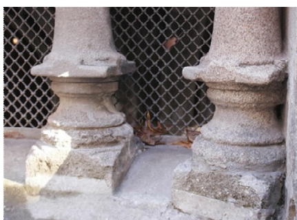
KUVA 3. Balustereiden ER-B1 ja ER-B2 äläpää.
