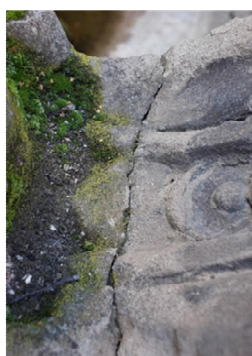
KUVA 4. Veistoksen ER-C1 halkeama kaulassa
