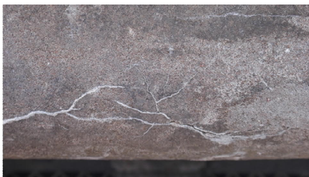
KUVA 1. Injektoidut halkeamat aukon yläpuolella.
