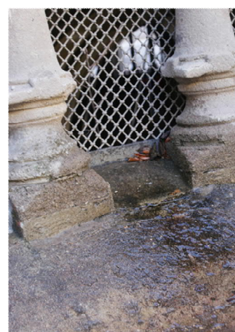
KUVA 5. Vesivaurion jäljet vesialtaan LR-A reunassa balusterin LR-B2 ja LR-B3 vieressä.
