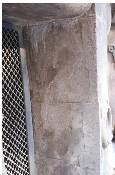
KUVA 5. Pilarin V16 halkeama.
