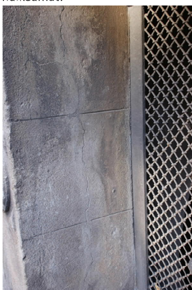
KUVA 4. Pilarin V2 halkeama.
