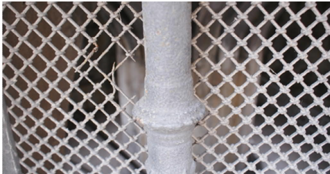
KUVA 4. Reikä aukon metalliverkossa.
