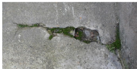
KUVA 4. Muuriseinän M lohkeama.
