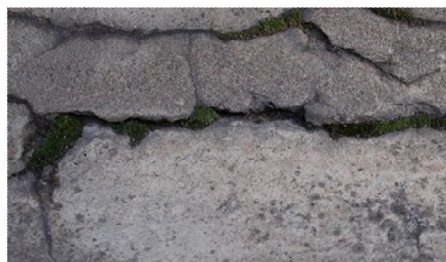
KUVA 5. Muuriseinän M halkeamat.
