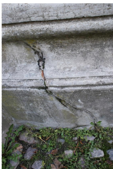
KUVA 3. Muuriseinän M halkeama.
