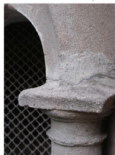
KUVA 7. Balusterin IR-DA yläpää.
