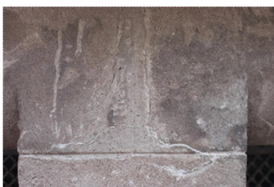
KUVA 3. Pilarin V1 yläpuolen halkeamat.
