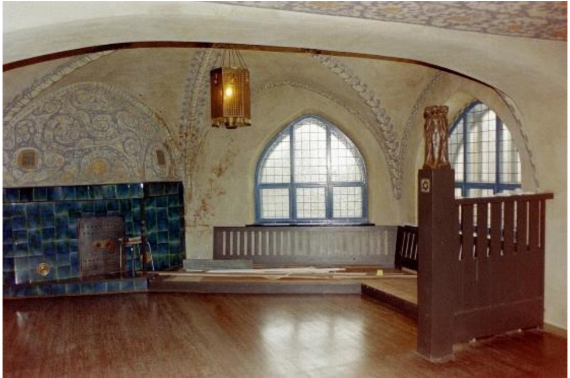
Kuva 22. Kuva on otettu 1990-luvun lopun restaurointitöiden aikaan. Takan kuvun oikeassa reunassa sekä seinässä näkyvät kosteusvauriojäljet. (Nors 1999.)
