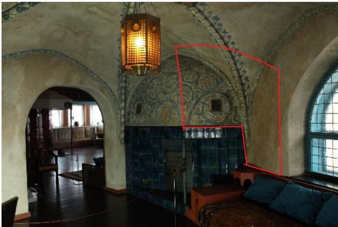
Kuva 62. Kuvaan merkitty vauriokartoitusalue, jonka keskellä näkyy tummia, ruskeita kosteusvauriojälkiä ja tummentumia (Määttä 2022)
