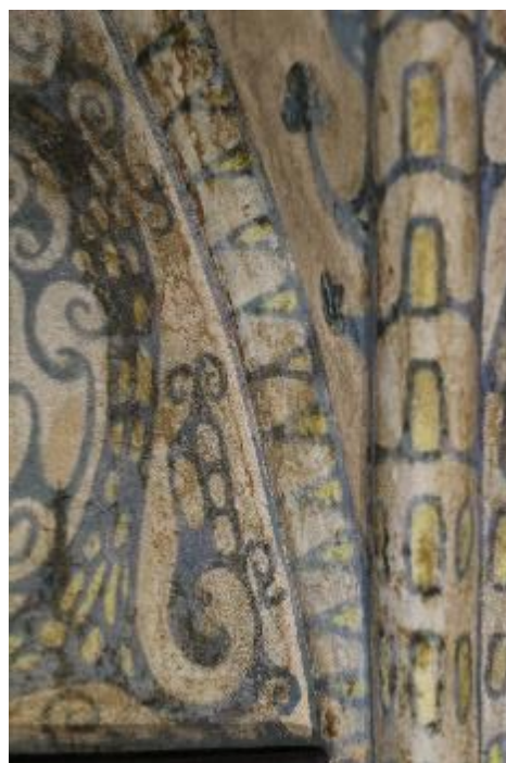
Kuva 64. Vesivauriosta aiheutuneita likajälkiä uunin kuvussa ja ruoteissa (Määttä 2022)
