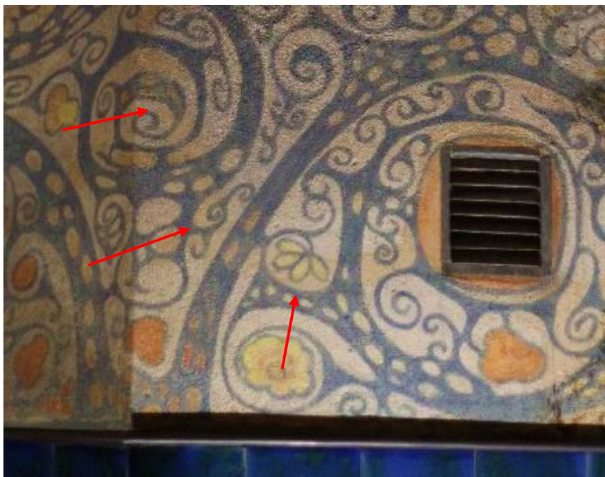
Kuva 65. Tuuletusaukon juuresta lähtee vanha korjattu halkeama, joka on retusoitu 70-luvulla myöhemmin tummentuneella beigenharmaalla maalilla (Määttä 2022).
