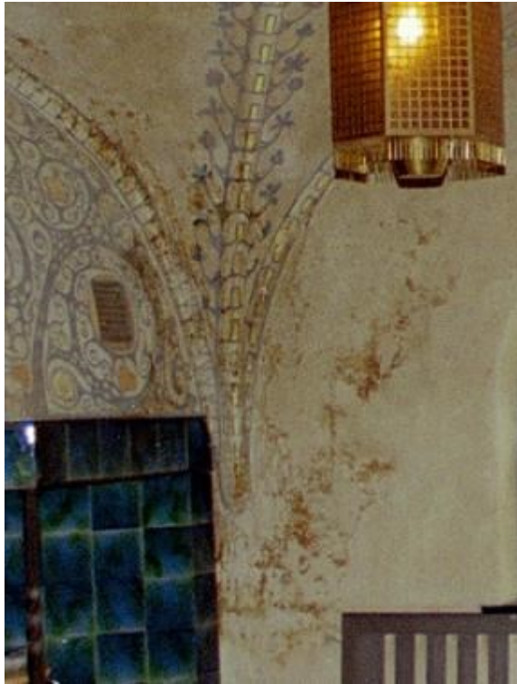
90-luvun peruskorjauksen aikainen vesivaurio.
