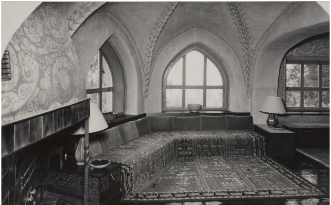
Kuva 20. Vuonna 1968 otetussa kuvassa näkyy ikkunoiden ja kaariaukon yläpuolella useita vaaleana näkyviä halkeamia. Myös takan kuvun alareunassa on tummentumaa. (Welin 1968.)
