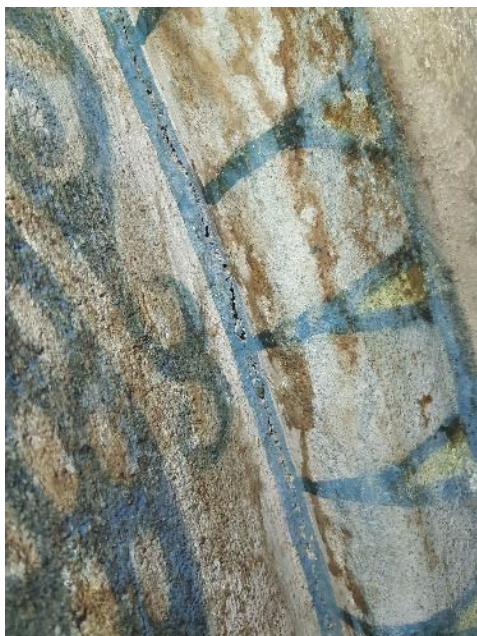
Kuva 66. Takan kuvun yläreunan ja ruoteen oikean reunan välissä oleva pitkä halkeama sekä vesivauriojälkiä ja vaaleata kalkkihärmää (Määttä 2022)
