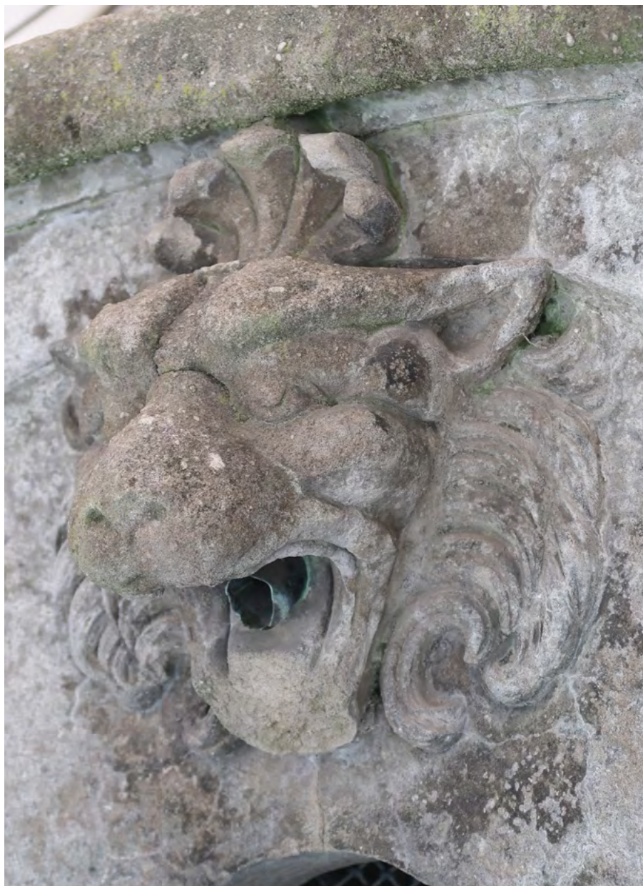
Alkuperäinen leijonapäävalos. Virtaavan veden ja pakkasen yhteistyönä kaikki suuret leijonat olivat menettäneet alaleukansa. Kuva ennen vuonna 2020 käynnistyneitä korjaustöitä. Kuva Okulus, KW.
