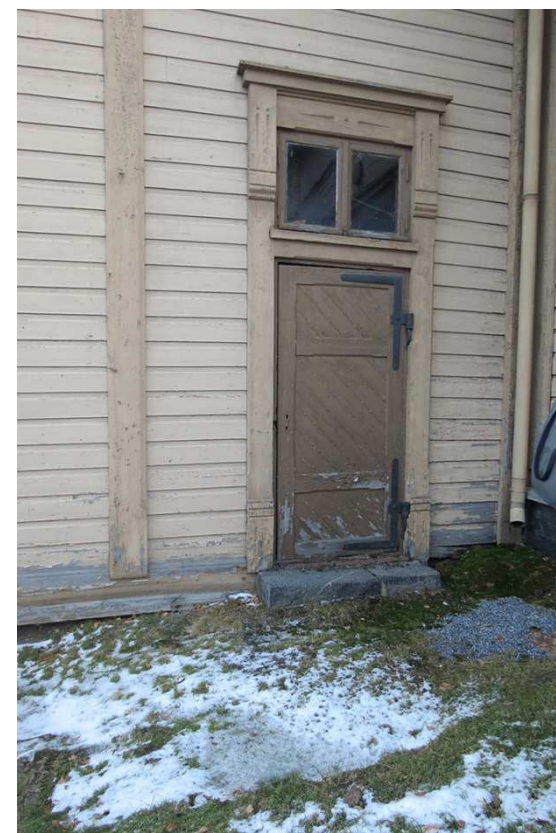
Kuva 193. Piharakennus, julkisivudetalji. Rakennuksen julkisivujen alimmat puuosat ovat pinnoiltaan vaurioituneet.
