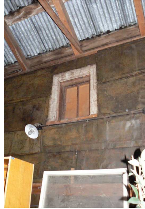
Kuva 200. Linnankadun puoleinen päätyhuone, joka on jossain vaiheessa toiminut autotallina, on sisäpinnoiltaan pellitetty.
