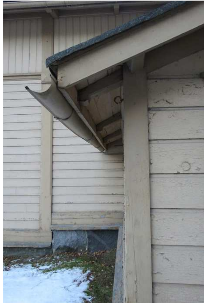
Kuva 189. Piharakennus, räystäskannattajien detailjointia kellarisäämäkäynnin katossa.
