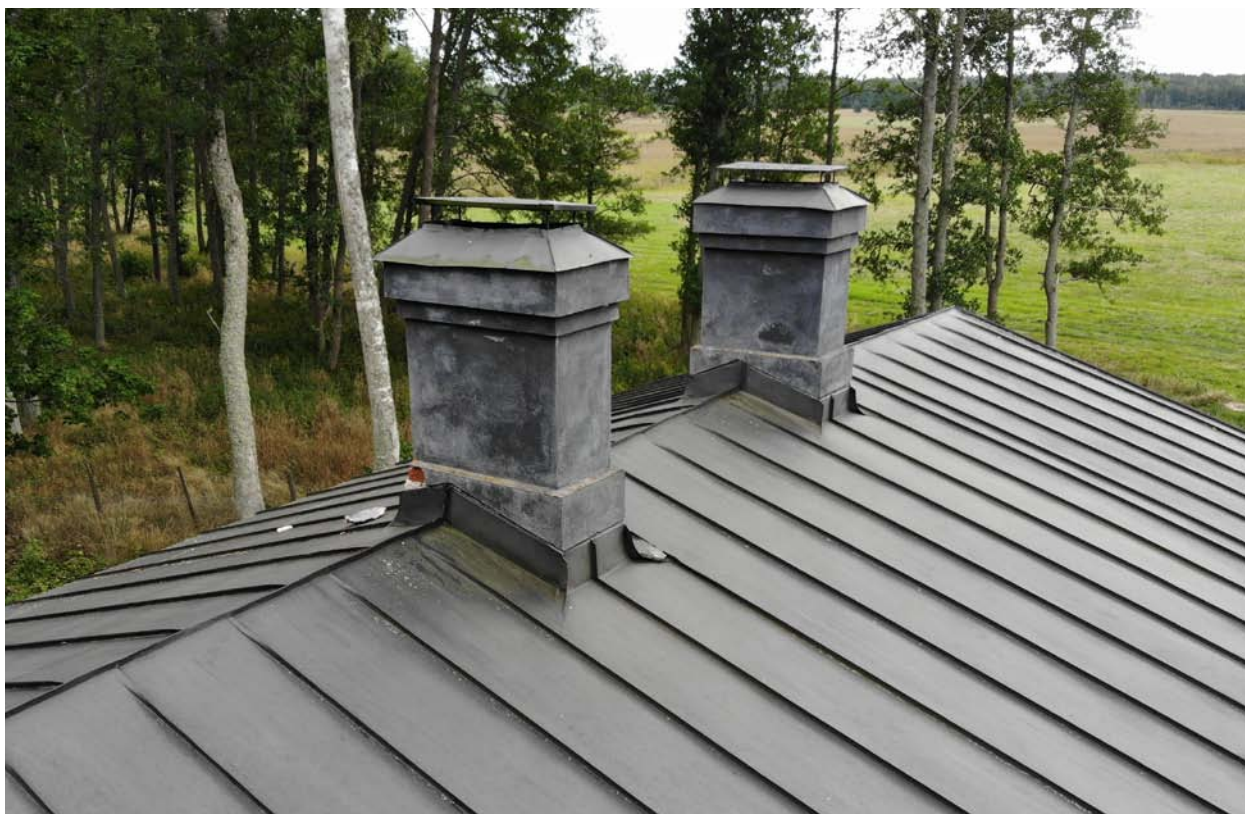
Putsen har delvis lossnat från skorstenarna. Livady.
