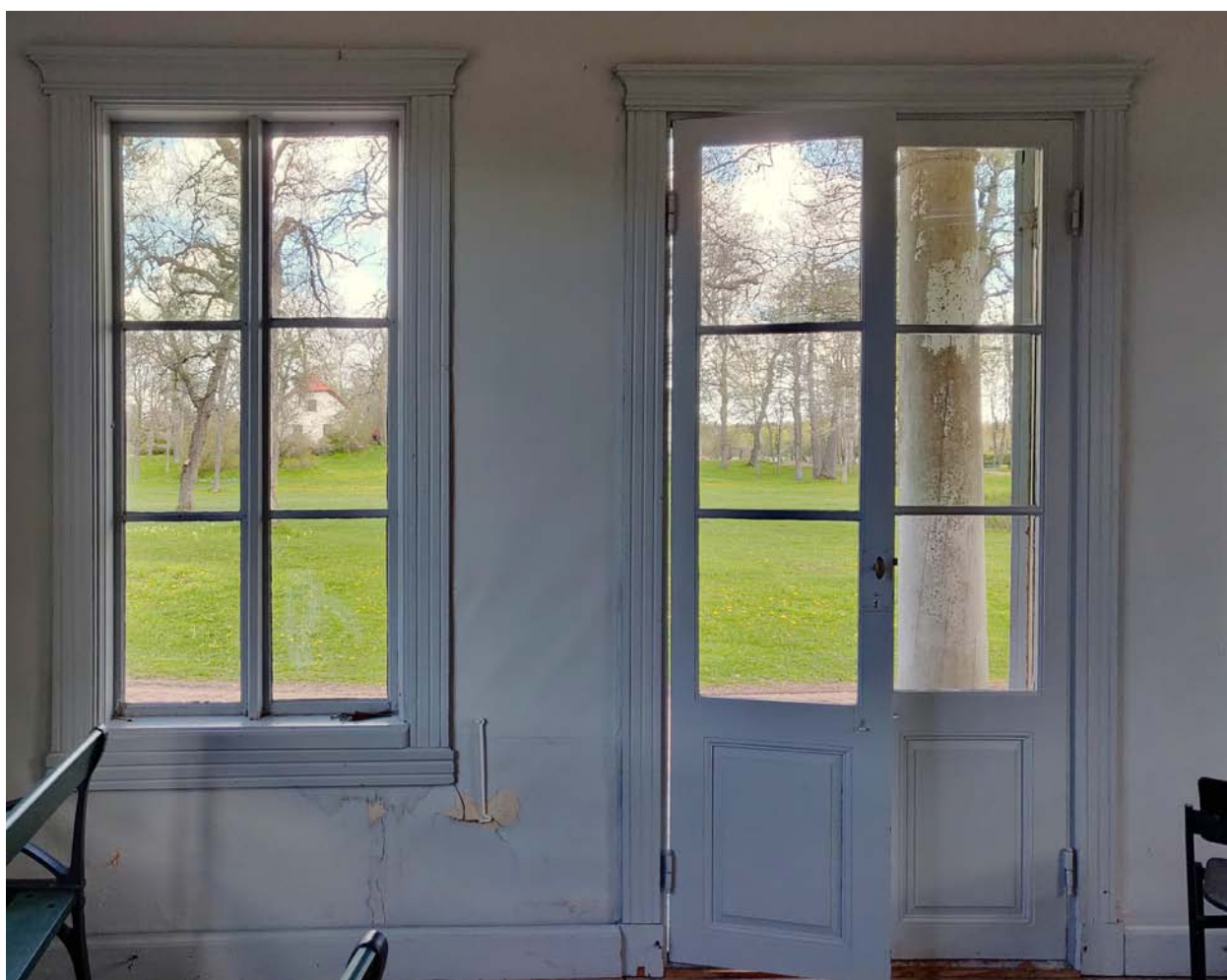
Nordöstra kortsidans ingång och fönster i maj 2020. Väggarnas spännpapp är ställvis i dåligt skick.
