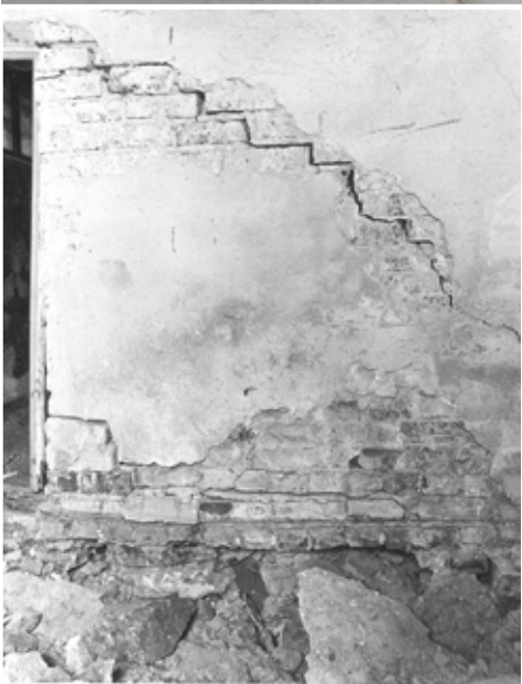
Piste 4. Kattova väliseinä muurattu kivilouheen päälle. Kivet auttavat periksi ja seinä painuu. Sen laastissa käytetty kalkkilaasti ei ole perustunut tiiliin ei seinä kanna sitä helvot itseään juuri ollenkaan.
