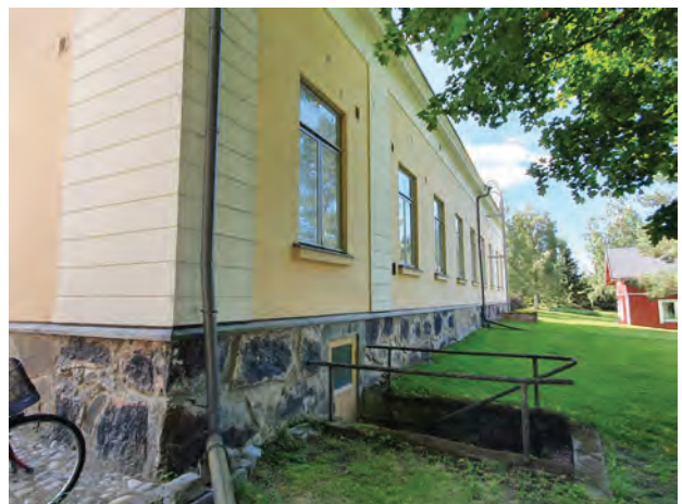
Kellariporaat pohjoisjulkisivussa. Kuva v.2020
