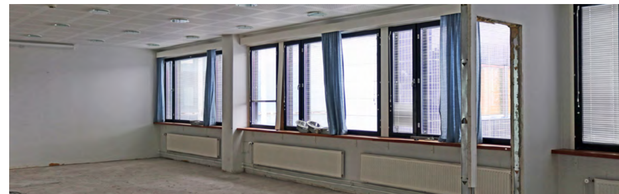
kuva 5.58 Oikeustalon viimeisimmässä laajennuksessa vuonna 2002 rakennettu pieni istuntosali 3. kerroksessa. Tilassa on purettu lattiapinta pois vesivahingon vuoksi.
