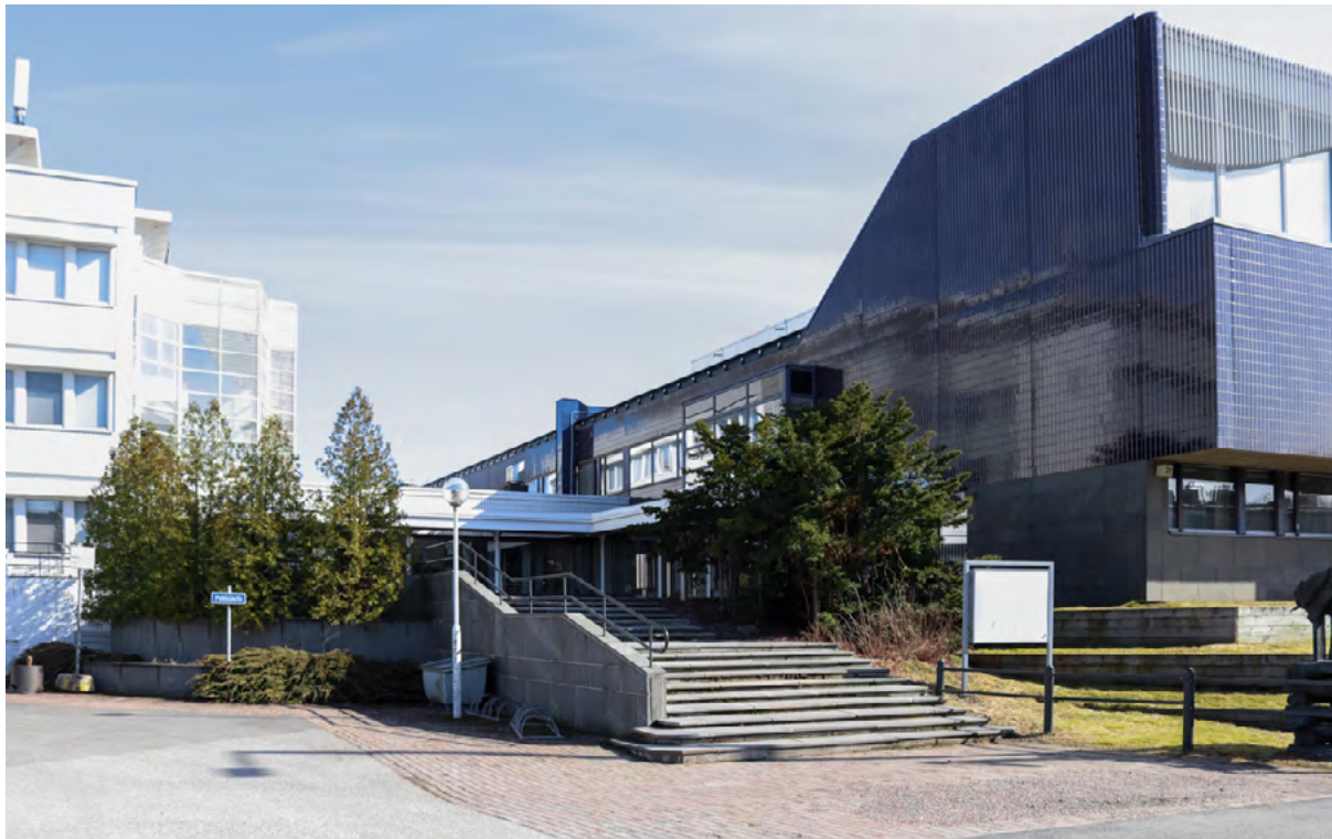
kuva 5.14 Oikeus- ja poliisitalon pääsisääkäyntitasanteelle johtavat portaat. Kasvillisuus on päässyt kasvamaan peittäväksi.
