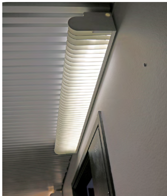
kuva 5.357 Poliisitalon käytävän alkuperäiset loisteputkivalaisimet ovat vielä käytössä.
