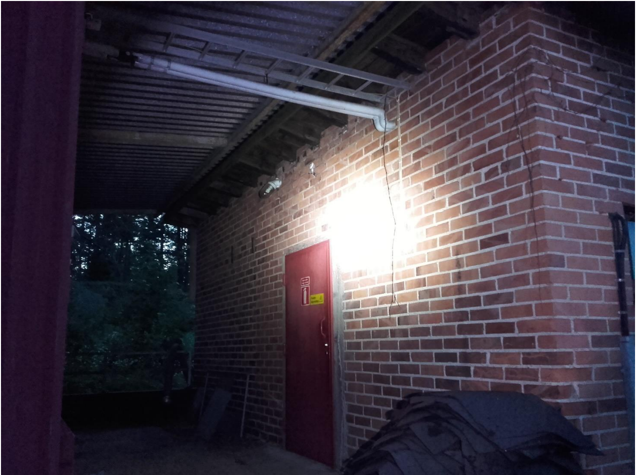
Kuva 7. Pohjanlepakoiden lisääntymispaikka lämpökeskuksessa. Lepakoiden kulkuaukot sijaitsevat kuvassa näkyvän oven yläpuolella katon rajassa.
