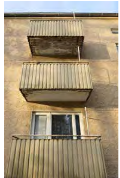
↑ Asunnoissa on pienet parvekkeet, jotka ovat jo melko huonossa kunnossa. Myös ikkunat ovat alkuperäiset.
