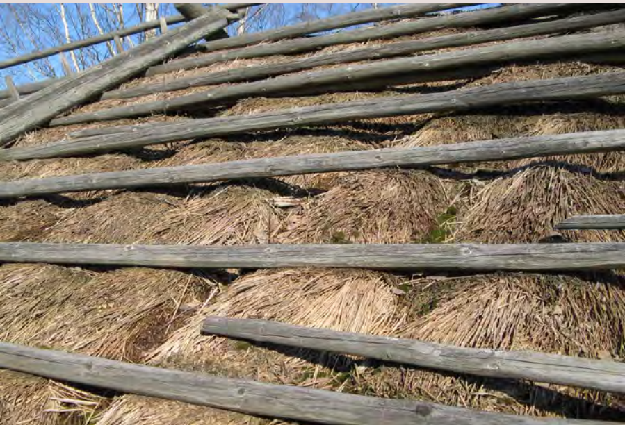
Vanhetessaan olkikatto painuu epätasaisesti ja alkaa vuotaa. Vesikate 27.3.2007. Eronen, MV REST.
