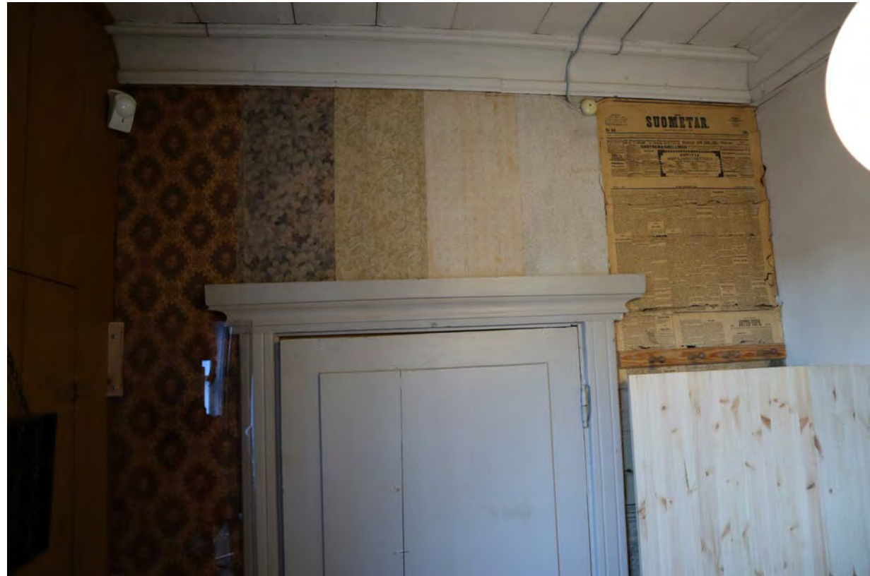
1970-luvun restauroinnissa poistettujen tapettikerrosten fragmentteja Erstuvan vastaisella seinällä
