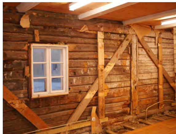
Marraskuussa 2017 navetan seinän sisäpinnan lautaverhous purettiin. Alta paljastuivat vuonna 1975 asennetut vinotuet, jotka oli kiilattu följareiden väliin. Vinotukien ja följareiden pinta oli veistetty tasaiseksi uutta lautapintaa varten. Arkkitehtitoimisto Hanna Lyytinen Oy 2017.
