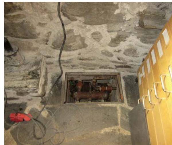
Kellarin E 101 jakotukki. Hannu Tuunanen 2015, Rejlers Oy.
