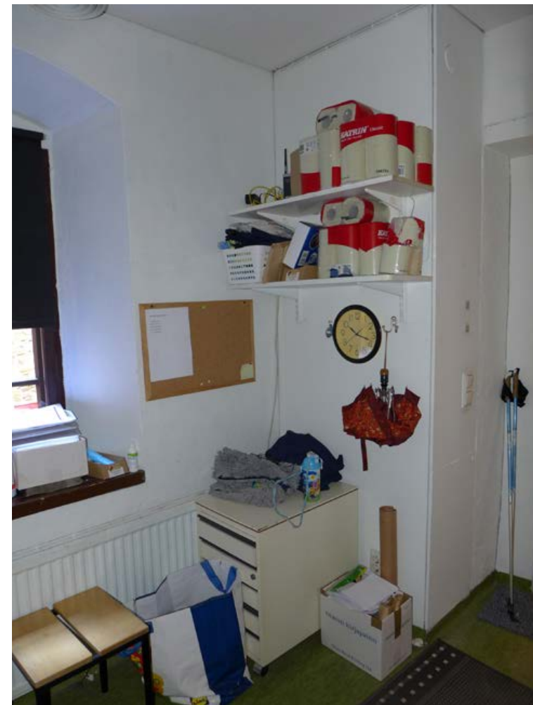
Kellarin H 102 lounaisseinän kotelossa kulkee lämpöputket. Päivi Hakanpää 2016, Arkkitehtitoimisto Hanna Lyytinen Oy.
