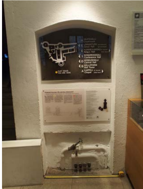
Huoneen H 201 pohjoisseinän komeroon asennettu jakotukki. Hanna Lyytinen 15.11.2016, Arkkitehtitoimisto Hanna Lyytinen Oy.
