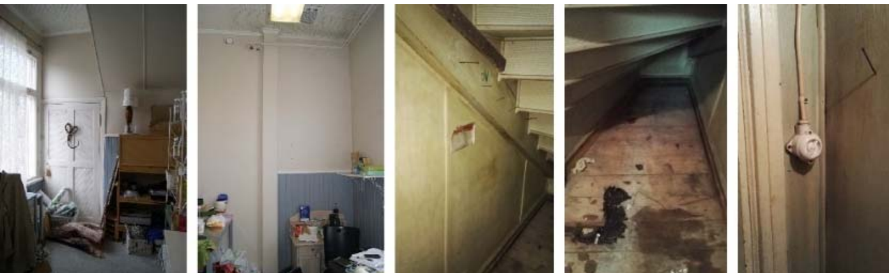
Kuvat vasemmalta oikealle. Pihan puoleista kapeaa keittiötilaa vasemmalla, jossa on rintapaneeli, levytetyt seinät, muovimatto sekä vanha ovi ullakolle. Ullakolle johtavien rappusten alla on kaappitila, jossa on 1950-luvun pintoja. Komero rappusten alla on maalattu vihertävän harmaaksi. Pintamateriaalit ja listat viittaavat 1940-50-luvulle.
