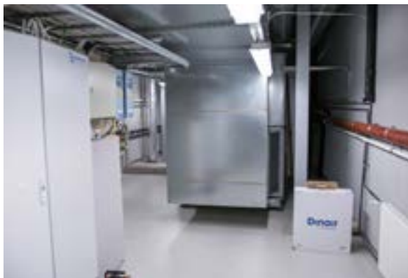
3301 Ilmanvaihtokonehuone C-siiven katolla
