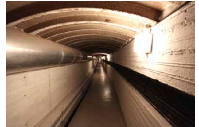
1930-luvulla rakennettu maanalainen yhdyskäytävä johtaa kasemateista (13) voima-aseman (11) tiloihin. Katossa näkyy kaarevia teräspalkkeja.
