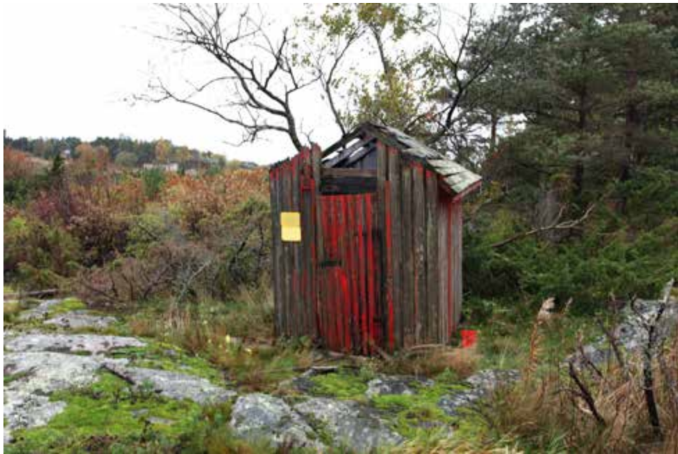
Kuva 26. Vaja on huonokuntoinen ja osa sen katosta on sortunut.
