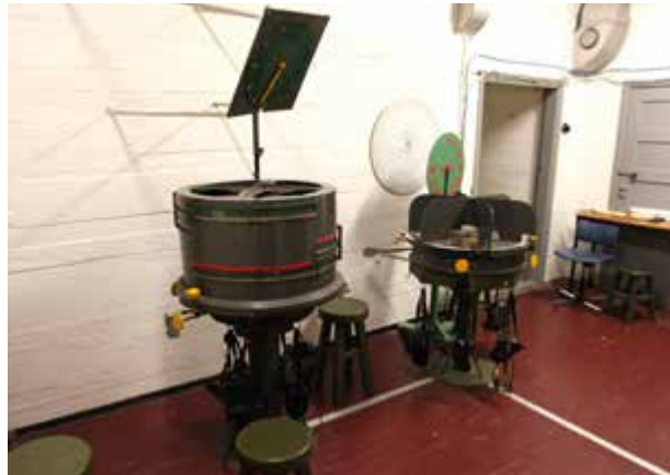
Kuivasaaren keskiön laitteita voima-asemassa (11).
