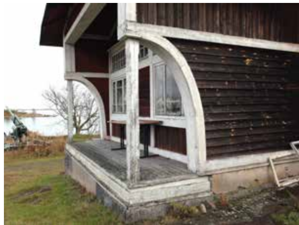
Ruokalan kuisti syksyllä 2017. Kuistin porras on purettu ja sokkelissa on tällä kohtaa betonia.
