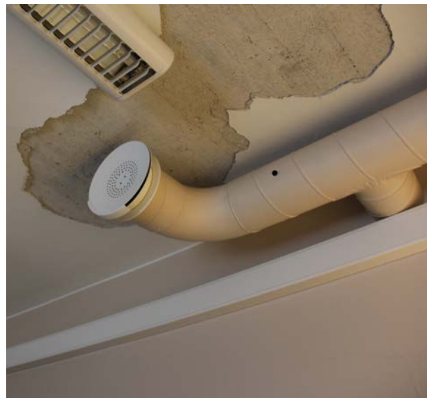
163. Asunto-osassa ilmanvaihtokanavat ovat pääosin koteloimattomina huonetilassa.
