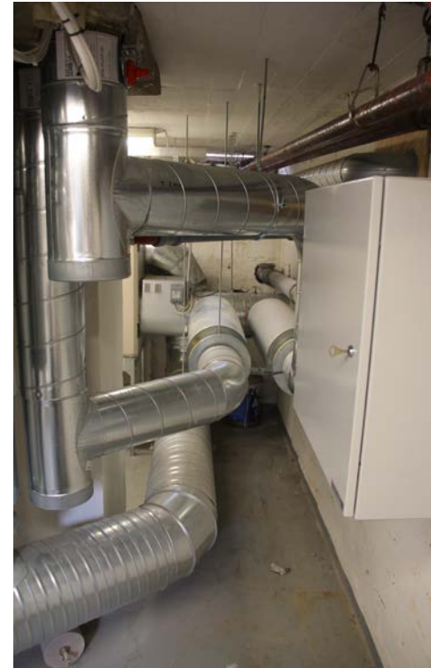
227. Ilmanvaihtokone täyttää lähes koko kellaritilan.
