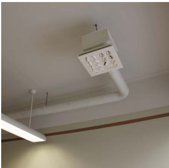
161. Vuonna 2006 ilmastointijärjestelmään tehdyt täydennykset jätettiin näkyville huonetilaan.
