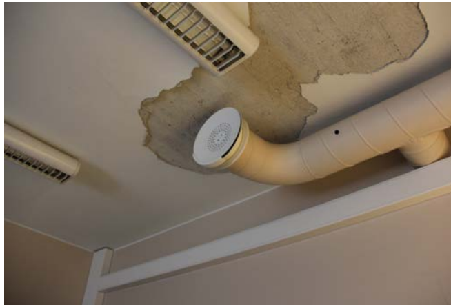
213. Sisäkaton rappaus on pudonnut ilmanvaihtoventtiilin kohdalla. Betoniväli-pohjassa näkyy lankkumuotin jättämät jäljet.
