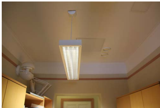
172. Talotekniikka on upotettu puurakenteeseen välipohjaan ja alas laskettuihin kattoihin.
