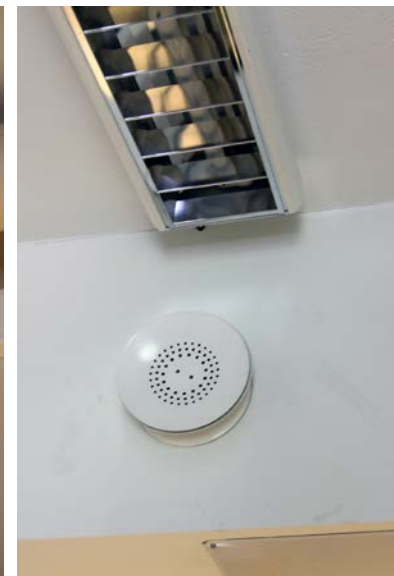
164. Asunto-osan alas laskettuun kattoon upotettu ilmanvaihtovalvonta.
