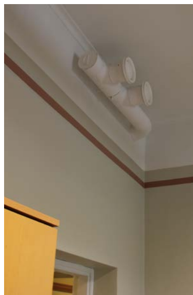
162. Uusi poistoilmakanava piiri-insinöörin huoneen nurkassa.
