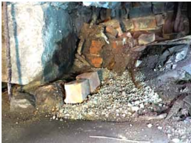
Kiukaan vasemman kyljen alaosan muuraus oli hajonnut, Rintalan arvion mukaan ilmeisesti siksi, että muuraus, joka oli hyvin kostea, oli toistuvasti jäänytynyt ja sulanut.
