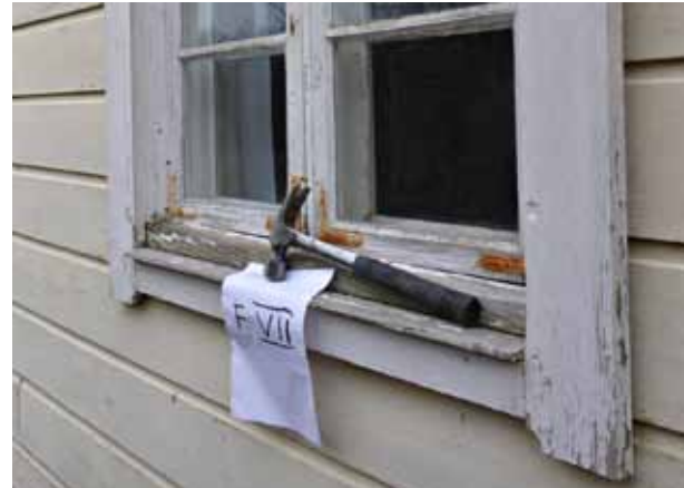
Kunnostamaton ikkuna ruostuneine kulmarautoineenvuonna 2017. Valkonen dokumentoi ikkunoiden sijainnit ja kunnon ja teki puitteet irrotettuaan taltalla sijaintimerkinnot roomalaisin numeroin yläpuitteen valssiin. Ikkunoista löytyi myös liijykynällä arabialaisin numeroin tehtyä numerointia, jonka logiikka suhteessa puitteen sijaintiin ei kuitenkaan auennut.
