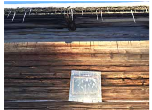
Ison riistaitan ikkunan lasiruutu on ulkopuolella naulojen varassa.
