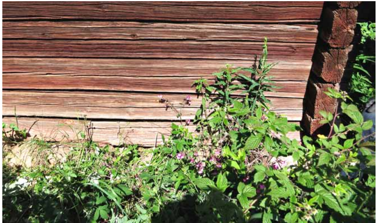
Kesällä 2018 havaittiin aitan kaakkoissurkan liikkuneen ja alimman hirren vaurioituneen.
