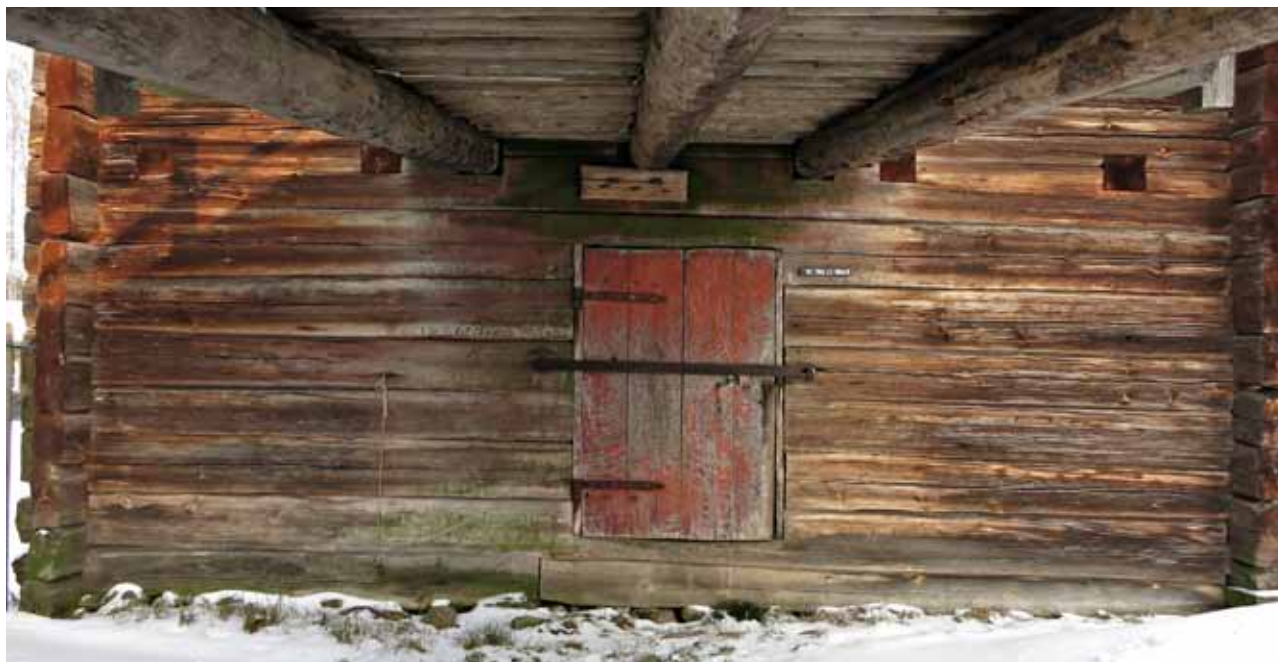
Hevostallin tallinovi sijaitsee ajosillan alla. Alinta hirttä on paikattu.
