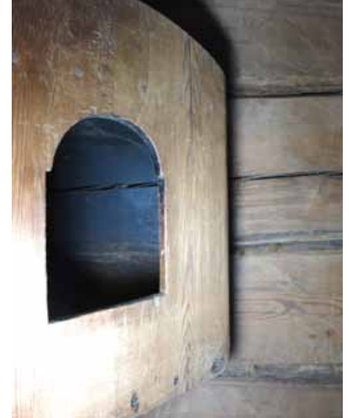
Kaappien sisällä näkyy noen mustuttamaa seinäpintaa, jota ei ole piiluttu puhtaaksi.
