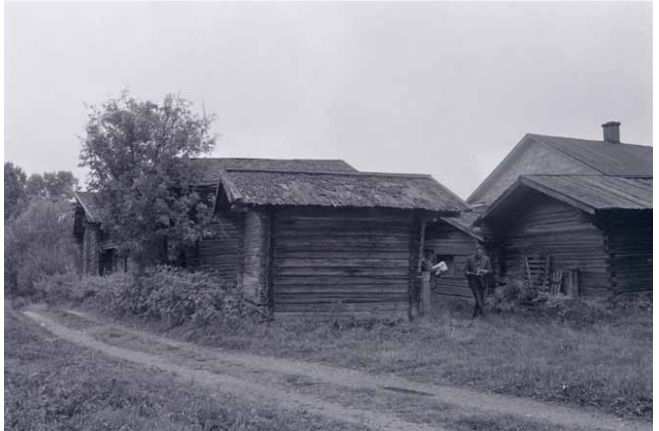
Suola-aitan pärekatto oli vuonna 1984 huonokuntoinen. Kuva: Matti Laamanen / MV RHO.
