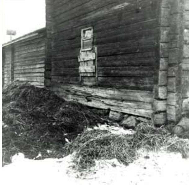
Takaseinän lantaluukun alla olevia lahoja hirsjiä 1980-luvun kuvassa. Kuva: MV RHO.
