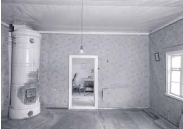
Takakammar kuvattuna vuonna 1989 kohti etukammarta. Katosta roikkuu hehkulamppu. Tapetti on vaurioitunut, pönttöuunin maali on lohkeillut. Kuvaaja: P. O. Welin / MV RHO.
