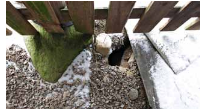
Säleaidan kohdalla on kaivo. Kaivon peittää puolittain vuonna 1986 sen kiviseinämien päälle asetettu kivi. Kuvassa näkyy oikealla reikä, joka on auennut kaivoon syksyllä 2017. Kuva on helmikuulta 2018.
