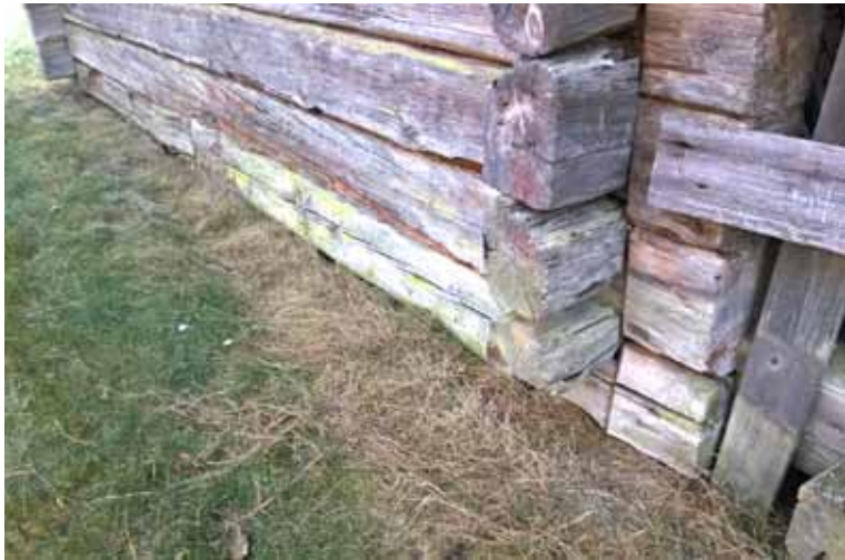
Pohjoisseinän alimpia hirsä peittää levä. Kuva on vuodelta 2014.
