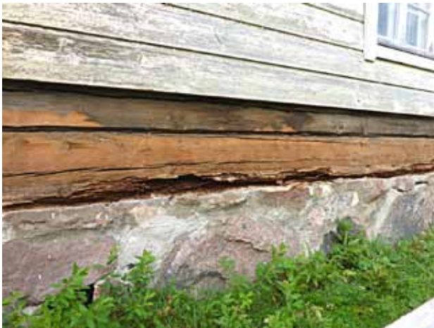
Aluksi näytti siltä, että päätyseinän alimman hirren alaosa olisi vain vaurioitunut kivijalan päältä valuneesta vedestä.
