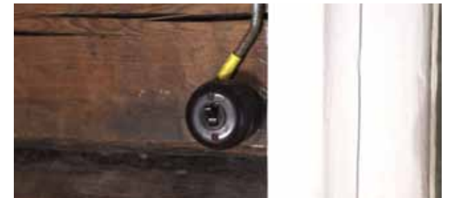
Tuvan vastaisen seinän valokatkaisin on 1940–1950-lukujen taitteesta, jolloin päärakennukseen vedettiin sähköt.
