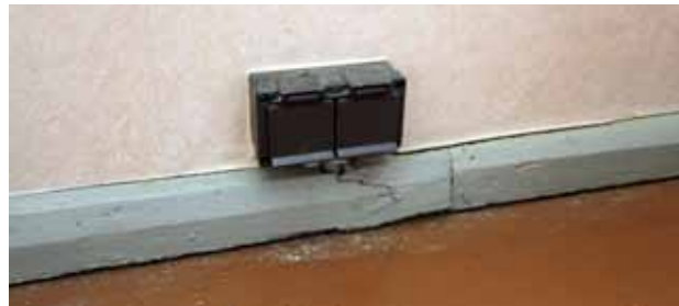
Selcast-merkkiset alumiiniset pistorasiat on asennettu vuonna 1987. Lattialistat ovat puisia ja maalattuja sekä yläreunastaan viistottuja.
