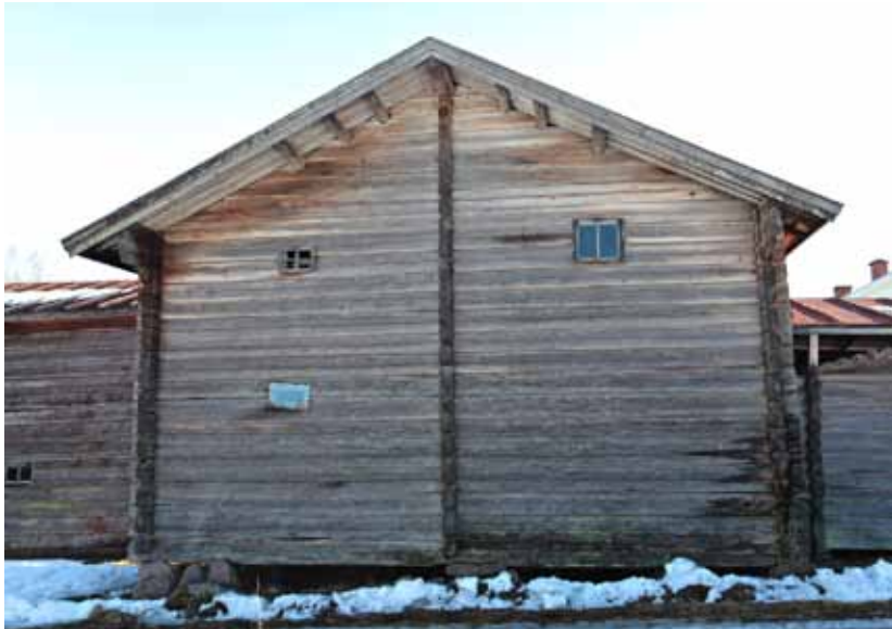
Korkian aitan ensimmäisen kerroksen renkien aitan takaseinässä näkyy vaurioita. Kuva on maaliskuulta 2015.
