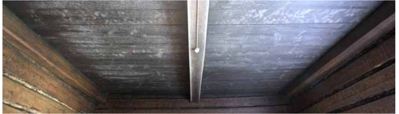
Kyökin lautakatossa on kolme välipohjapalkkia. Vuonna 1997 kattoa on korjattu vintiltä valuneen veden vuoksi.
