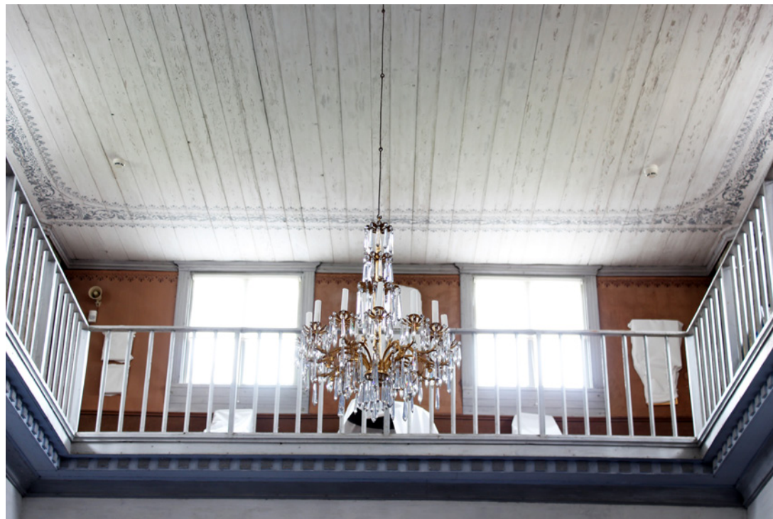
Liimamaalipinta hilseili koko kattopinnalla. Kuva: Kollaasi.
