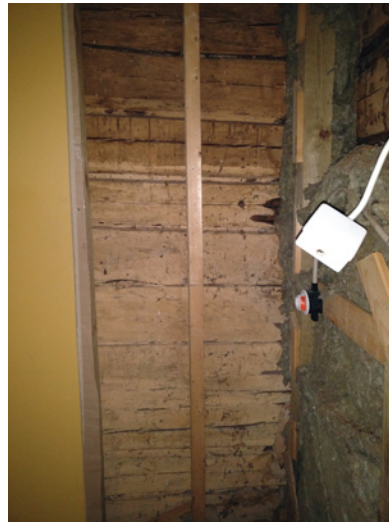
Keittiön (H7) ja kamarin (H8) välisessä seinässä ei ollut villaa. Kuva: Culturelli.
