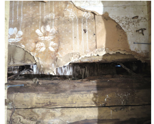
Avohyllyjen takaa eristeiden alta paljastui jäämiä vanhoista tapeteista sekä erittäin huonokuntoista hirsiseinää.
