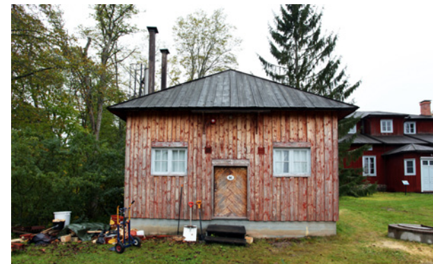
Huoltorakennus odottaa uudelleenmaalausta.
