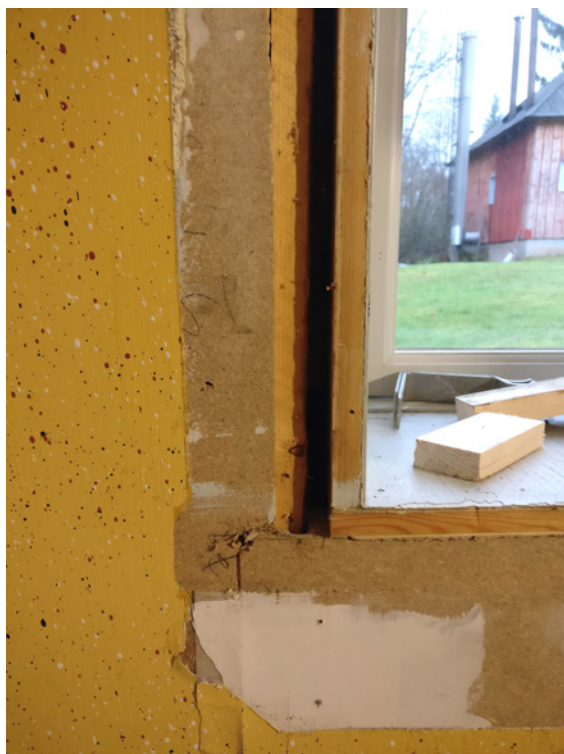
Ikkunasmyygit ja -penkit oli tehty kimpilevystä. Ikkunapenkit olivat huonokuntoiset kaikkialla talossa. Kuva: Culturelli.
