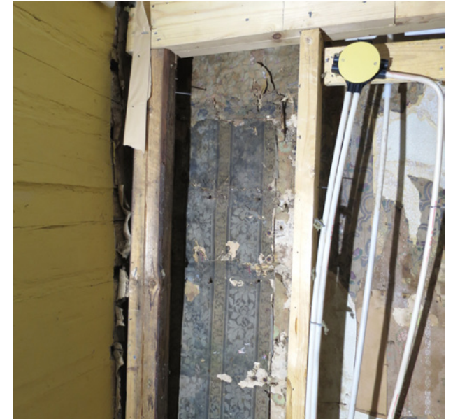
Purkutöyt paljastivat salin ulkoseinissä tapettifragmentteja.
