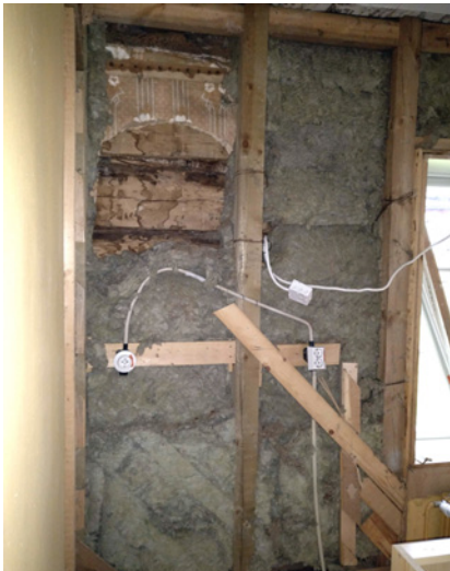
Muun muassa keittiön ulkoseinissä oli käytetty painekyllästettyjä tolppia. Tapettifragmentin alapuolella näkyy lahovaurio. Kuva: Culturelli.
