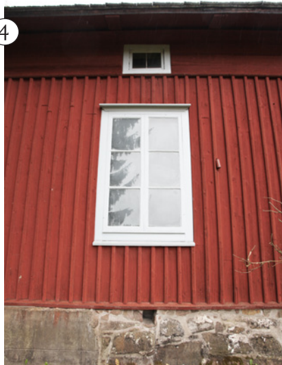
4. Eteläisimmässä valeikkunassa ei ole kulmarautoja. Muissa ikkunoissa kulmaraudat ovat tyyppiä A (s. 37).
