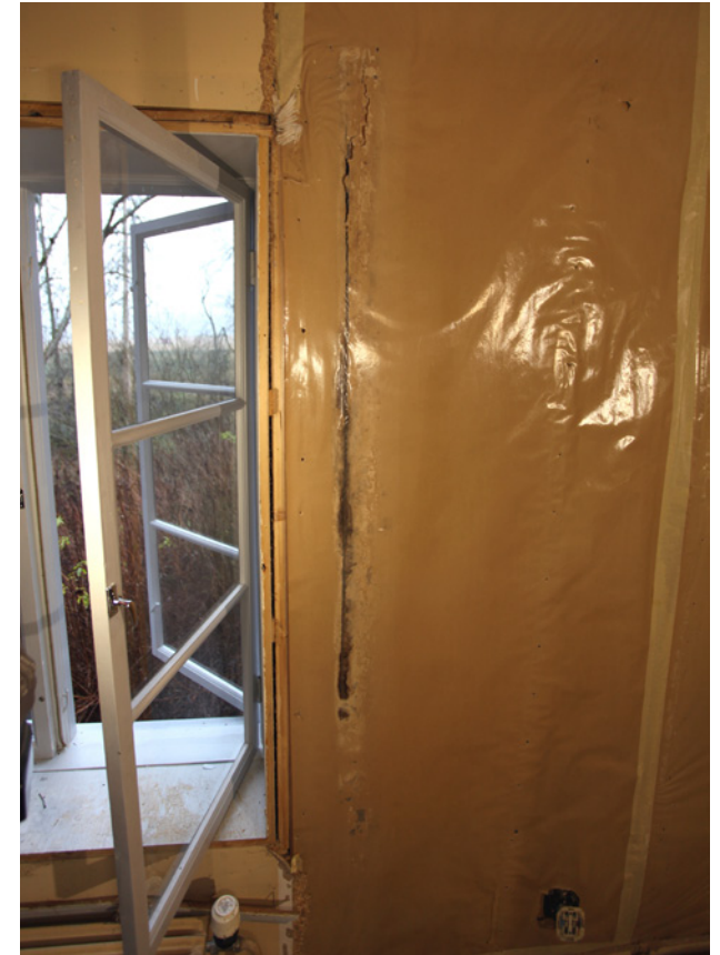
Purettujen lastulevyjen alla oli muovitettu paperi, joka oli homehtunut ja syöpynyt pois tolppien kohdalta. Itse tolpat eivät olleet homeessa.
