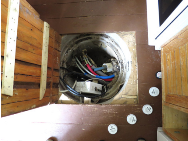
Keittiön lattiassa on luukku talotekniikkakaivoon.
