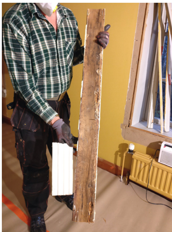
Ikkunalistojen taustapuolella oli hometta ja vanhoja lahovaurioita. Kuva: Culturelli.
