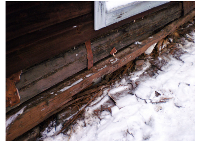
Lahovaurioita alimmissa hirsissä.
