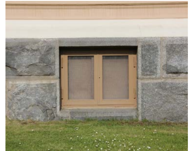
206. Arkiston ikkunat on muurattu umpeen sisäpuolelta. Yksi ikkuna toimii varatienä.
