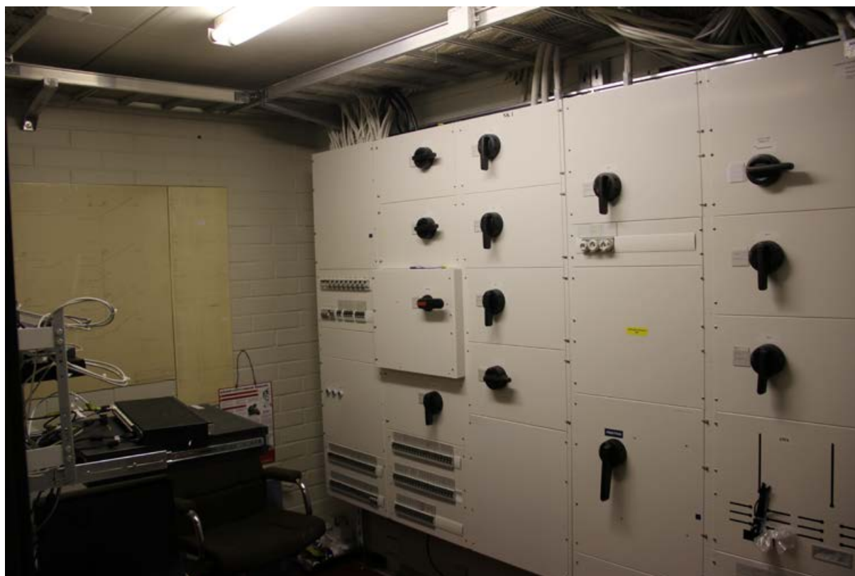
407. Sähköpääkeskus. Rakennuksen molemmissa kerroksissa on kaksi alakeskusta.
