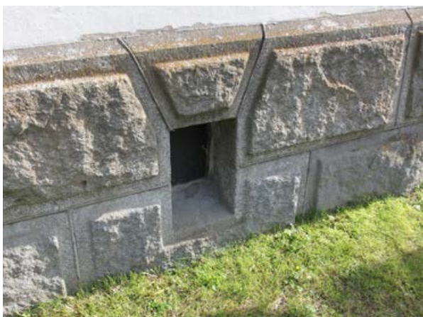
175. Perustuksen lohkokivien tasaiseksi hiotut reunat antavat vaikutelman leveästä saumasta. Muuraus on tehty ohuella pyörösaumalla.
