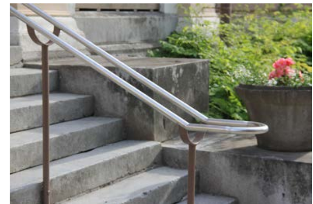
187. Pääporras ja sen vapaasti seisova kaide. Maalattuun runkoon on tehty uusi käsijohde ruostumattomasta teräksestä.
