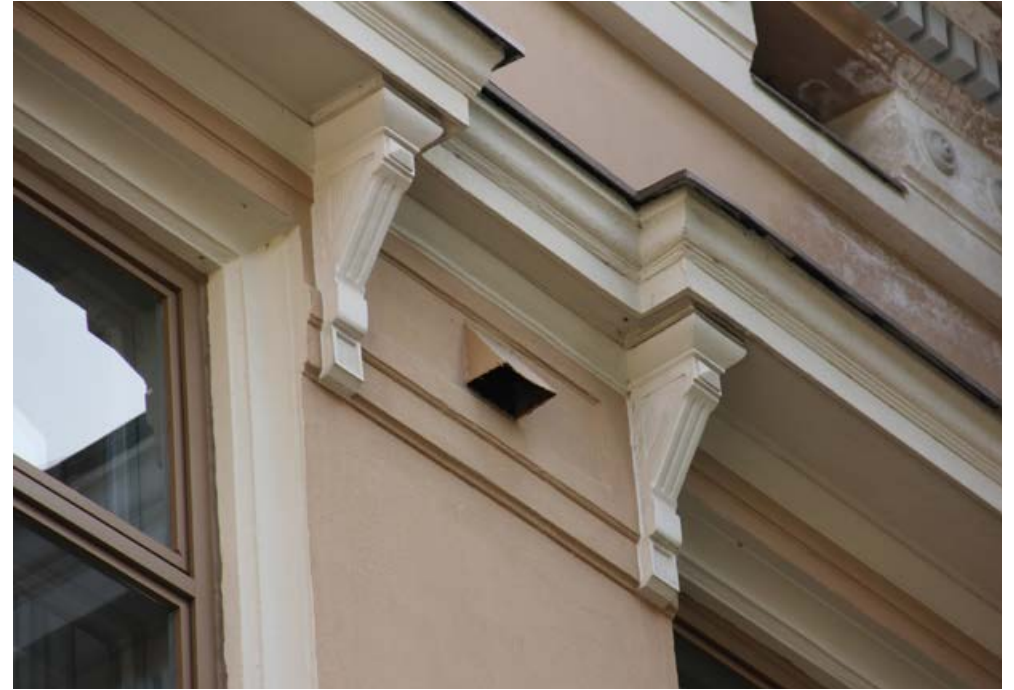
181. Ikkunoiden yläpuolella on konsolien kannattamat frontonit. Ikkunoiden välissä on alkuperäisen muotoinen metallinen korvausilmaventtiili.
