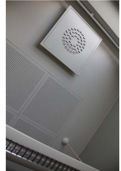
385. Alakatot on alaslaskettu ja akustoitu. Kataonyläpuolelle on sijoitettu ilmastointi- ja sähkötekniikkaa.
