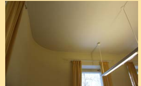
244. Tasoitettu levykatto tilassa 111
