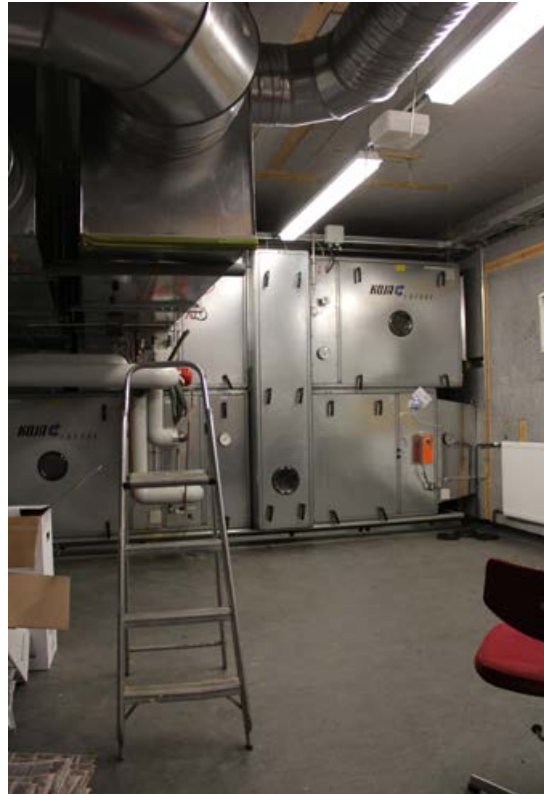
417. Toinen kahdesta ilmanvaihtokoneesta. Koneet on sijoitettu lämpimiin tekniikkahuoneisiin.
