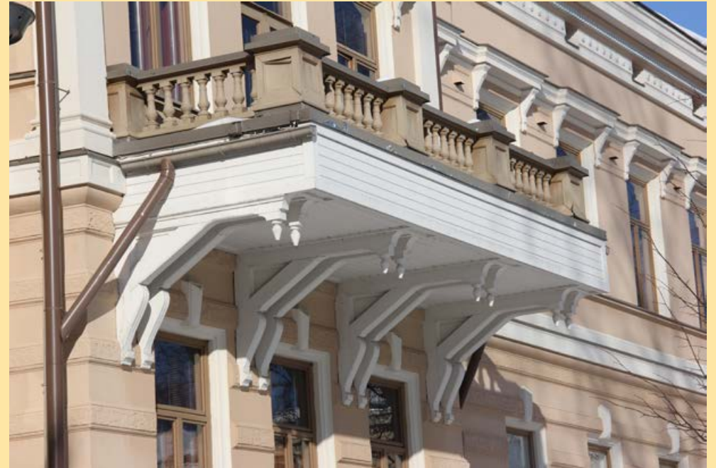
201. Parvekkeen alapintaan rakennettu laatikkomainen kotelo poikkeaa alkuperäisestä muodosta. Sen avulla on estetty kylmäsilän muodostuminen parvekkeen ja huonetilan välille. Myös konsolien muoto poikkeaa alkuperäisestä.
