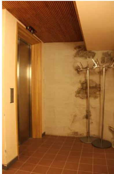
342. Hissin sisäänkäynti kellaritasolla. 1930-luvun alussa naulakoiden paikalla on sijainnut porras ensimmäiseen kerrokseen.
