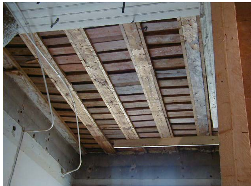
138. Notkahtanut välipohja ensimmäisestä kerroksesta nähtynä. KUVA: Kuopion lääninhallituksen arkisto, Ulla Hiltunen
