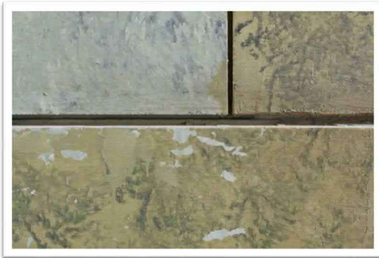
Eteishallin seinää: vasemmassa yläkulmassa näkyvässä alkuperäinen maalipinta. Alarivin laatoissa irronnutta maalipintaa ja retusointia.
