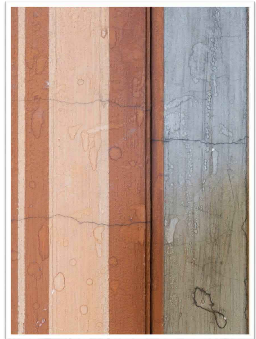
Tyypillinen esimerkki kenttämaalauksissa näkyvistä vesivaurioista.
