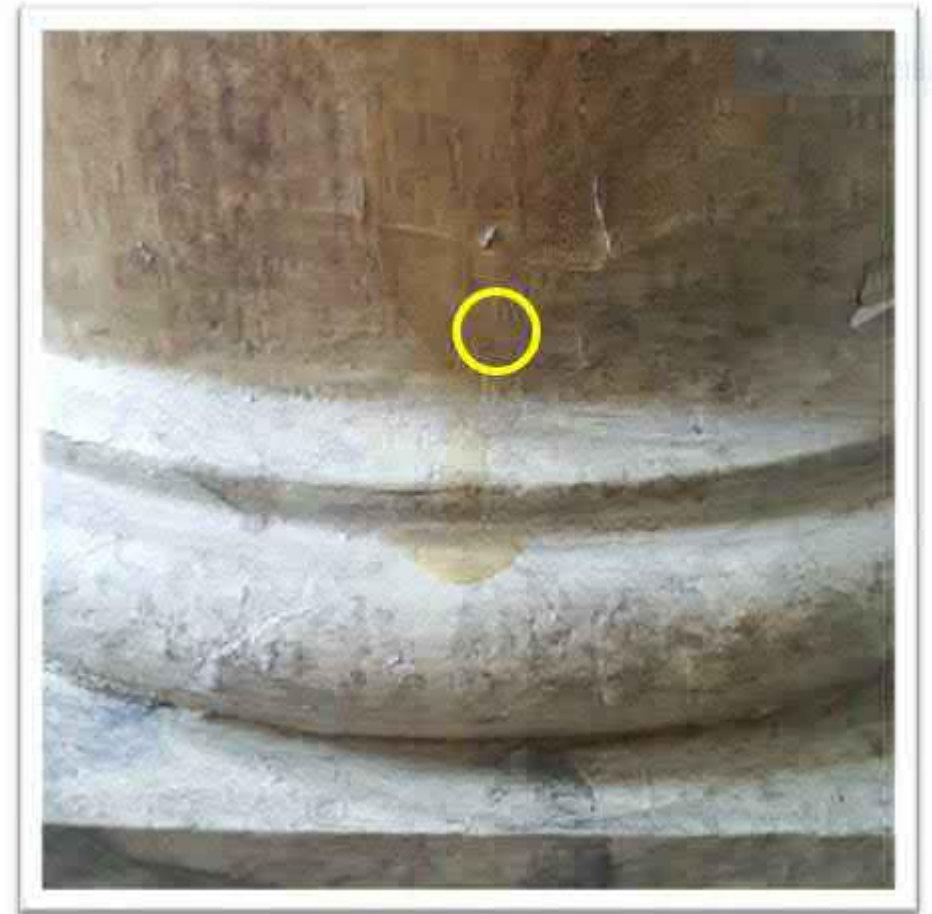
Pylvään juurella on nähtävissä myös pintakäsittelyaineen selkeä valumajälki.
