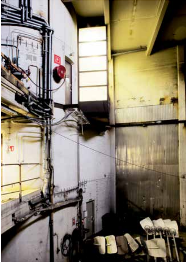
Kattilahuone 2. tasolta kuvattuna. Valvomon teräslasiseinä tulee tilaan ulokkeena.
