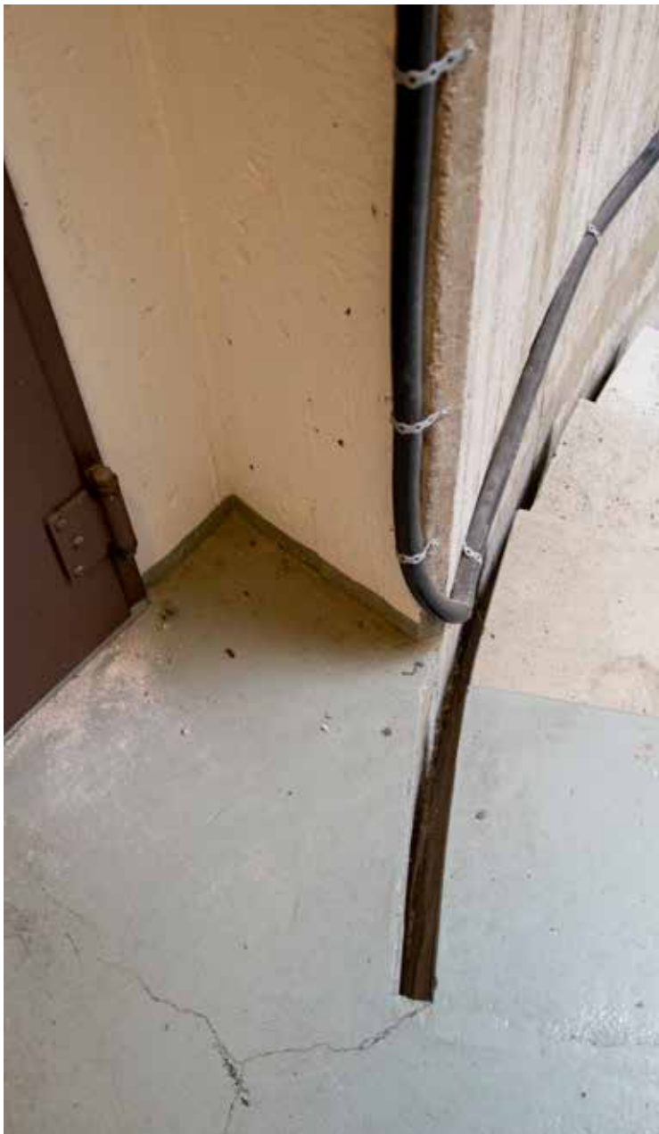
Portaan askelmat ovat irti seinärakenteesta.
