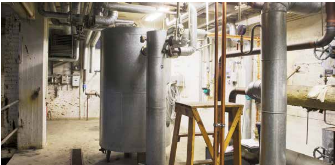
Kattilahuoneen 2. kerroksen tekninen tila.
