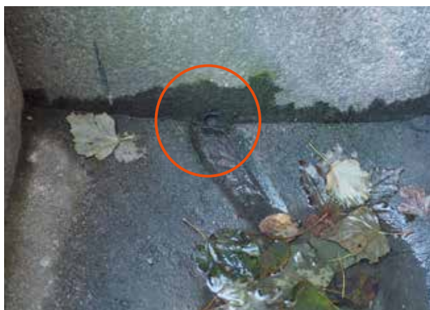
↑ Syvennyksissä on jonkinlaiset poistoputket, mutta ei ole selvää, minne veden on niistä tarkoitus ohjautua. Veden kertymisen perusteella vedenohjaus ei toimi. amoy 2017
