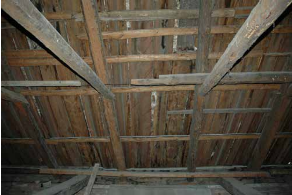
Lautakatetta ullakolla ennen korjaustöiden aloittamista kesällä 2016
