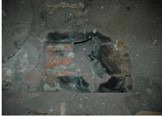
Kuvassa näkyy palaneita kattopalkkien päällä olevia lankkuja.
