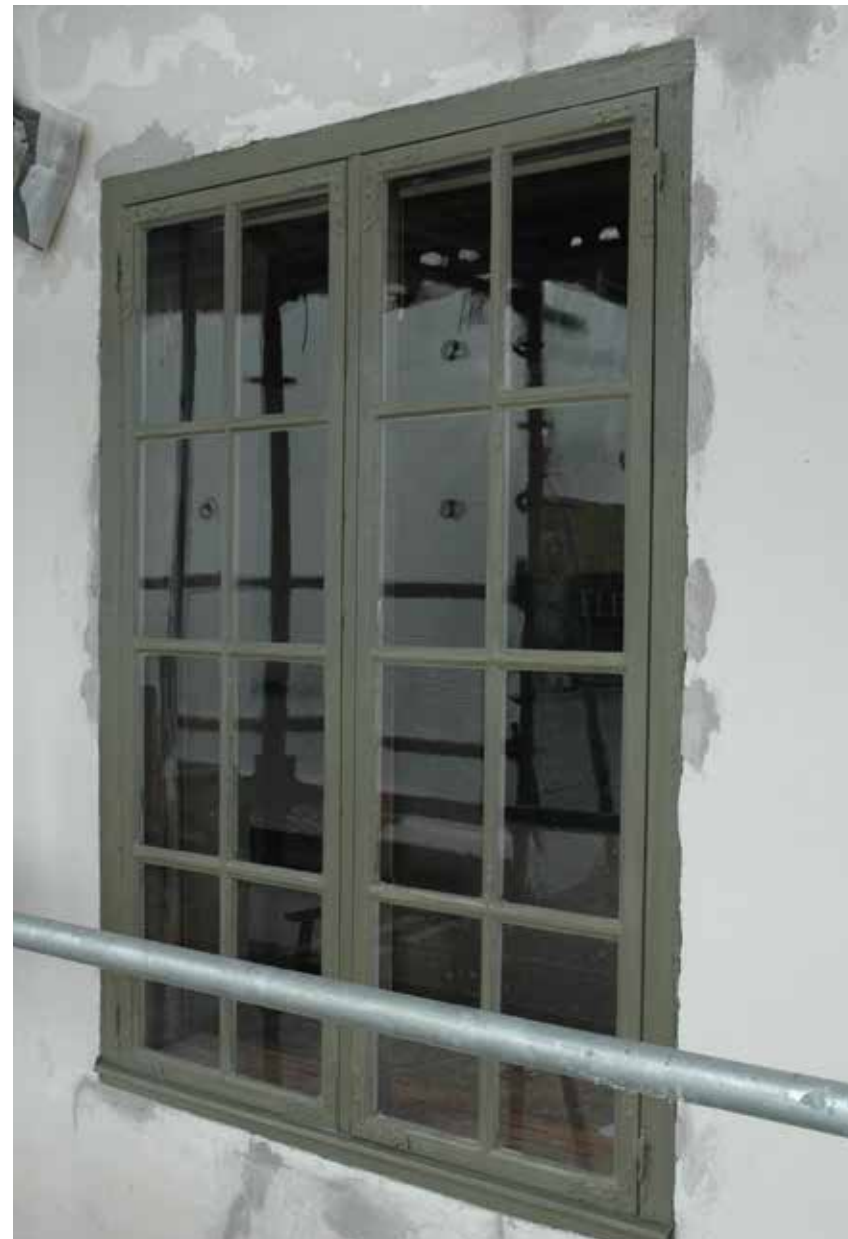
Värisävy korjaustyön 2017 jälkeen. Pintamaali NCS S 5010-G70Y ja pintamaalin päälle tehty kuullotus sävyä NCS S 6010-G70Y sekä maamustaa pigmenttiä.
