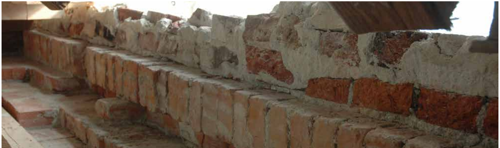
Laasti vaikuttaa samanlaiselta kaikilla puretuilla alueilla. 1960-luvulla on muurattu ulkopuolelta osa ylintä tiilikerrosta, ja siinä erottuu 1960-luvun kalkkisementtilaasti voimakkaan valkoisena.
