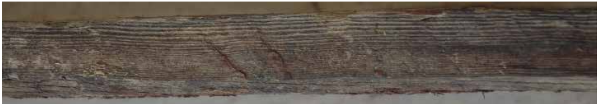
Osa kattolautoista oli vajaakanttisia. Kaikki tutkitut kattolaudat ovat tuppeensahattuja ja reunat veistettyjä. Kuvassa alla näkyy laudan reunan veistojäljet ja vajaakantisuus.
