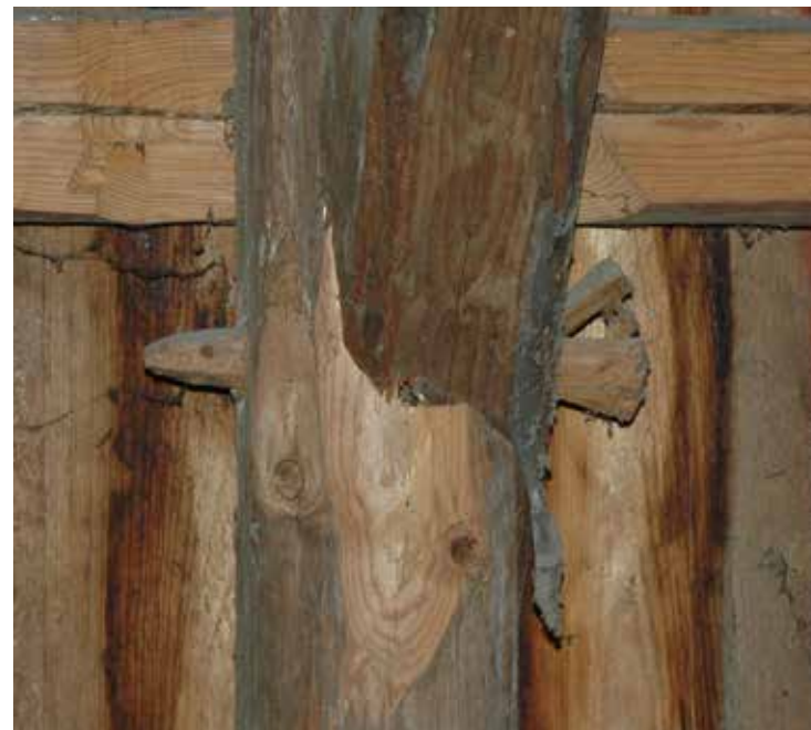
Ylemmässä kuvassa kattotuolin 4 harjaliitos. Kuvassa alla kanta on säilytetty.
