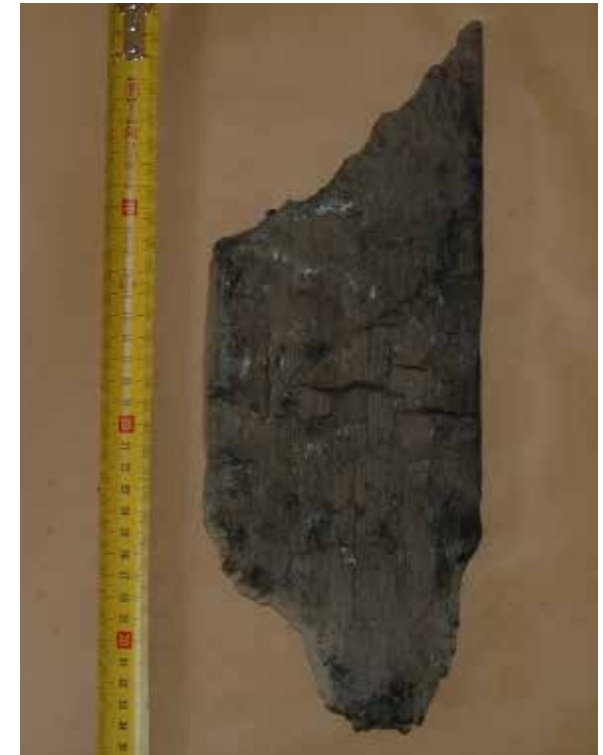
Eristeitä auki kaivettaessa isomman piipun kaakkoispuolella oli aukko rakenteessa ja eristeiden alla reiän kupeessa osittain palanut paanu.
