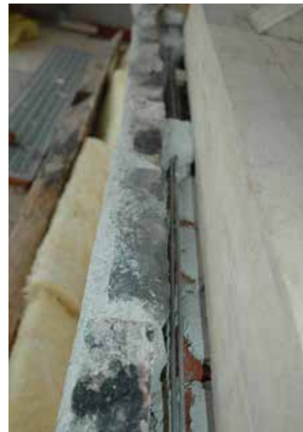
Muuri on yläosastaan liikkunut ulospäin, ilmeisesti kattorakenteiden liikkumisen voimasta. Takalappeella asennettiin harjaterästä laastin joukkoon tukemaan muuria, mutta se jätettiin muualta muurista pois.
