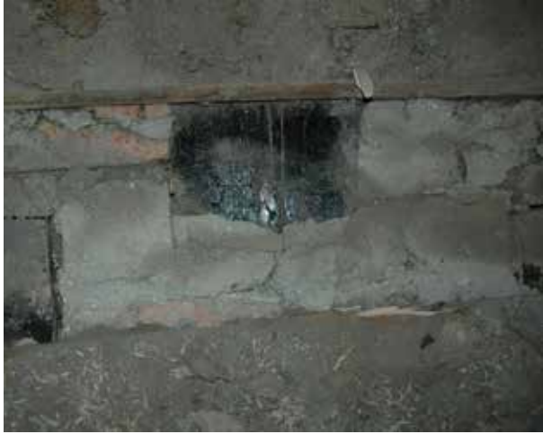
Eristeiden alta löytyi palanutta välipohjapalkkia
