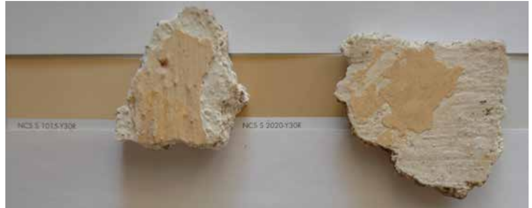
Päädyn vinojen alusautojen alta paljastui kellertäväksi maalattu rappaus, joka on 1960-luvun korjausta vanhempaa pintaa
