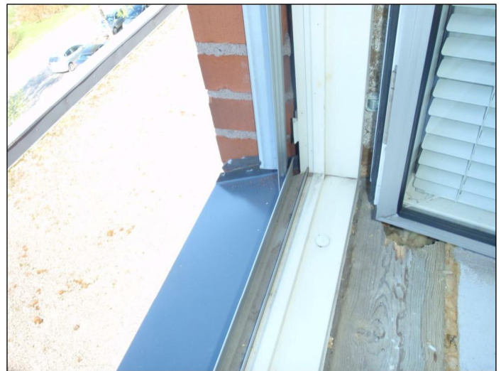
KUVA 2: Epätiivis ikkunan ulkoliittymä
