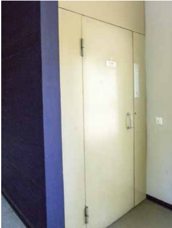
Laajennusosan pohjoispäässä sijaitsevan B-porrashuoneen alkuperäinen henkilöhissi.
