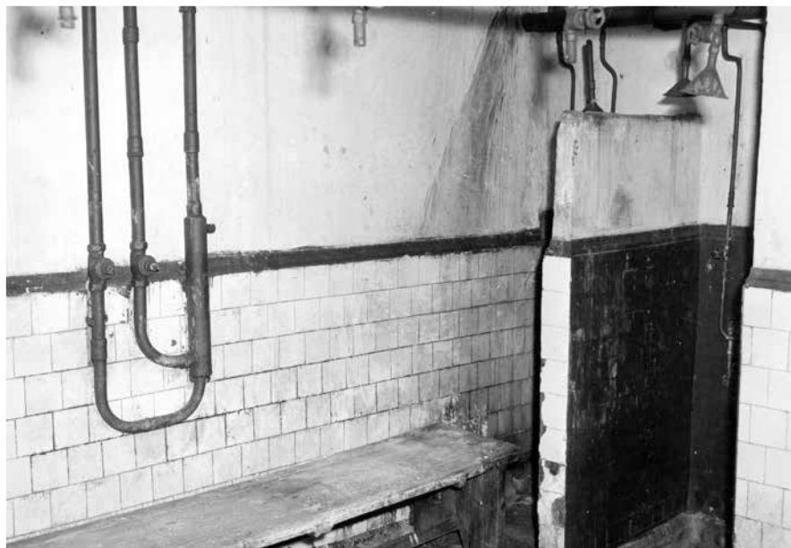
Saunan rapistunut pesuhuone kesällä 1956. SA-kuva
